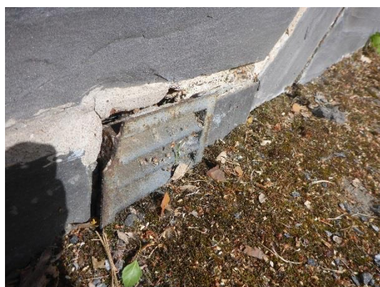
Kuva 8. Parkkipaikkojen puolella kellarin tuuletusluukku on osittain asfaltoitu umpeen.
