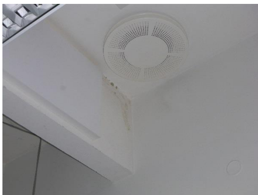
Kuva 47. Yläpohjarakenteen alapinnassa havaittiin vuotojälki tilassa 208. Kohonneita pintakosteuslukemia ei esiintynyt. Muissa tiloissa ei havaittu viitteitä kosteusvaurioista.
