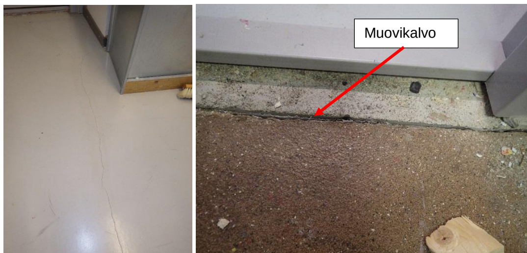
Kuvat 26 a ja b. Puukäsityöluokan lattiarakenteessa esiintyy halkeilua. Puutyöluokan pintalaatan liittymissä viereisiin rakenteisiin on havaittavissa muovikalvo. Alapohjalaatan ja viereisten rakenteiden väliin jää 5...10 mm rako. Liittymissä ei havaittiin merkittävästi tarkasteltuna heikko ilmavirtaus rakenteeseen päin. Alapohjarakenteeseen tehdystä rakenneavauksesta RAK21 mitattiin eristetilän ja sisäilman välistä paine-eroa hetkellisesti. Paine-ero oli 0...3 Pa, alapohjarakenteen ollessa alipaineinen sisäilmaan nähden.
