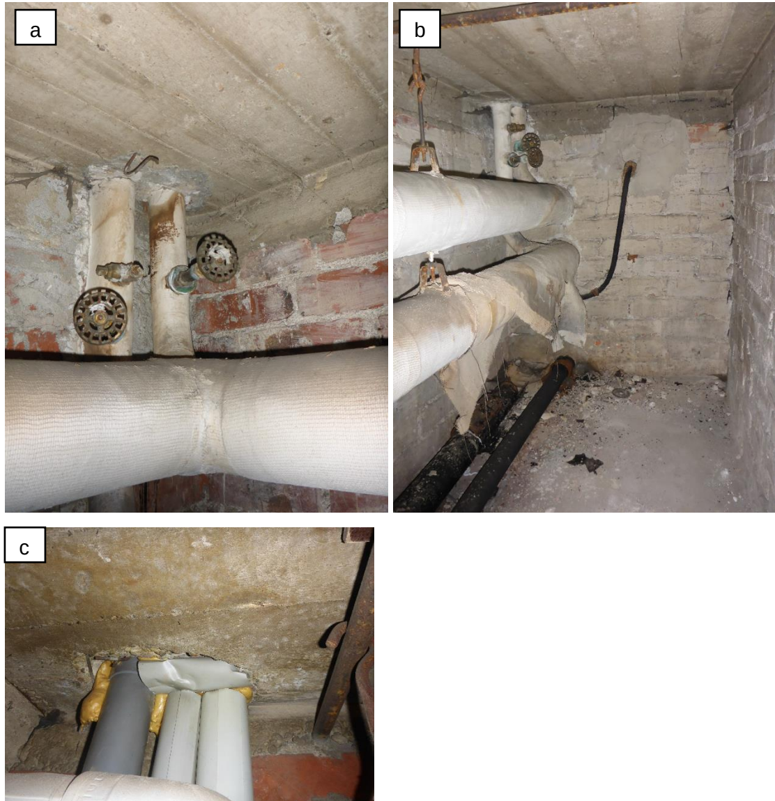
Kuvat 18 a...c. Kattilahuoneesta lähtevässä putkikanaalissa (putkikanaali 1) havaittiin epätiiviyttä läpivientejä nollakerrokseen. Putkieristeissä on paikoin havaittavissa kosteuden aiheuttamia jälkiä.
