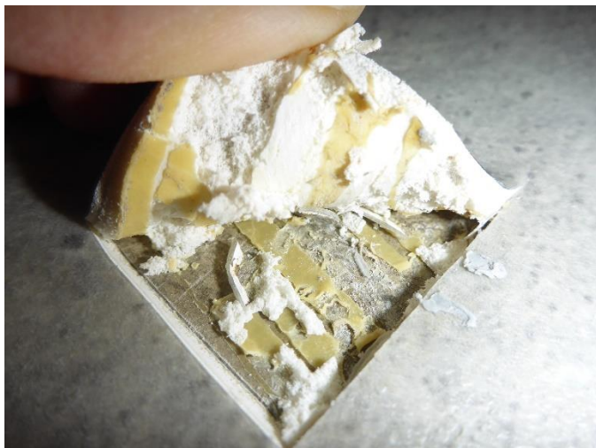
Kuva 32. V3, tila 025 Sos.tila/N. Viiltomittauksen tulos 36,5 %RH. Maton tartunta alustaansa tiukka, ei poikkeavaa hajua, murtopinta liimassa ja joustopohjakerroksessa.
