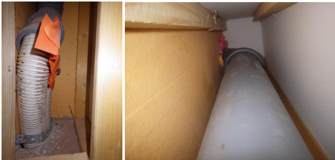
Kuva 29. Tilassa 025 havaittiin putkikotelossa alapohjarakenteessa läpivienti, joka on toteutettu salaojaputkella. Salaojaputkea on näkyvissä noin 20 cm ja se on liitetty viemäriputkeen. Viemäriputki jatkuu ulkoseinärakenteen läpi. Tilan 025 alapohjarakenne on uusittu ja korjaustöiden yhteydessä rakenteen täyttökerrokseen on ilmeisesti asennettu radonputkista rakenteen tuulettumista varten. Lattiapinnan tason yläpuolella olevasta salaojaputkesta havaittiin voimakas ilmavirtaus sisäilmaan päin. Epätavanomaista hajua ei havaittu.
