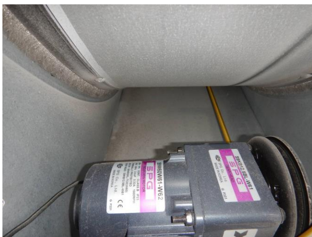
Kuva 76. Ilmanvaihtokoneen LTO- kammiossa on pölyä ja roskaa.
