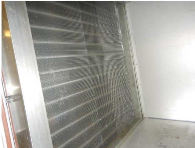
Kuva 70. Tuloilmakoneen lämpöpatterissa on hieman roskaa.
