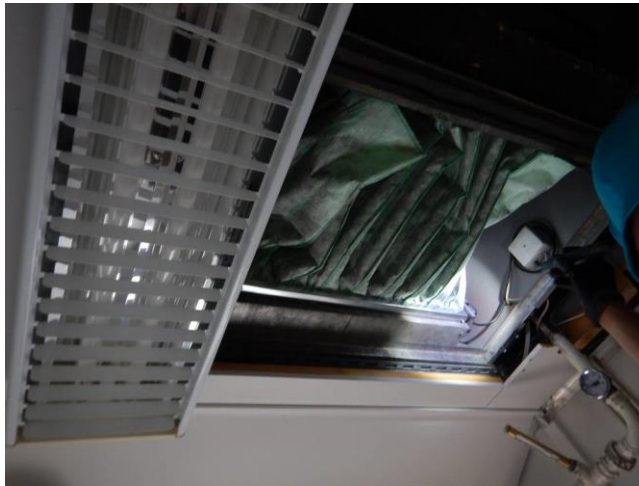
Kuva 79. Tuloilmakoneen suodattimen kiinnitys on hoidettu kahdella peltiruuvilla. Suodatinkehys ei ole tiivis ja siinä tapahtuu ohivirtausta.
