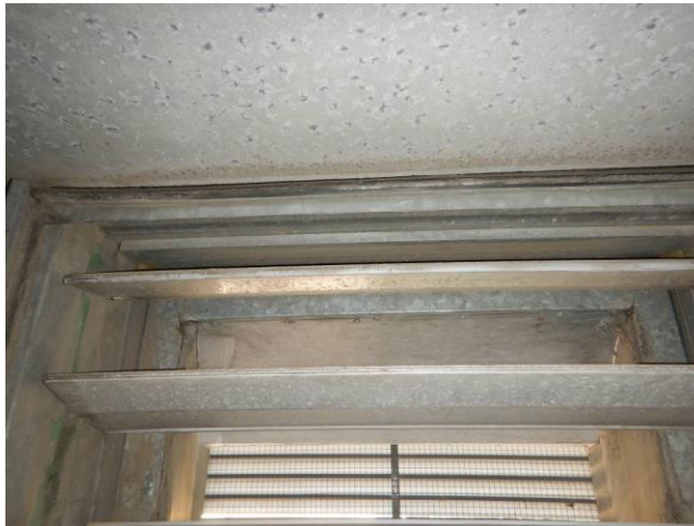
Kuva 80. Tuloilmakoneen raitisilmapellistö ei sulkeudu, kun kone pysäytetään.
