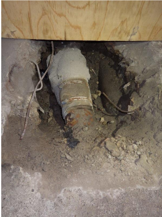
Kuva 23. Lämmönjakohuoneen alapohjarakennetta on avattu aikaisemmin pohjaviemäritukoksen vuoksi. Avaus on peitetty vanerilevyllä ja avauksen kohdalla on suora yhteys maaperään. Rakenne: noin 50 mm betoni, bitumikermi, noin 100 mm betoni, hiekka.
