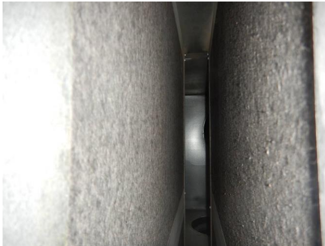
Kuva 73. Poistoilmakoneen äänenvaimentimien materiaalina on mineraalivilla, jonka päällä on ehjä kuitukangas. Äänenvaimennin on pölyinen.
