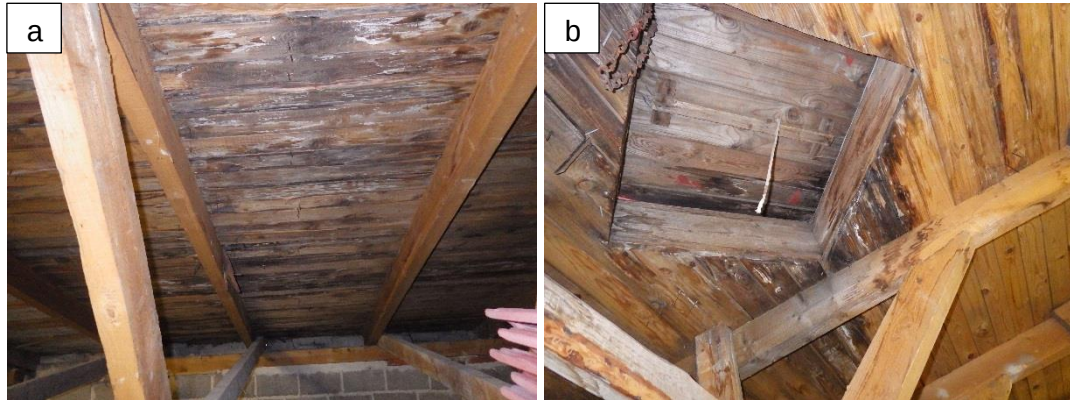
Kuva 51. Luokkasiiven aluslaudoituksessa ja kattoluukun viereisissä rakenteissa havaittiin kosteuden aiheuttamia jälkiä.
