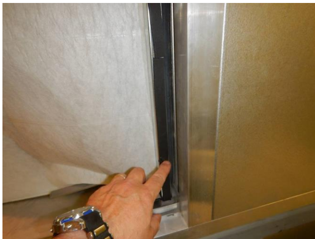
Kuva 74. Poistoilmakoneen suodattimien välissä ei voida käyttää tiivistettä, koska suodattimen ns. otsapinnan tiivistyskohta ei osu oikealle kohdalle suodatinkehityksessä.
