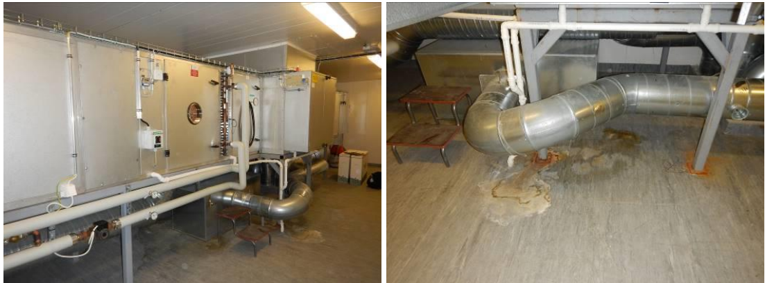
Kuva 66 a ja b. Yleiskuva IV- konehuoneesta. Konehuoneen lattialla on kosteuden aiheuttamia jälkiä.
