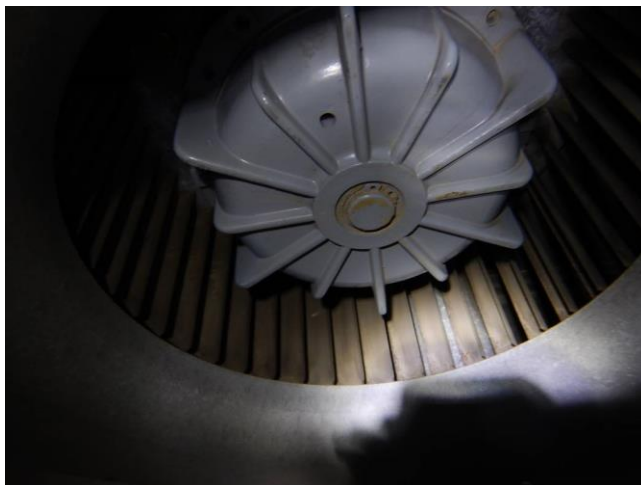
Kuva 82. Tuloilmapuhallin on pölyinen.
