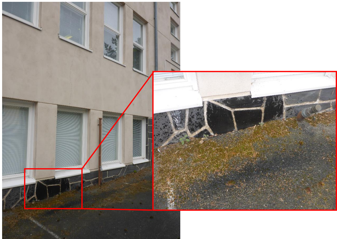
Kuva 6. Pysäköintipaikkojen puolella (tilan 002 Kirjasto ulkopuolella) sadeveden havaittiin vuotavan räystäään sadevesikourusta yli lisäten seinän alaosan kosteusrasitusta.
