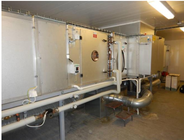
Kuva 72. Tuloilmakoneen äänenvaimenninta ei voitu tarkastaa, koska kammiossa ei ole tarkastusluukkua.
