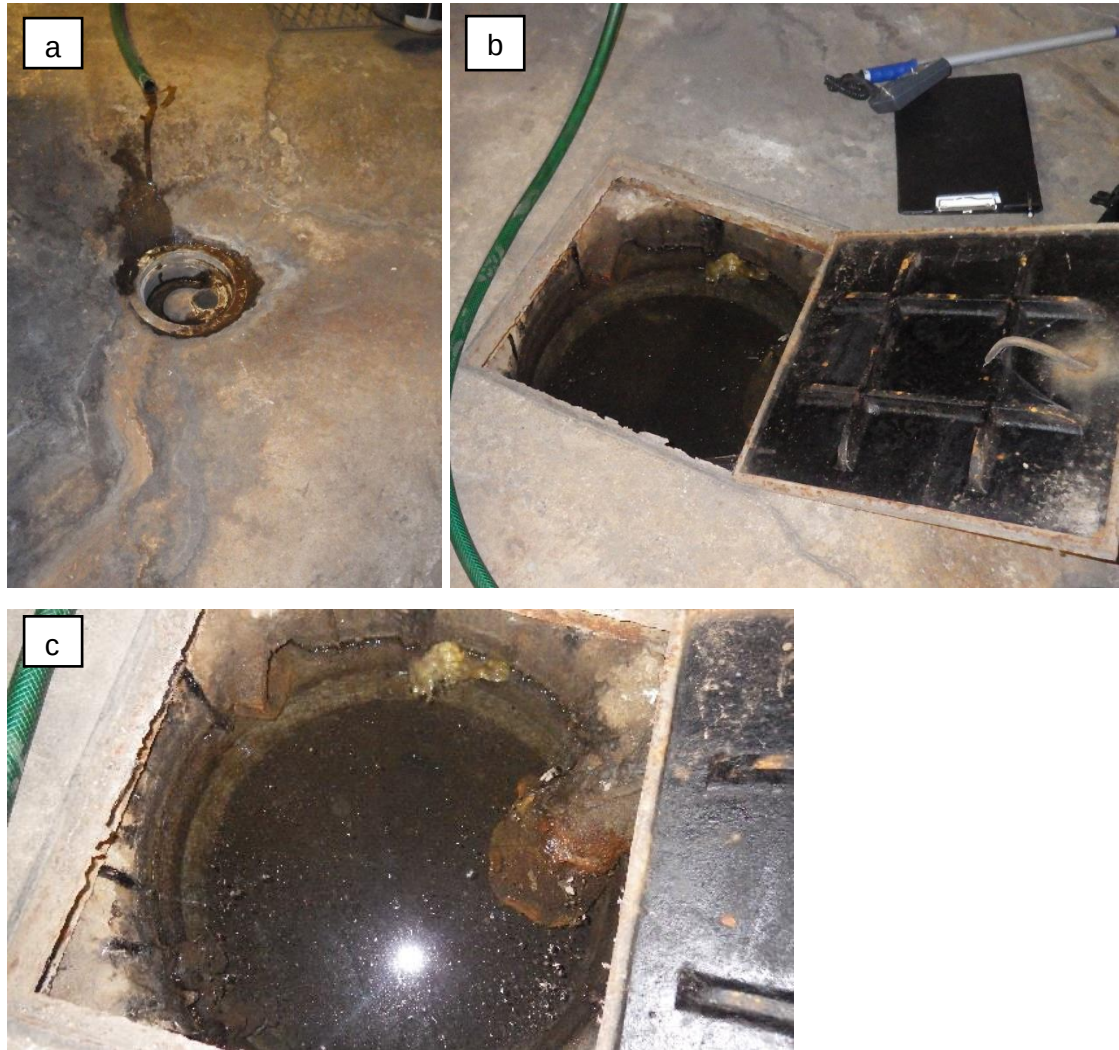
Kuvat 16 a...c. Kattilahuoneessa on lattiakaivo, mutta ei vedeneristystä. Lattiakaivon vieressä olevassa luukussa on kaivo, joka oli tutkimushetkellä täynnä vettä.
