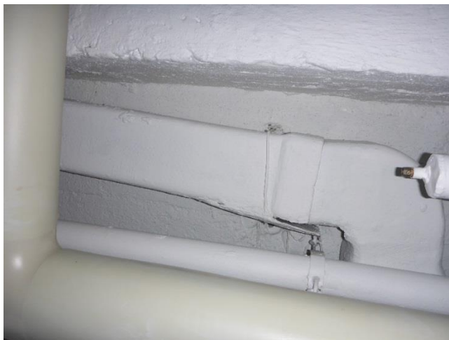
Kuva 93. Kuitusementtilevystä tehty ilmanvaihtokanava lämmönjakohuoneen vieressä varastotilassa.
