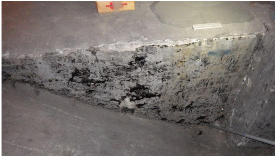
Kuva 15. Polttoainevarastoon vievän luiskan vierellä havaittiin kohonneita pintakosteuslukemia. Tiilimuurin bitumisively on ikääntynyt.
