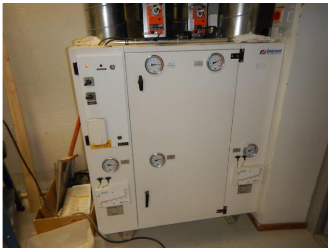
Kuva 86. Tulo- ja poistoilmakoneessa ei ole tyyppikilpeä.
