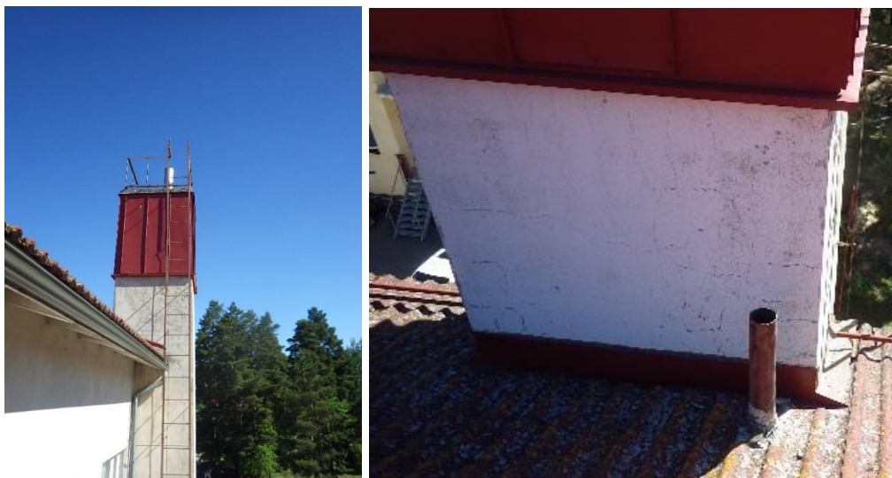
Kuva 65. Piipussa on runsaasti halkeamia. Piipun yläosaan on asennettu suojaPELLITYS ilmeisesti piipun vaurioitumisen vuoksi.
