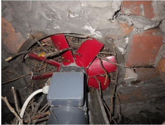
Kuva 56. Horneissa on käytöstä poistettuja alipainetuulettimia. Alipainetuulettimet ovat otettu ilmeisesti pois käytöstä iv-saneerauksen yhteydessä.
