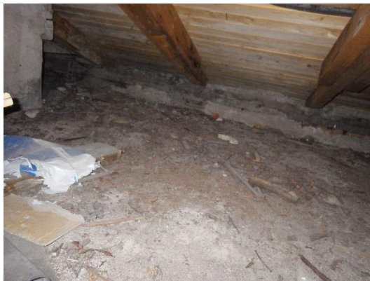
Kuva 50. Yläpohjassa on orgaanista jätettä.
