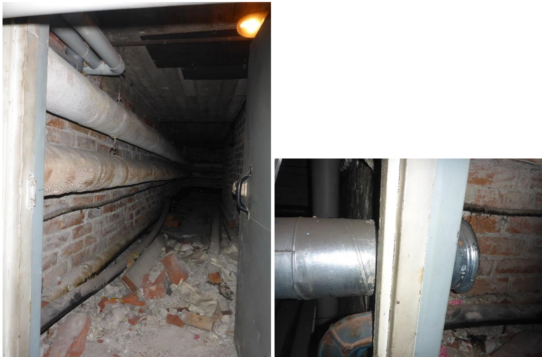
Kuva 20. Putkikanaaliin 1 on asennettu koneellinen alipaineistusjärjestelmä. Alipaineistusjärjestelmän poistoilmaventtiilistä havaittiin aistinvaraisesti voimakas ilmavirtaus kanavaan päin. Poistoilmakanava on asennettu putkikanaalin kulkuluukun viereen. Kulkuluukku ei ole tiivistetty ja luukku oli jätetty auki.
