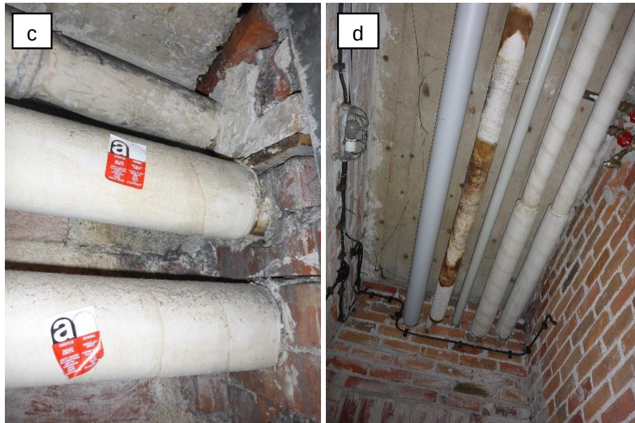
Kuvat 14a...d. Koulun ja päiväkodin välillä on putkikanaali. Putkieristeet sisältävät asbestia ja niissä todettiin kosteuden aiheuttamia jälkiä. Putkikanaalia ei ole koneellisesti alipaineistettu.
