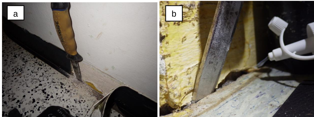
Kuvat 25a...b. Alapohjalaatan ja ulkoseinän liittymässä havaittiin yleisesti rakoilua. Merkkisavulla tarkasteltaessa ilmavirtaus oli rakenteeseen päin.
