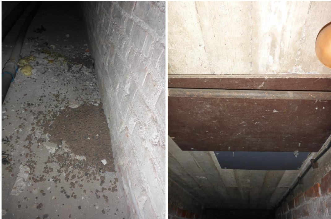
Kuva 19. Putkikanaalin 1 katossa/välipohjarakenteessa on vanerilla peitetty avaus/läpivienti ja kanaalin pohjalla kevytsoraa. Avaus on ilmeisesti tehty ylempien tilojen putkistosaneerauksen yhteydessä.
