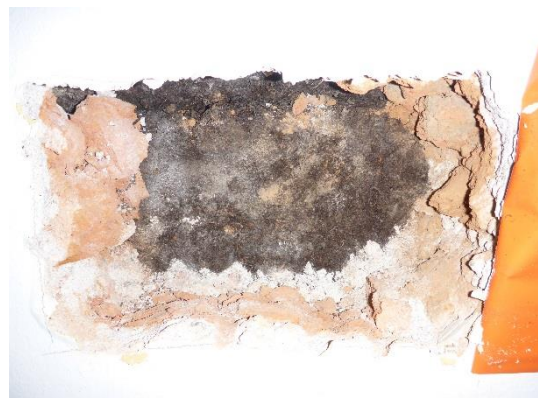
Kuva 10. Rakenneavaus RAK 28. Turve-eristeestä otettiin materiaalinäyte MAT 10. Näytteessä ei todettu mikrobikasvua.
