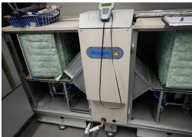
Kuva 85. Ilmanvaihtokone on kokonaisuutena hyvässä kunnossa.
