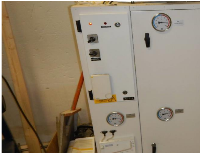
Kuva 87. Ilmanvaihtokoneen ohjauskytkimet ja sisäilmapuhalluksen lämpötilan säätö.
