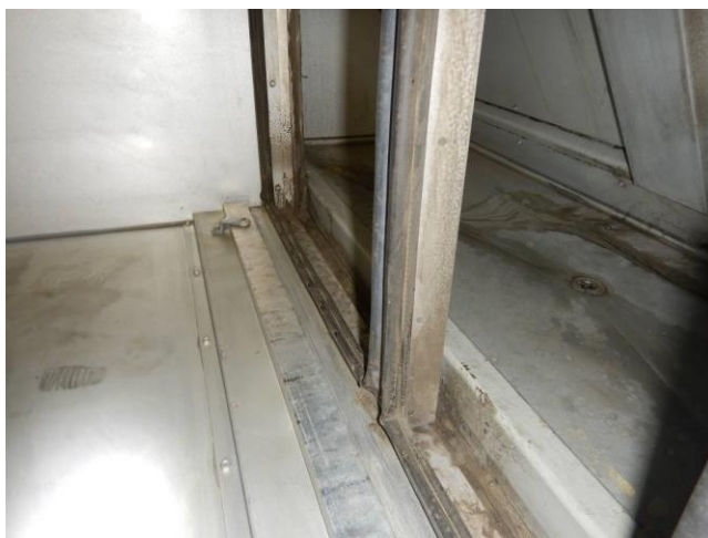
Kuva 68. Tuloilmakoneen suodattimien välissä ei voida käyttää tiivistettä, koska suodattimien ns. otsapinnan tiivistyskohta ei osu oikealle kohdalle suodatinkehyksessä.
