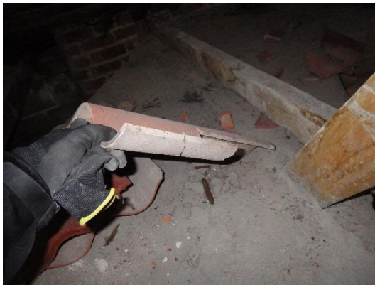
Kuva 57. Luukkasiiven yläpohjassa on vanhoja vesikattotiiliä. Aikaisempi vesikate on ilmeisesti ollut kuitusementtitiilikatteinen (Vartti-kate), joka sisältää mahdollisesti asbestia.
