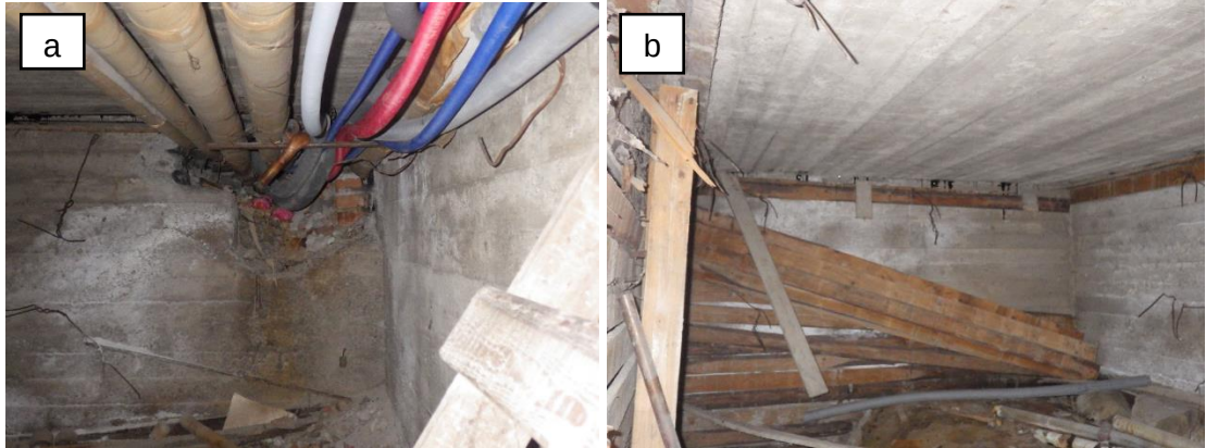
Kuvat 21 a...b. Kellarin varastosta liikuntasalin siipeen lähtevässä putkikanaalissa/ryömintätilassa (putkikanaali 3) havaittiin osittain irronneita muottilautoja ja muuta rakennusmateriaalia. Tilassa aistittiin mikrobiperäistä hajua. Putkikanaali on alipaineistettu koneellisesti. Alipaineistusjärjestelmä sijaitsee ryömintätilan yläpuolella olevassa varastossa.
