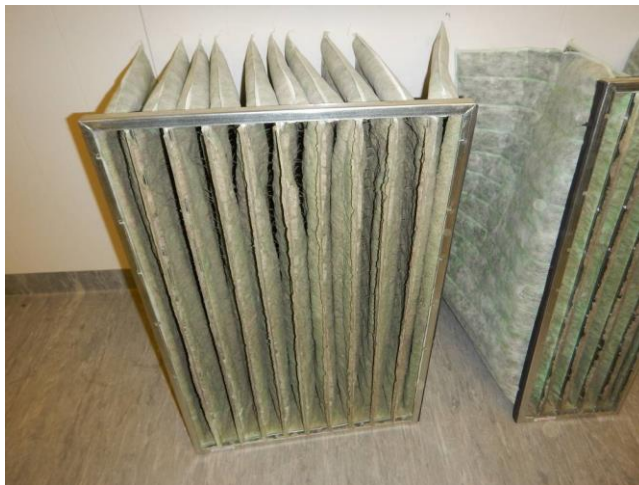
Kuva 67. Tuloilmakoneen suodattimet ovat likaiset. Suodattimien suodatusluokka F7, mutta niiden vaihtoväli ei ole selvillä.
