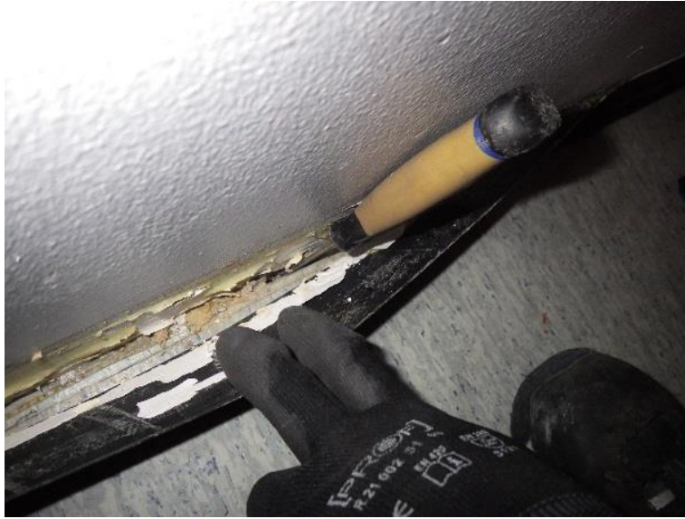
Kuva 38. Välipohjarakenteen ja seinien liittymissä todettiin rakoilua. Merkkisavulla tarkastellessa ilmavirtaus oli pääosin rakenteeseen päin.
