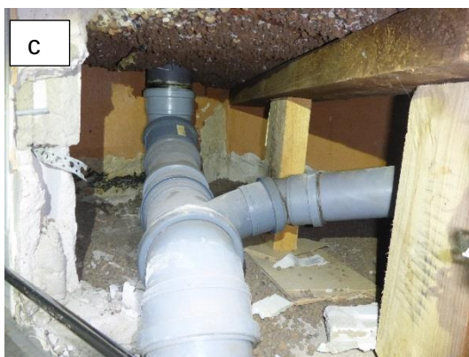
Kuvat 28a...c. Wc-tiloissa, joihin on kulku ulkokautta, on seinärakenteissa tarkastusluukkuja. Luukuista on yhteys 0. kerroksessa sijaitseviin wc-tiloihin. 0. kerroksen wc-tilojen alapohjarakenteet on tuettu alemmalla lattiapinnan tasolta puurakenteilla. Kos-teusvaurioita tai epätavanomaista hajua ei havaittu. Sekä tyttöjen että poikien wc-tiloihin on tehty tilamuutoksia siten, että yhteen wc-koppiin on kulku sisäkautta. Tilamuu-tosten takia näiden wc-tilojen lattia on korotettu puurakenteilla samaan tasoon kuin muu 0. kerroksen lattia.
