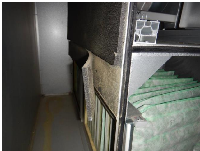
Kuva 75. Tuloilmakoneen raitisilmakammion äänieristysmatto on osittain irti.
