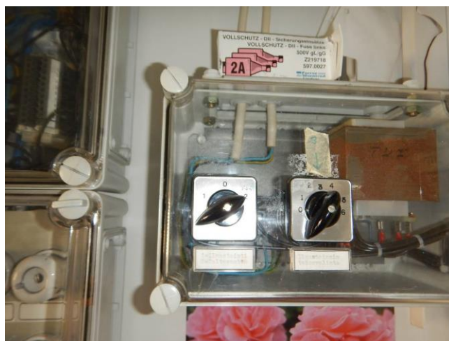
Kuva 77. Ilmanvaihtokoneen ohjauskytkin ja tehonsäätö ovat samassa tilassa koneen alapuolella.
