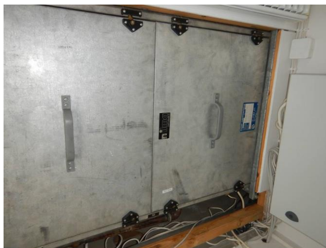
Kuva 78. Tuloilmakoneen avattavat luukut ovat hankalat irrottaa, eivätkä ne ole tiiviitä.
