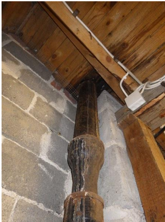
Kuva 52. Viemärin tuuletusputken läpiviennin kohdalla on vanhoja vuotojälkiä.
