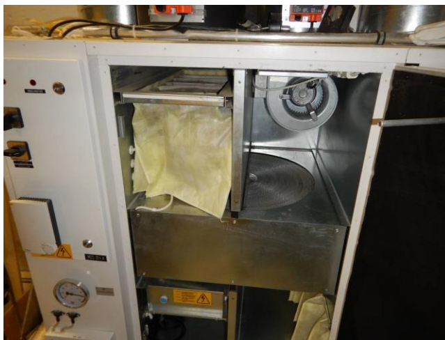
Kuva 88. Ilmanvaihtokoneen suodatusluokka on M5, mutta suodattimien vaihtoväli ei ole selvillä. Tuloilmasuodatin on hieman liian pitkä, koska suodatin on kiinni LTO-kiekkossa, joka voi rikkoa suodattimen.
