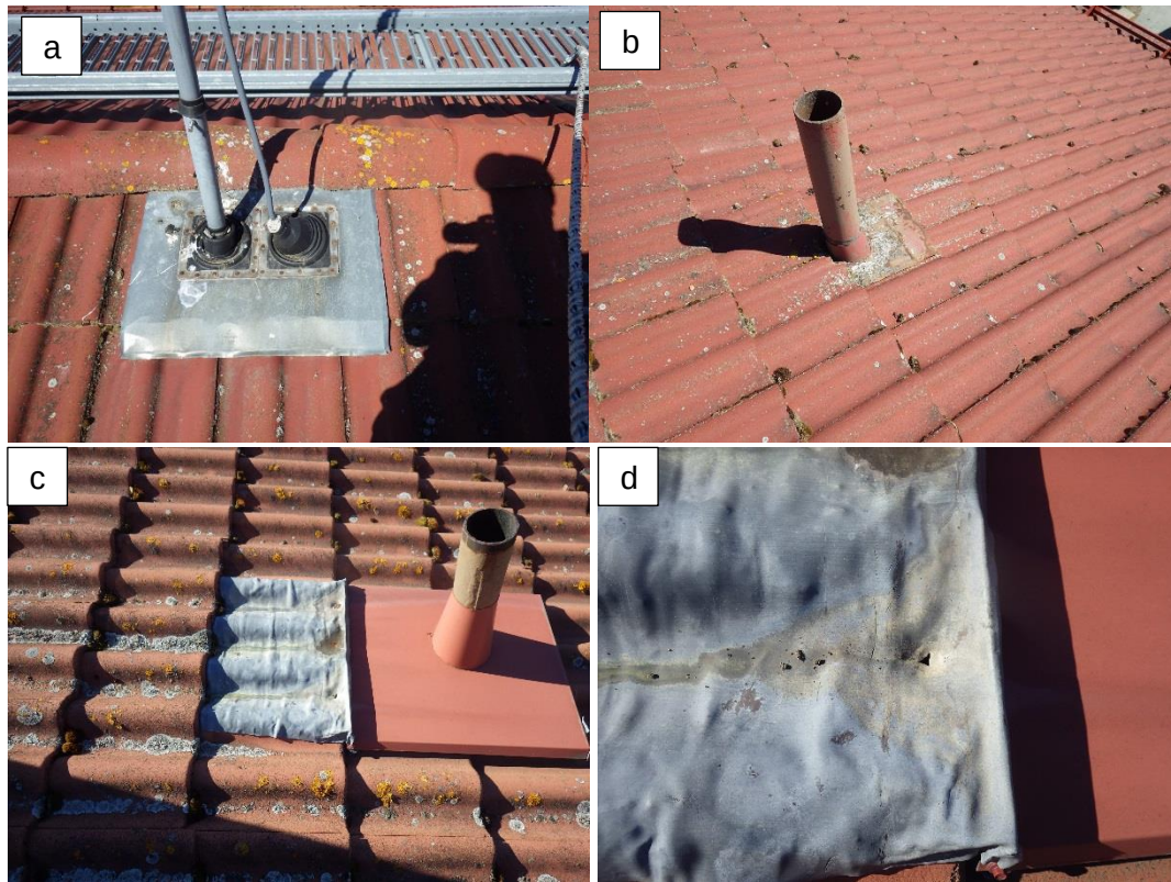
Kuva 60. Vesikaton läpiviennissä todettiin puutteita useammassa kohdassa. Antennin läpiviennin kohdalla on pellitys, johon kumitiivisteet on asennettu vetoniiteillä (kuva a), viemärin tuuletusputken läpiviennissä on teräskorroosiota (kuva b), viemärin tuuletusputken läpiviennin yläpuolelle on muotoiltava lyijylevy, jossa on reikiä (kuva d).
