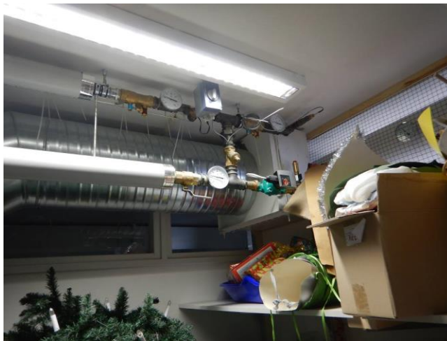
Kuva 84. Ilmanvaihtokoneen jälkilämmityspatteri ilmanvaihtokanavassa. Patteria ei voida tarkastaa / puhdistaa, koska kanavassa ei ole puhdistusluukkua.
