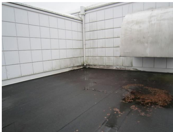
Kuva 16. Ylemmältä katolta alemmalle lappeelle ohjattava vesi on huono ratkaisu. Vesi lammikoituu helposti ja katolle muodostuu kohtia, joissa jäätyvä vesi särkee katteen.
