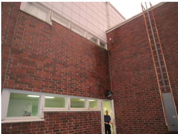
Kuva 9. Kastunutta ulkoseinää mittapisteen 1 (MP1) kohdalla.
