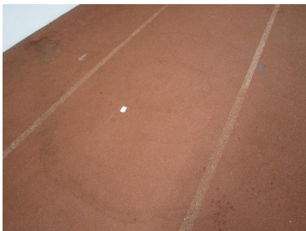
Kuva 1. Juoksuradalla on lammikoitumisesta aiheutuneita jälkiä.
