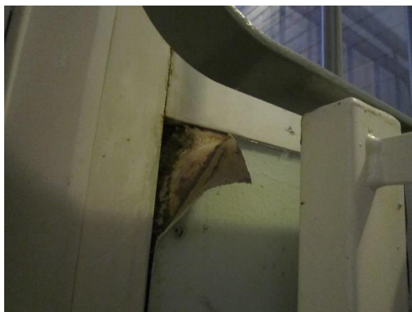
Kuva 2. Porrashuoneen sisäverhouslevyt ovat kosteus- ja mikrobivaurioituneita.
