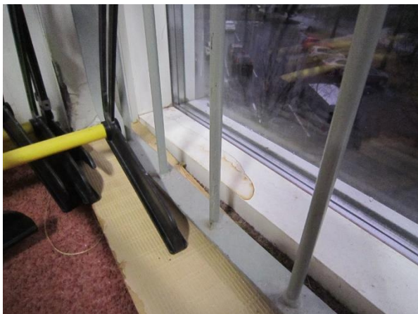
Kuva 3. Sisäpuolisella ikkunapenkillä lammikoitumisesta johtuneita jälkiä.
