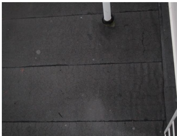
Kuva 14. Kermissä on paljon halkeilua ja se on poimuttunut paikoitellen voimakkaasti. Tämä mahdollistaa vesivuodot.
