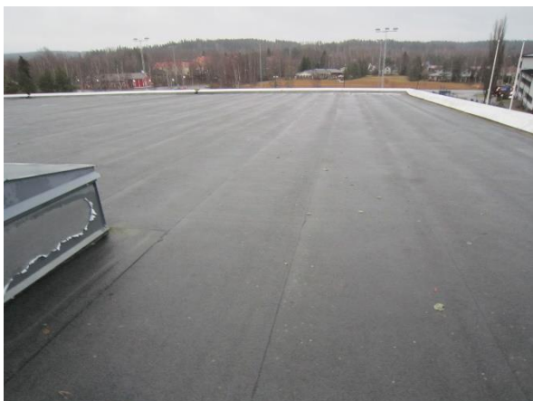
Kuva 13. Vesikaton kaadot ovat erittäin vähäiset.
