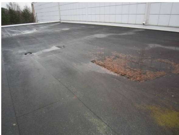
Kuva 15. Vesikaton kaadot ovat paikoitellen väärin. Vesi lammikoituu katolle.
