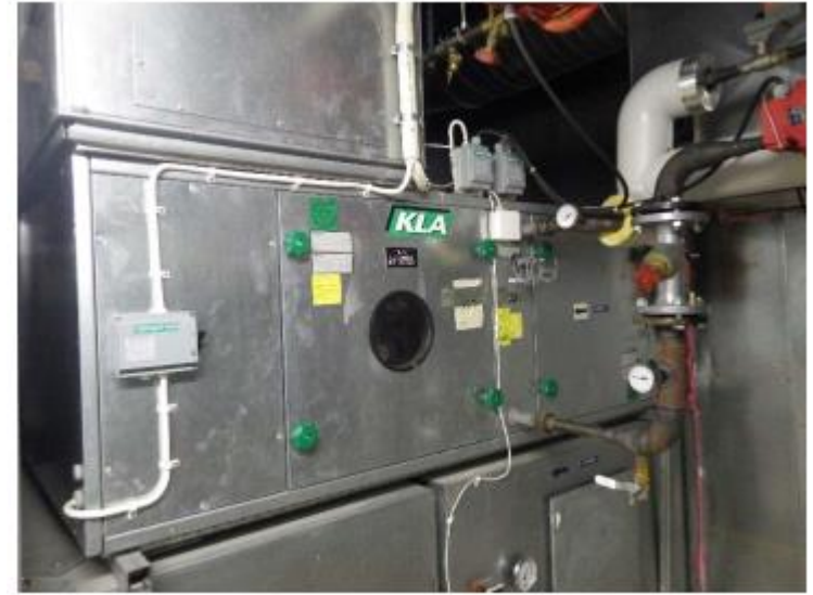
Kuva 61. Yleiskuva keittiön tuloilmakoneesta TK12,
