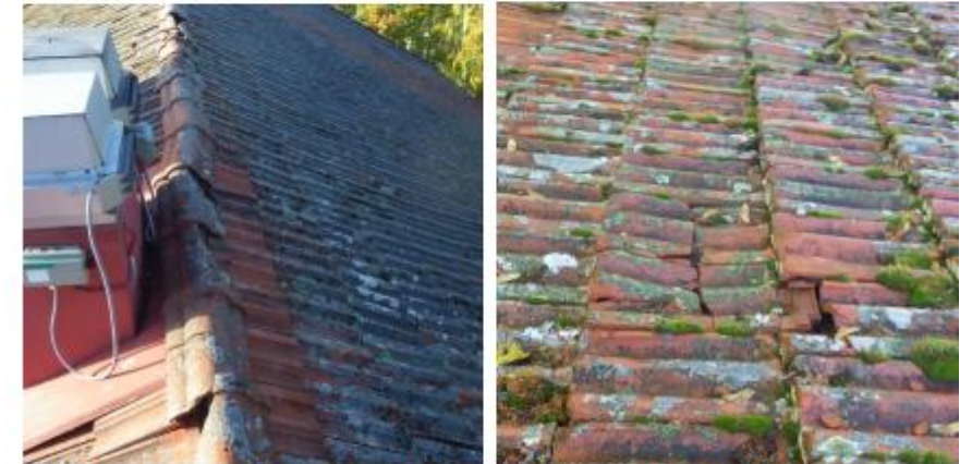
Kuvat 20a ja b. Kattotiiliä on monin paikoin särkynyt, erityisesti alueilta, joita on käytetty kulkemiseen. Vesikatolle ei ole kulkusiltoja, lapetikkaita lukuun ottamatta.
