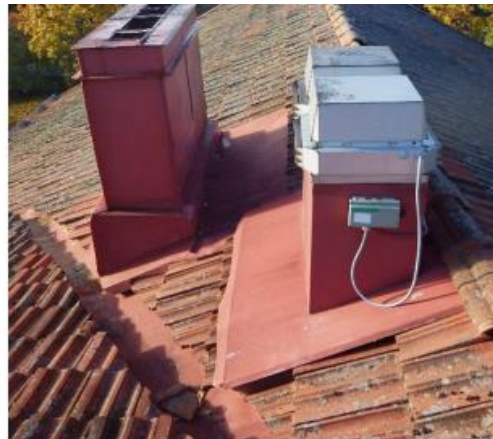
Kuva 40. Erillispoisto PK46 vesikatolla.
