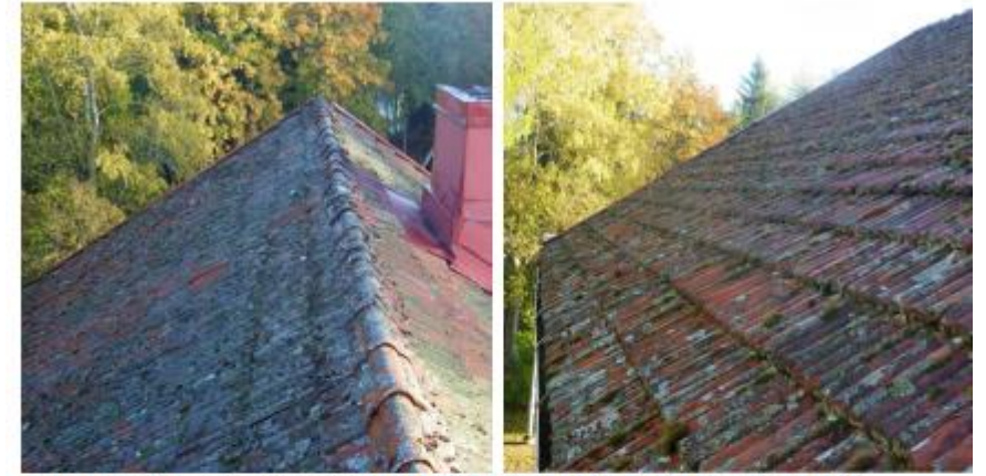
Kuvat 19a ja b. Vesikate on voimakkaasti sammaloitunut (molemmat kuvat).
