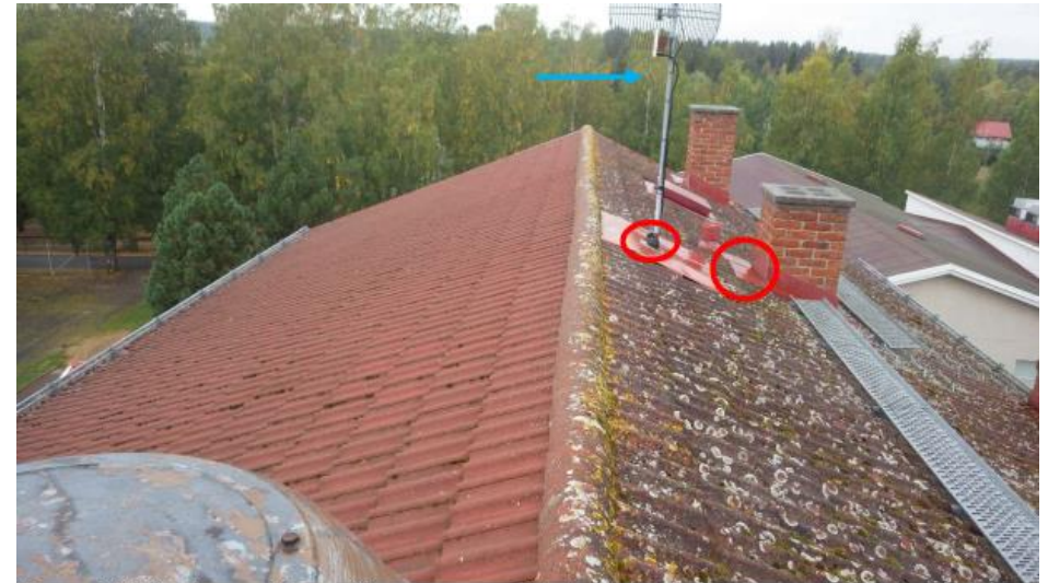
Kuva 41. Yleiskuva alkuperäisen osan vesikatolta. Kate on sammaloitunut pohjoispuk- len lappeelta. Tiilikatteessa havaittiin yksittäisiä rikkonaisia tiiliä. Sininen nuoli osoittaa pohjoisen ilmansuunnan. Kuvaan on merkitty punaisella ympyrällä vesikatteessa ha- vaittuja aktiivisia vuotokohtia. Kolmas havaittu vuotokohta on toisessa antenniläpivier- nissä kuvanottokohdalla eikä siten näy yleiskuvassa. Vuotokohdat on kuvattu yläpol- jatilasta käsin seuraavissa kuvissa.
