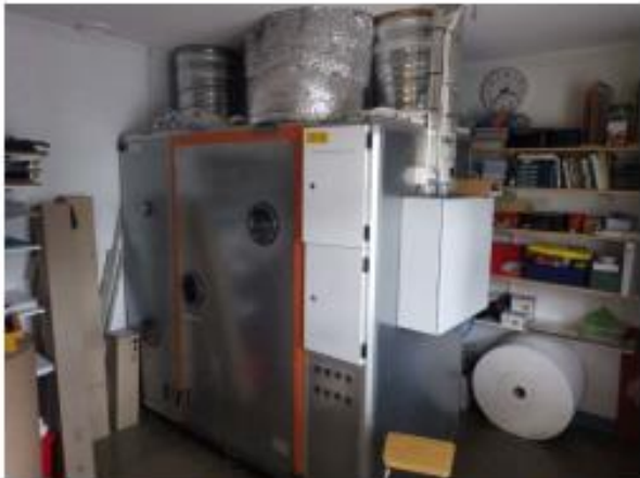
Kuva 29. Yleiskuva ilmanvaihtokoneesta TK1. Lu
