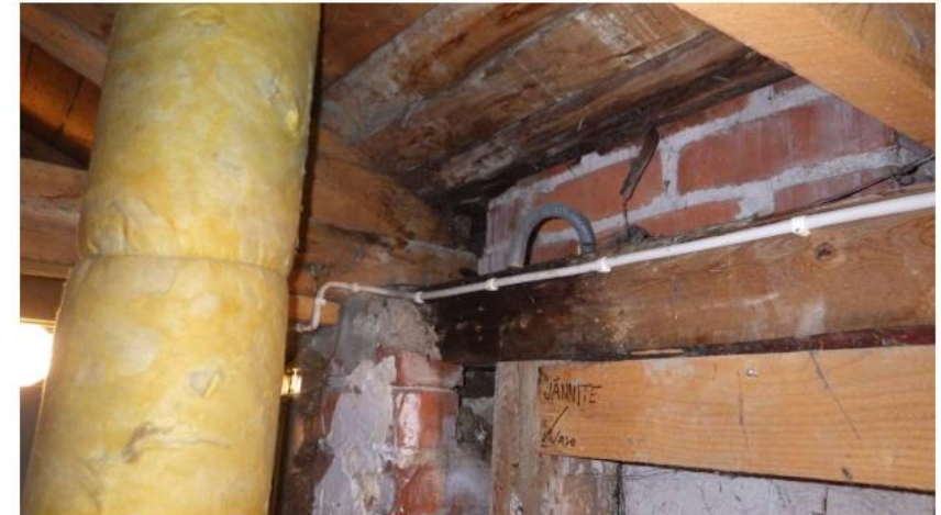
Kuva 42. Alkuperäisen osan ullakolla havaittiin aktiivinen vesivuoto tiilihormin läpivien- nin yläosasta. Läpiviennin kohdalla aluskatteen ja juuripellin vesitiiveydessä havaittiin puutteita.
