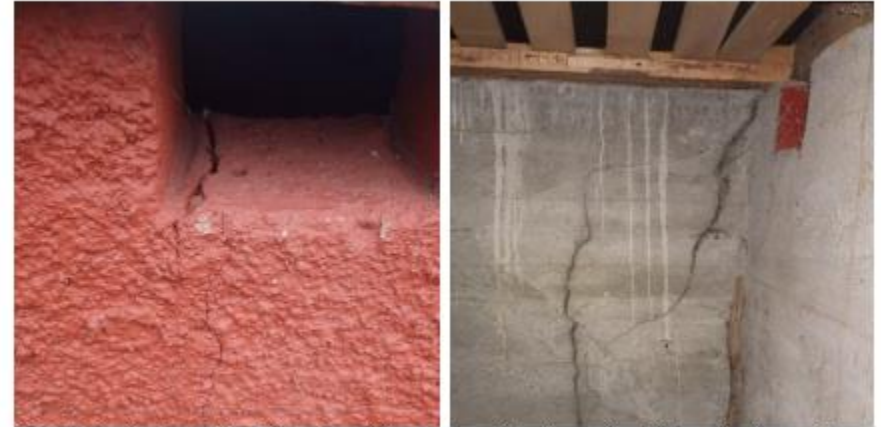
Kuvat 16a ja b. Sokkeleissa havaittiin runsaasti halkeamia. Pääosa halkeamista on tuuletusaukkojen kohdalla (a), mutta yksittäisiä halkeamia havaittiin myös muualla (b).
