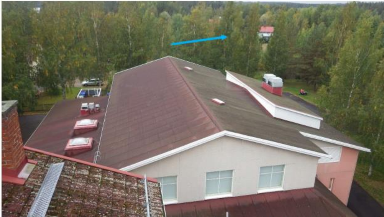
Kuva 39. Liikunta-/ruokalasiiven pohjoisenpuoleinen vesikatto on hieman sammaloitunut. Sininen nuoli osoittaa pohjoisen ilmansuunnan.
