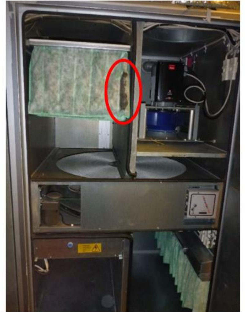
Kuva 30. TK1 sisältä. Tuloilmasuodatin on revennyt
