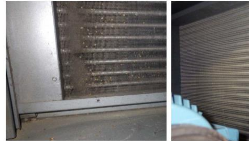
Kuva 64 a ja b. LTO-patteri on erittäin likainen.
