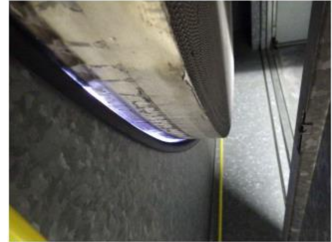
Kuva 57. LTO-kiekon harjatiiviste on kulunut ja epätiivis.
