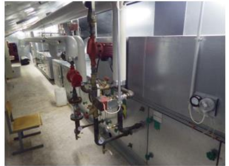
Kuva 66. Yleiskuva tulo- ja poistoilmakoneesta TK21.
