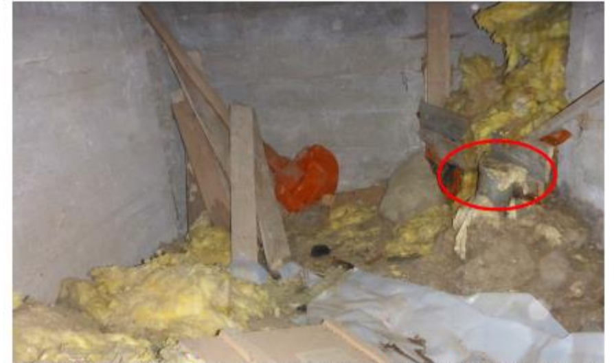
Kuva 10. Kellarin vierustalla on runsaasti rakennusjätettä ja vanha viemärin pää sekä viemäriperäistä jätettä (punainen ympyrä).
