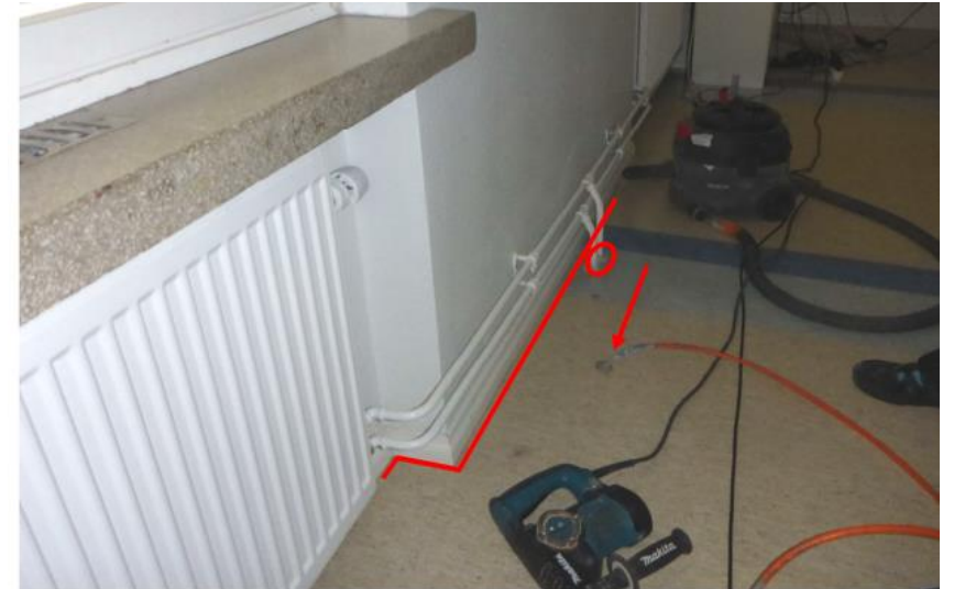
Kuva 31. Yleiskuva merkkiainekokeen MA-K7 toteutuksesta. Kaasun syöttöreian kohta on merkitty kuvaan vihreällä nuolella. Merkkiainekokeessa havaittiin kohtalaista ilma- vuotoa patteriputkien läpivientien kautta sekä välipohjan ja ulkoseinän liittymästä. Vuotokohdat on merkitty kuvaan punaisella.
