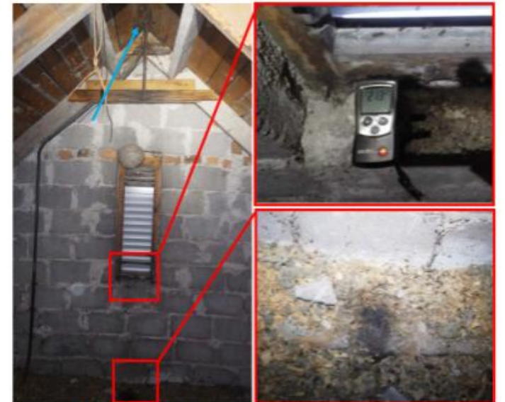
Kuvat 40 a, b ja c. Valokuva vuotokohdasta (sininen nuoli) vuotokohdalla tuuletusluukun puuosien kosteusprosentti on korkea (yläkuva) ja eristeessä havaittiin tummunut alue. Vuotokohdalle tehdyssä avauksessa ei havaittu vaurioita puurakenteissa (kts. seuraava kuva).
