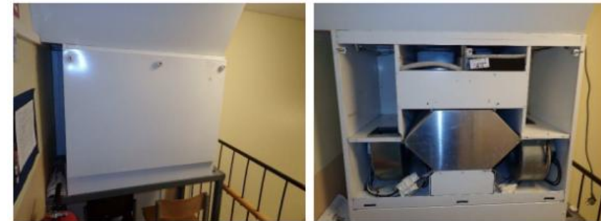
Kuva 50 a ja b. 2. kerrosta palveleva ilmanvaihtokone Iloxair 199.
