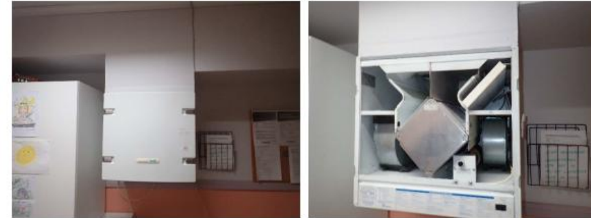
Kuva 43 a ja b. Yleiskuva työtilaan 106 sijoitetusta iv-koneesta Vallox Digit SE. Koneessa ei ole paikallaan siihen kuuluvia karkeasuodattimia.
