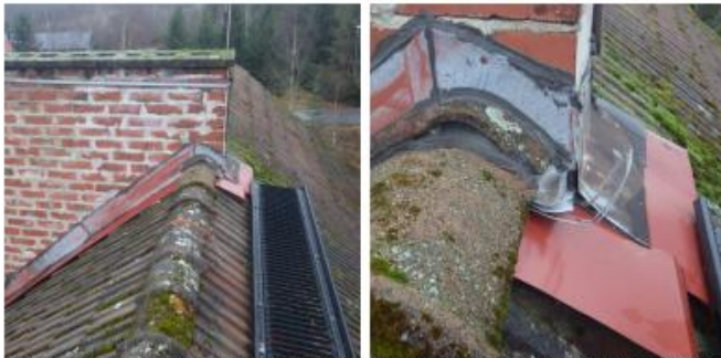
Kuvat 35 a ja b. Kattoturvatuotteet on osin uusittu. Vesikatteen läpivientien pellityksiä on korjailtu jälkikäteen. Pellitysten toteutus on vaihtelevaa (oikea kuva).
