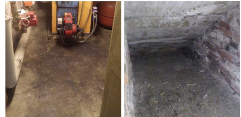
Kuvat 10a ja b. Lämmönjakuhuoneen lattiassa on runsaasti näkyvää öljyistä likaa (vasen kuva). Lämmönjakuhuoneessa havaittiin öljyn hajua. Portaiden alustilassa lattialla betonin pinnalla on hiekkaa /multaa ja muuta roskaa (oikea kuva). Alustilassa ei havaittu merkittävää poikkeavaa hajua.
