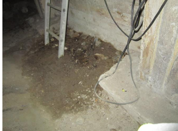
Kuva 5. Kuva. Ilmankuivaimen poistoilman ulosjohtaminen on puutteellista. Kuivain tiputtaa osan vedestä takaisin alapohjaan.
