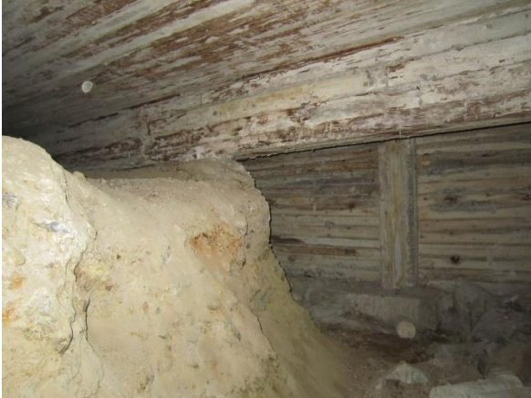
Kuva 4. Ryömintätilaan jäänyt muottilaudoitusta.
