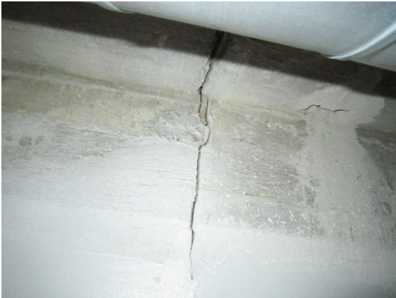
Kuva 6. Liikuntasaumat ovat avoimia kaikkialla rakennuksessa. Näkyvillä osilla saumojen päällä on peitelista.
