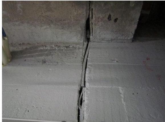
Kuva 7. Liikuntasauoissa käytettyä eristelevyä ei ole poistettu.
