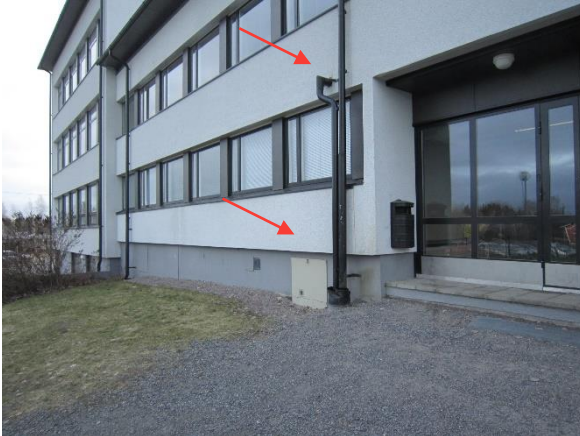
Kuva 2. Seinän rappauspinoite kastuu ajoittain ryömintätilojen kuivatuksen johdosta.
