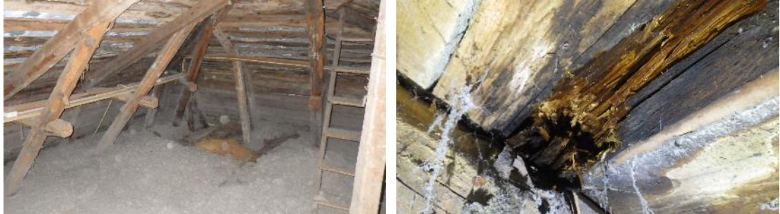
Kuva 63 a ja b. Kattotikkaiden kohdalla on yksittäinen merkittävä aktiivinen vesivuoto. Vesivuodon kohdalla aluslaudoituksessa ja runkorakenteissa on paikallisesti lahoa.
