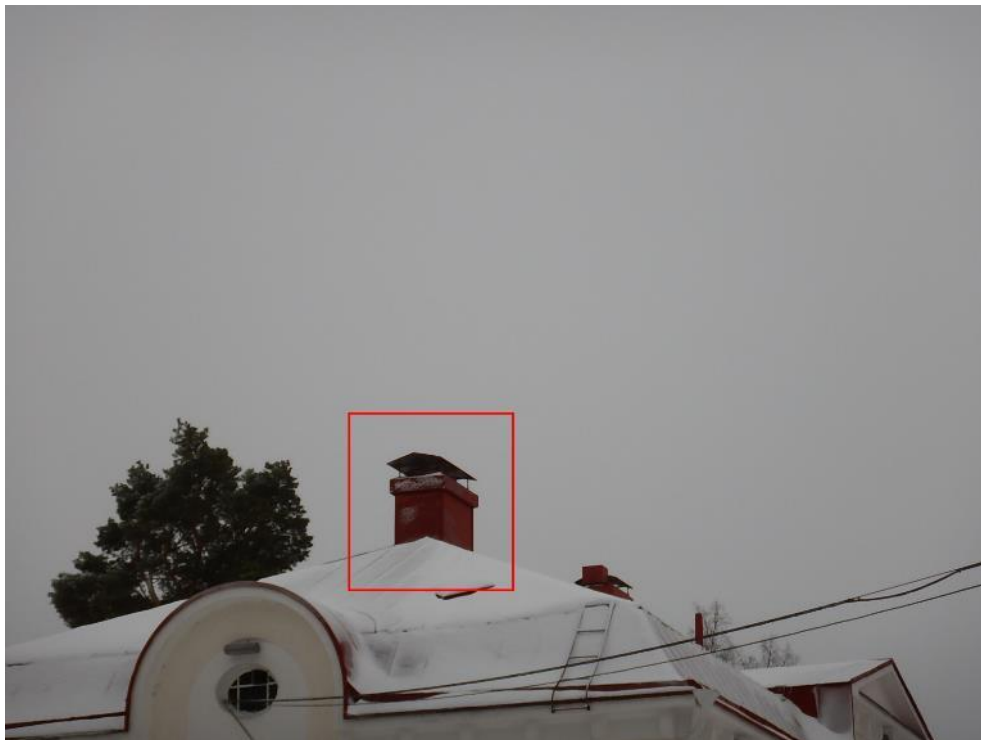
Kuva 73. Raitisilma otetaan ilmanvaihtokoneelle punaisella ympyröidyn piipun kautta.
