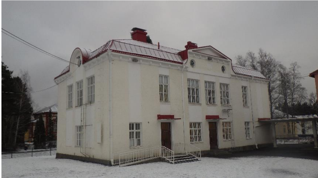
Kuva 32. Yleiskuva rakennuksen julkisivusta. Julkisivu on rapattu. Ikkunoiden kohdalla rappauspinta on paikoin sileä. Maanpinnan tasolta pistokoeluontoisesti tarkasteltuna havaittiin, että rappaus on paikoin irti alustastaan. Alustastaan irti olevat alueet ovat yksittäisissä kohdissa suurehkoja (yli 1 m 2 ).
