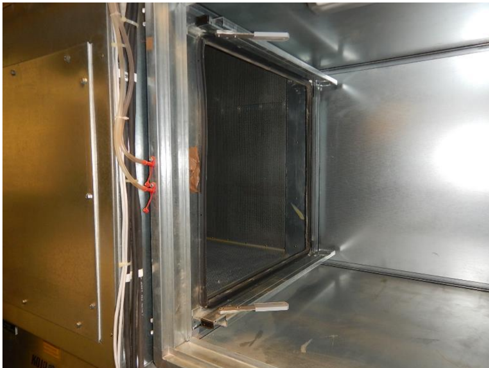
Kuva 85. Poistoilmasuodattimen kehikon tiivisteet ja lukitukset ovat hyvässä kunnossa. Kammio on pölyinen.
