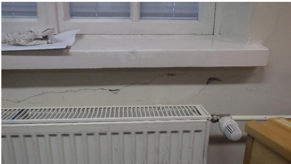
Kuva 27. Ulkoseinän sisäpinnassa halkeilua luokkatilassa 202.
