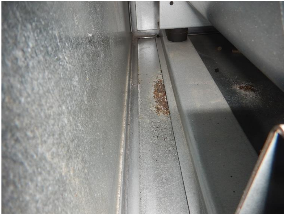
Kuva 82. Tuloilmapuhaltimen kammiassa on irtoroskia.
