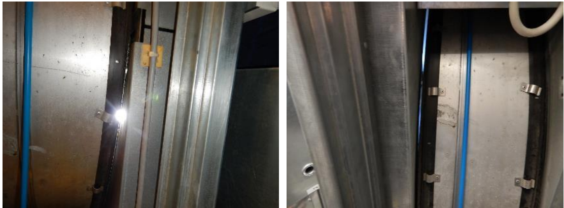
Kuva 76a ja b. Lto-kiekon harjatiivisteet ovat kuluneet lähes olemattomiksi. Kiekon ohi pääsee syntymään ohivirtausta. Lto-kiekkoa pyörittävä vetohihna on melko löysä.
