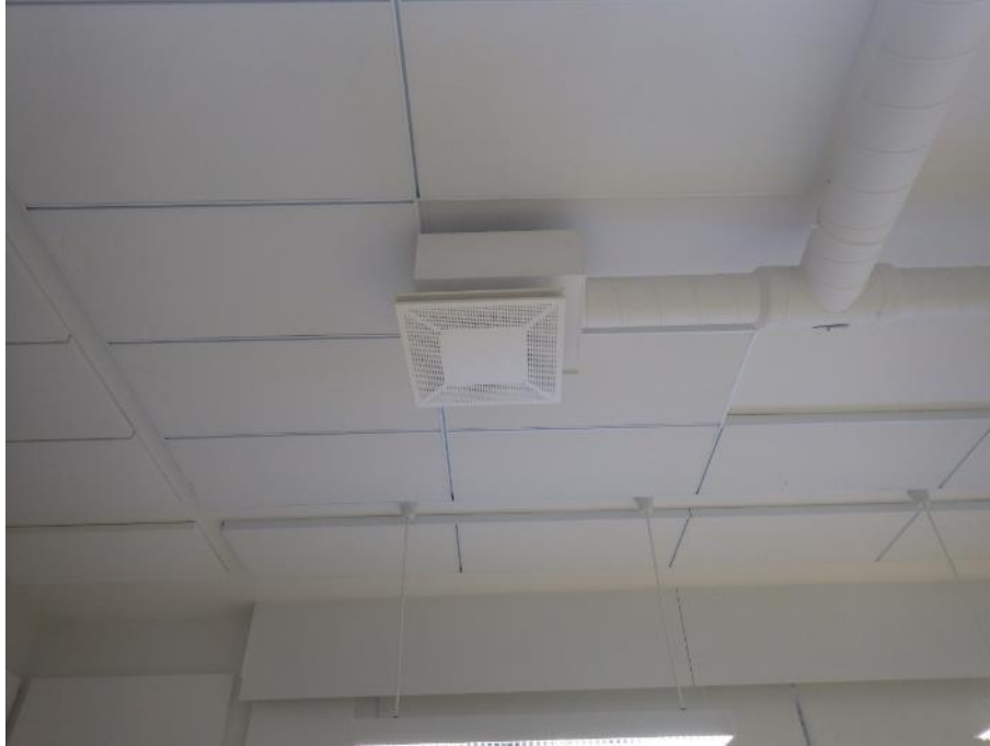
Kuva 93. Tuloilma tuodaan tiloihin kattohajottajien kautta.
