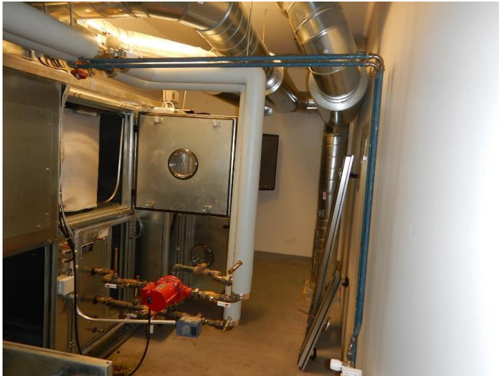
Kuva 70. Ilmanvaihtokoneen kaikki huoltoluukut avattiin tarkastusta varten.
