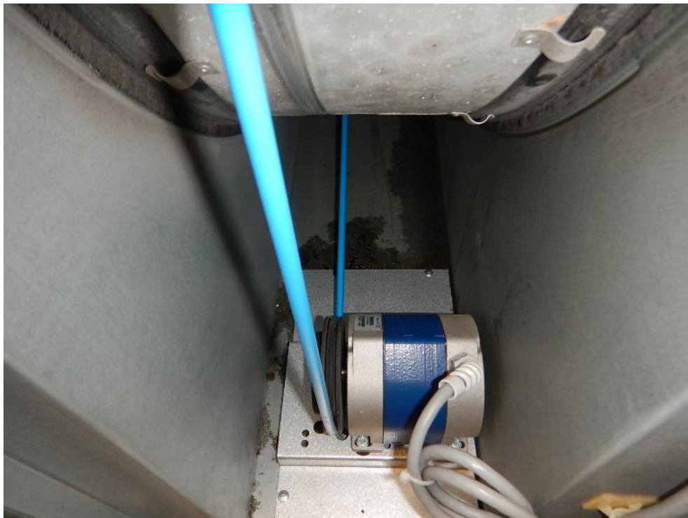
Kuva 77. LTO-kammion pohjalla on öljyä.
