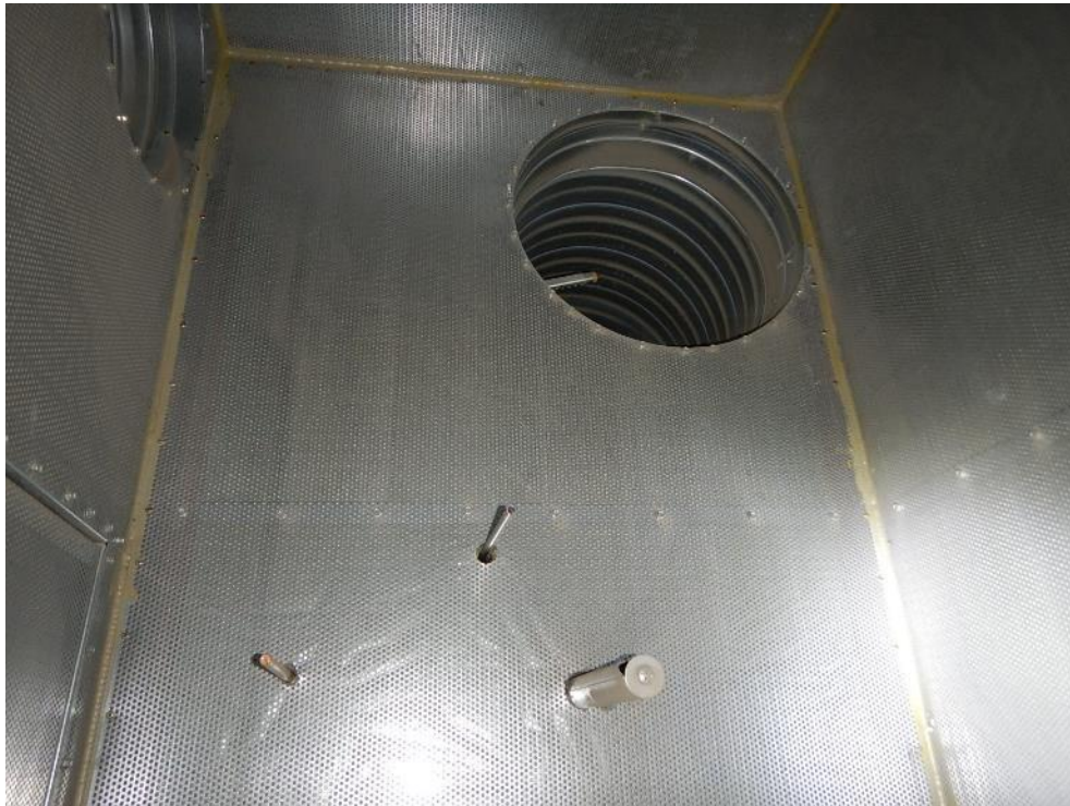
Kuva 84. Poistoilmakammio on siisti, mutta hieman pölyinen. Lämpivientejä ei ole tiivistetty.
