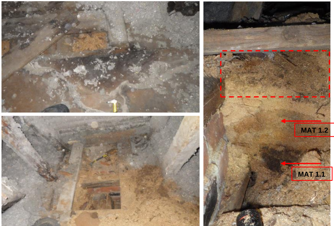
Kuva 64 a, b ja c. Vesivuotokohdalla kovalevy ja sen alla oleva laudoitus ovat paikoin märkiä ja tummuneita. Vesivuodon kohdalta poistettiin puhallusvilla, kovalevy, laudoitus sahanpuru ja turve (rakenneavaus RA3.1). Sahanpurukerroksen yläpinnassa puru on paakkuuntunut ja tummunut paikallisesti (katkoviivalla rajattu alue kuvassa). Alempana olevat rakennekerrokset ovat aistinvaraisesti arvioiden hyväkuntoisia ja puurakenteet ovat kosteusmittausten mukaan kuivia (kosteuspitoisuus kannatinpalkin kyljessä <12 paino-%). Rakenneavauksen kohdalla otettiin materiaalinäyte turvekerroksesta (MAT1.1) ja sahanpurukerroksen keskivaiheilta (MAT1.2). Näytteenottokohdat on merkitty suuntaa antavasti kuvaan nuolilla. Materiaalinäytteessä 1 todettiin epäily mikrobikasvusta materiaalissa. Materiaalinäytteessä 1.2 ei todettu mikrobikasvua.
