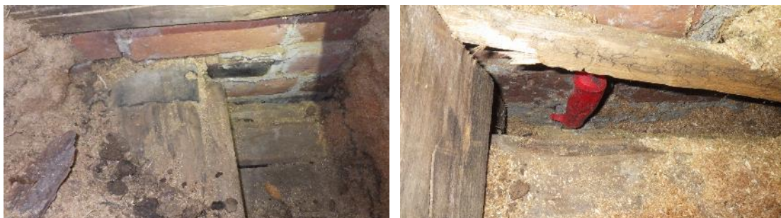
Kuva 65 a ja b. Yläpohjan kannatinpalkkien päät ovat tiiliseinän sisässä ja kannatinpalkkien päiden ympärillä on bitumikermi, kuten välipohjien kannatinpalkeissa. Kannatinpalkki on aistinvaraisesti arvioiden hyväkuntoinen. Yläpohjassa ei ole ilmatiivistä rakennekerrosta (esim. rakennuspapero tms.). Tiiliseinän ja sisäverhousrakenteiden (paneeli ja huokoinen puukuitulevy) välissä on rako (puukko työnnetty rakoon).
