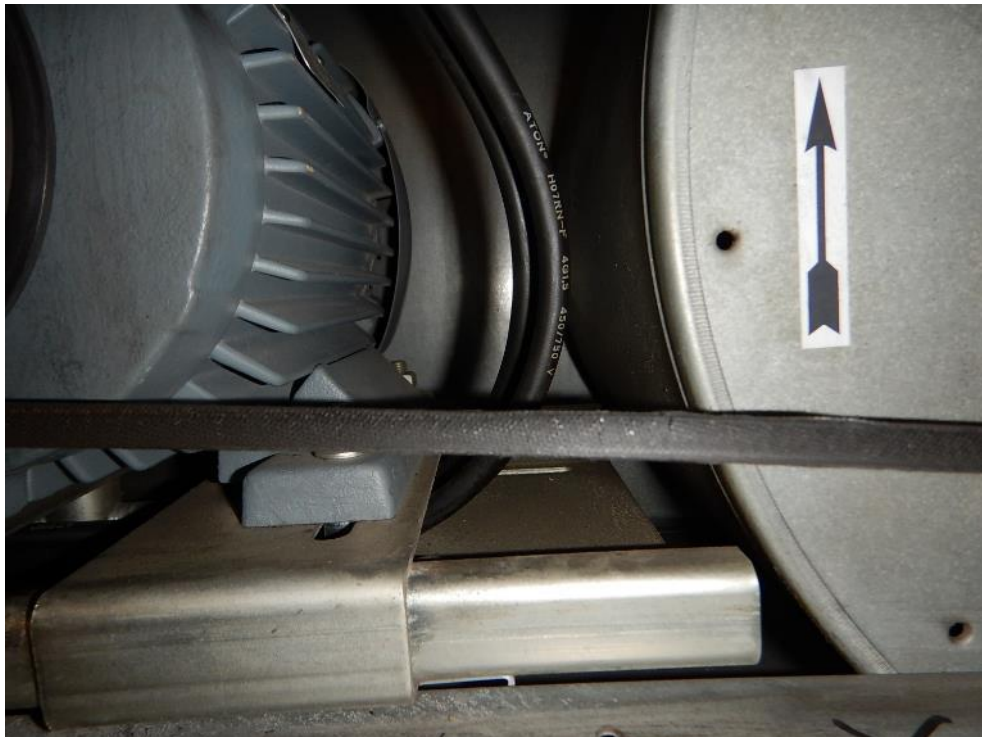
Kuva 89. Poistoilmapuhaltimen hihnassa on pieniä murtumia.
