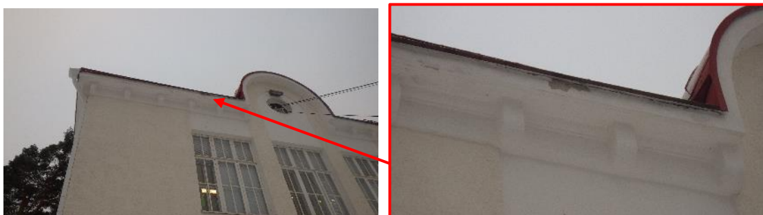
Kuva 37. Yksittäisessä kohdassa räystäään rappaus on paikallisesti irronnut.
