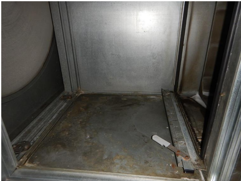
Kuva 75. Tuloilmasuodattimen kammiossa on kosteuden aiheuttamia jälkiä. Suodatinkehikon tiivisteet ja lukitukset ovat kunnossa. Lto-kiekkokone on siistissä kunnossa.
