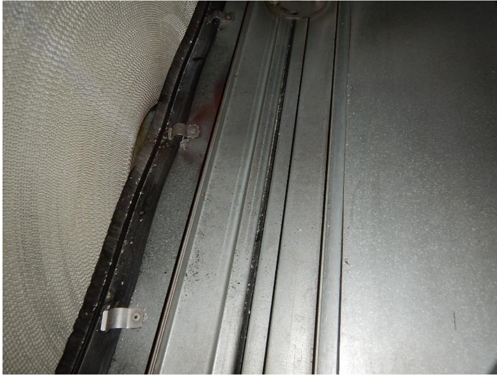
Kuva 88. Lämmöntalteenoton ja poistoilmapuhaltimen välillä kammiossa on irtoroskaa.
