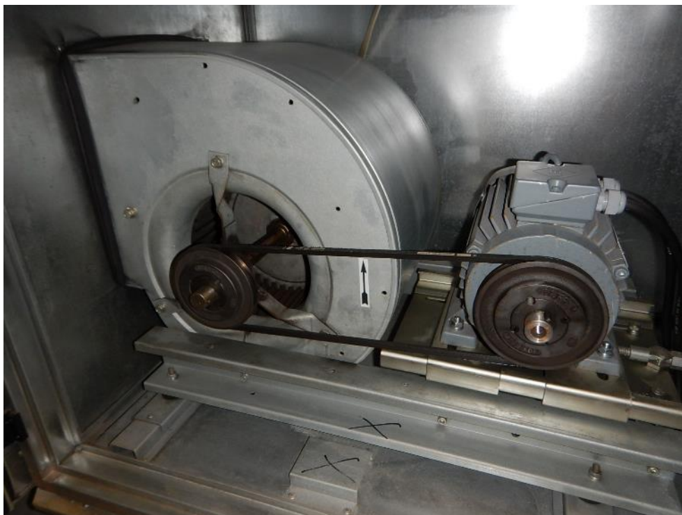
Kuva 80. Tuloilmapuhallin. Hihna on hieman kulunut.
