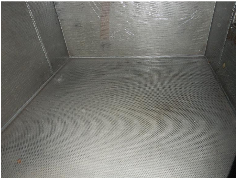
Kuva 83. Tuloilmakammio on siistissä kunnossa, vain hieman pölyä. Eristeen ja reikäpellin välissä on muovi, mikä estää kuitujen kulkeutumisen eristeestä tuloilmaan.
