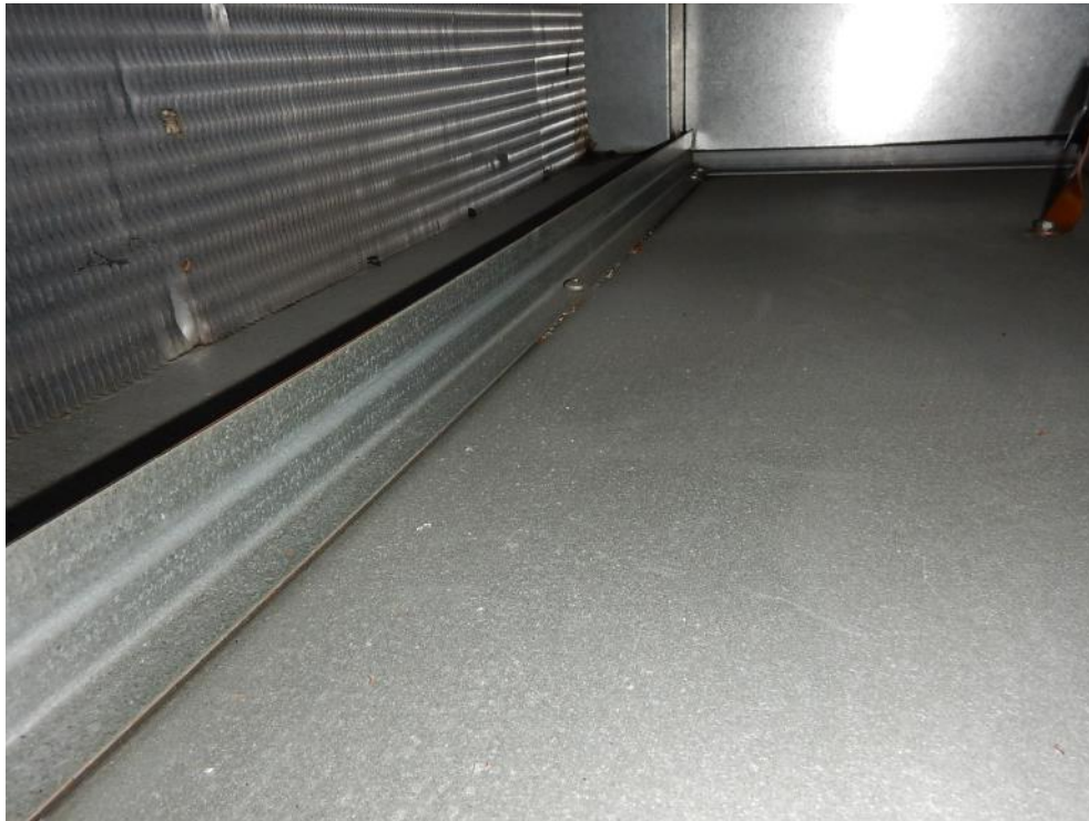
Kuva 78. Lto:n ja lämmityspatterin välissä on hieman irtoroskia.
