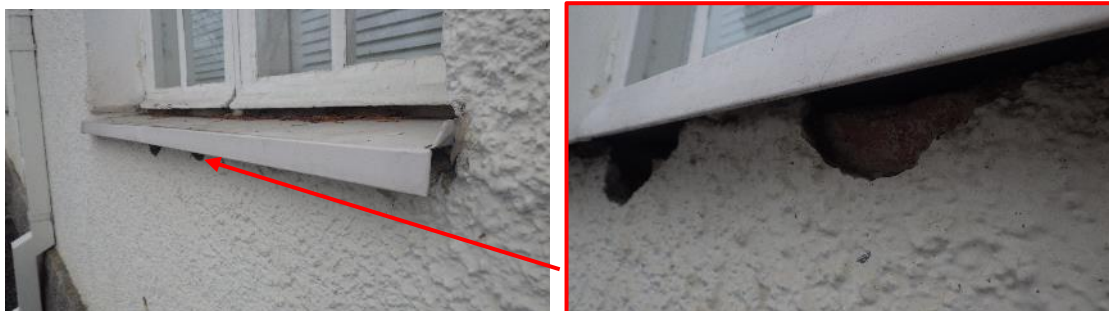
Kuva 35. Yhden ikkunan alapuolella rappaus on paikoin lohkeillut ja irtoillut.
