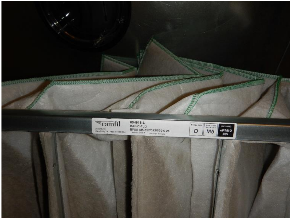
Kuva 86. Poistoilmasuodatin on hieman pölyinen. Suodatusluokka on M5.
