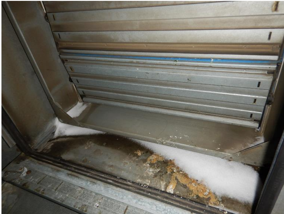
Kuva 72. Raitisilmäpelti ei sulkeudu täydellisesti. Raitisilmäpellin ja tuloilmasuodattimen välisessä kammiossa on lunta.
