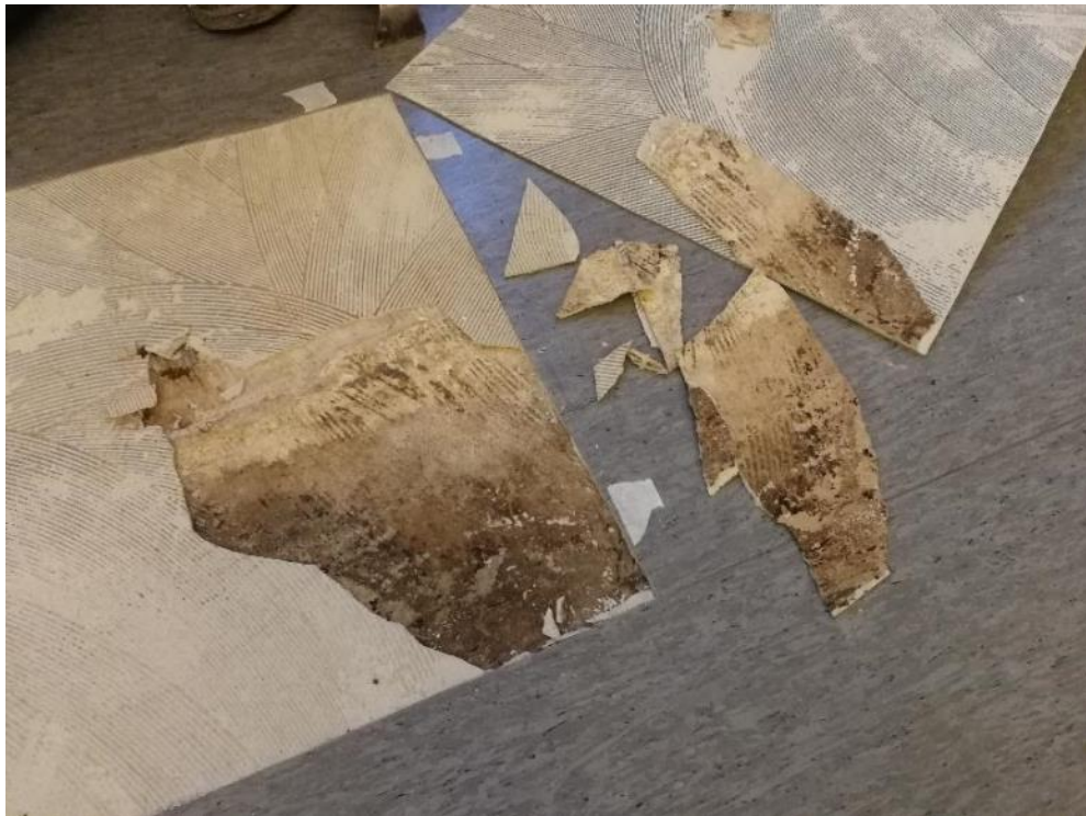
Kuva 4. Aulan lattian muovimaton alla olevan tasoitekerroksen alla on tumma bitumiliimakerros, joka sisältää asbestia (ks. Kuva 6). Uuden tasoitteen alla tumman bitumiliimakerroksen pinnassa on voimakas poikkeava maakellarimainen haju.
