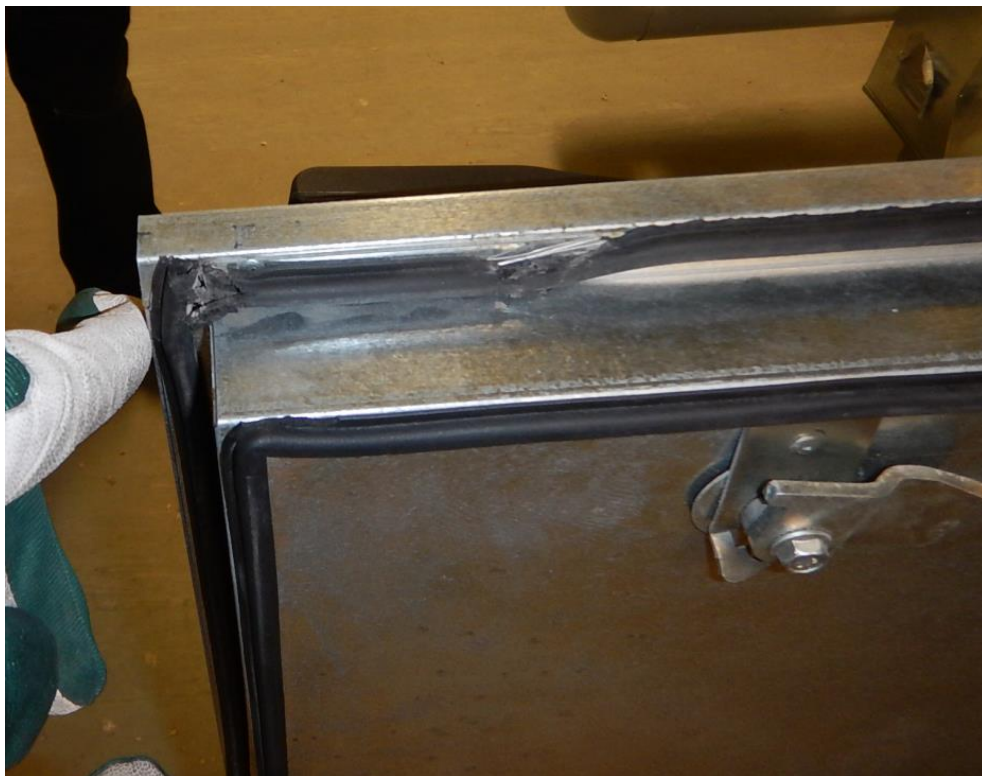
Kuva 71. Tuloilmapuhaltimen huoltoluukun tiiviste on osittain rikkoutunut.
