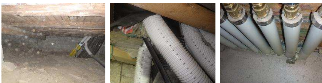
Kuvat 16 a...c. Tilan 101 kohdalla sijaitsee LV-verkoston putkiläpivientejä, joissa on osin käytetty salaojaputkea suojaputkena. Ryömintätilasta tarkasteltuna läpiviennit on tiivistetty mineraalivillalla ja ne ovat aistinvaraisesti arvioituna epätiiviiitä. Sisätiloista käsin tarkasteltuna läpiviennit on tiivistetty polyuretaanivaahdolla, eikä läpivienneissä havaittu merkittäviä ilmatiiveyspuutteita. Merkkisavulla tarkasteltuna ei havaittu merkittäviä ilmapirtauksia sisäilmaan päin.
