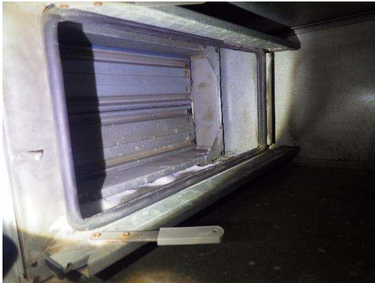
Kuva 79. Suodatin ei ollut kunnolla tilassaan. Suodattimen kehyksen niitti ottaa kehik- koon kiinni, minkä vuoksi 1-2 pussia jäi aukon ulkopuolelle. Kehikon lukitukset ovat todella jäykät. Asiasta ilmoitettu vastaavalle huoltohenkilölle tarkastuksen yhteydessä.
