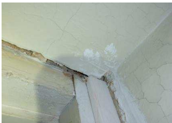
Kuva 71. Yläpohjan rakenneliittymissä ei havaittu ilmansulkukerrosta.
