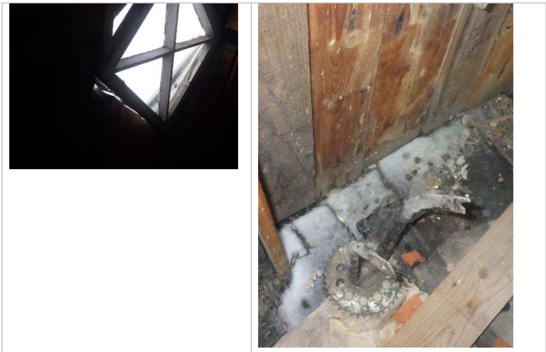
Kuvat 67 a...c. Ullakon ikkunoista yksi oli rikki ja muiden sadevedentiiveydessä on puutteita. Ullakolla havaittiin paikoitellen sinne tuiskunnutta lunta. Pääosin lunta oli ikkunoiden läheisyydessä, mutta myös räystääslinjojen lähellä.
