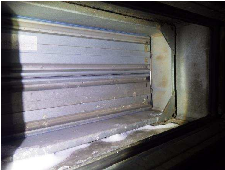
Kuva 77. Raitisilmakammioista pääsee lunta kulkeutumaan ilmanvaihtokoneeseen.
