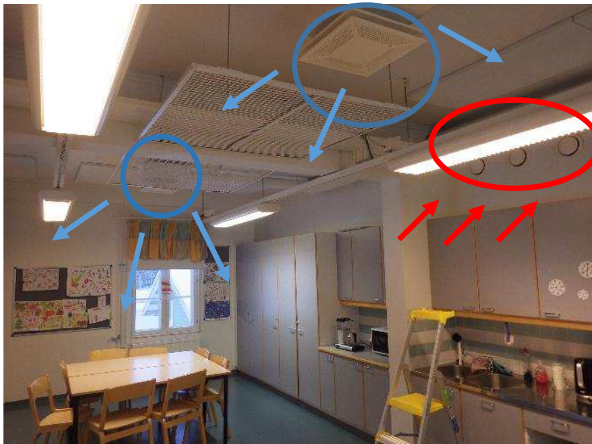
Kuva 87. Tyypillinen ilmanjako oleskelutiloissa. Sinisellä on ympyröity tuloilman päätelaite ja punaisella poistoilman päätelaitteet.
