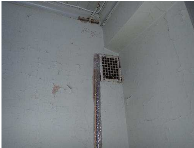
Kuva 90. Toisen kerroksen hormisäleikkö. Tutkimusten yhteydessä havaittiin selvää virtausta hormiin päin.
