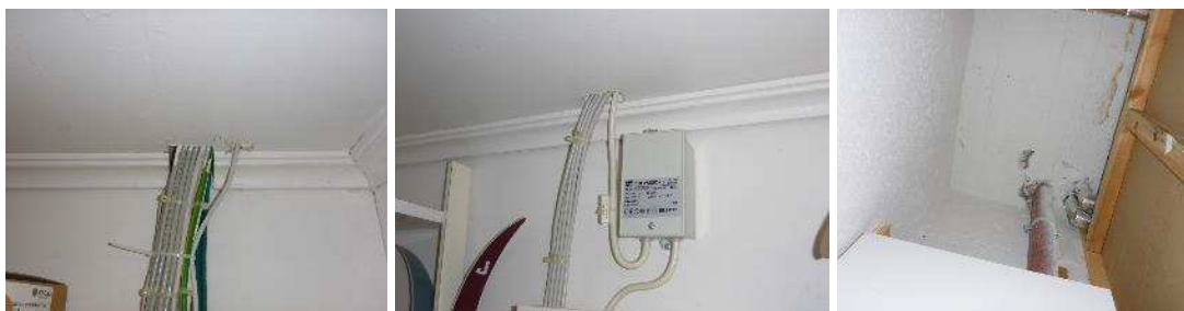
Kuvat 42 a...c. Ensimmäisen kerroksen tiloista käsin havaittiin epätiivittä välipohjan sähköläpivientejä sähkökeskuksessa (kuvat a ja b). Viemäriputken läpiviennissä ei havaittu merkittäviä tiiveyspuutteita (kuva c).
