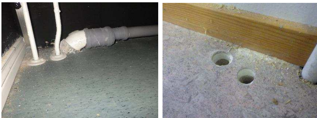
Kuvat 43 a ja b. Toisen kerroksen tiloista tarkasteltuna osassa välipohjien läpiviennistä on käytetty läpivientikappaleita. Pääosin välipohjan läpiviennit ovat epätiivittä tai täysin avoimia toisen kerroksen tiloihin. Läpiviennistä havaittiin selvää ilmavirtausta toisen kerroksen huonetilaan merkkisavun avulla tarkasteltuna.
