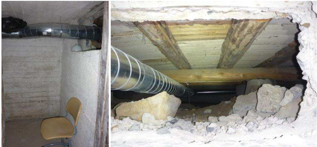
Kuva 33. Tilan 004 ryömintätilan vastaisessa seinässä on aukko ryömintätilaan.
