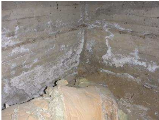
Kuva 12. Perusmuurin alaosassa on suolakertymää erityisesti etupihan puoleisella seinustalla.
