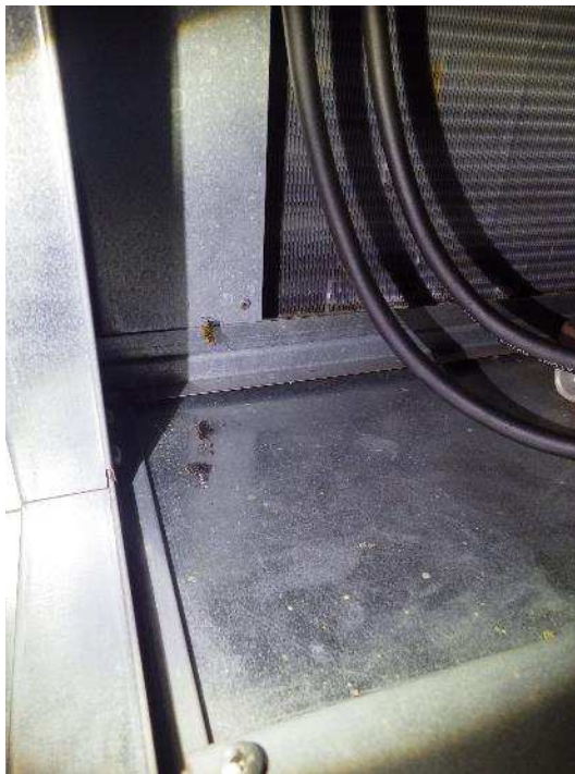
Kuva 82. Lämmityspatterin ja puhaltimen välissä on kuolleita kärpäsiä ja muuta irtoroskaa.
