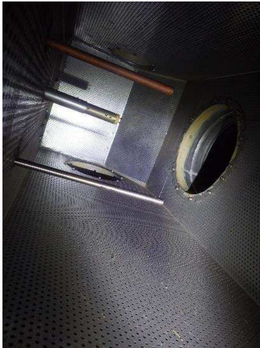
Kuva 85. Tuloilmakammio on hieman pölyinen. Antureiden läpiviennit ovat siistit ja reikäpellin alla on muovi, mikä estää eristeessä olevien kuitujen kulkeutumisen sisäilmaan.
