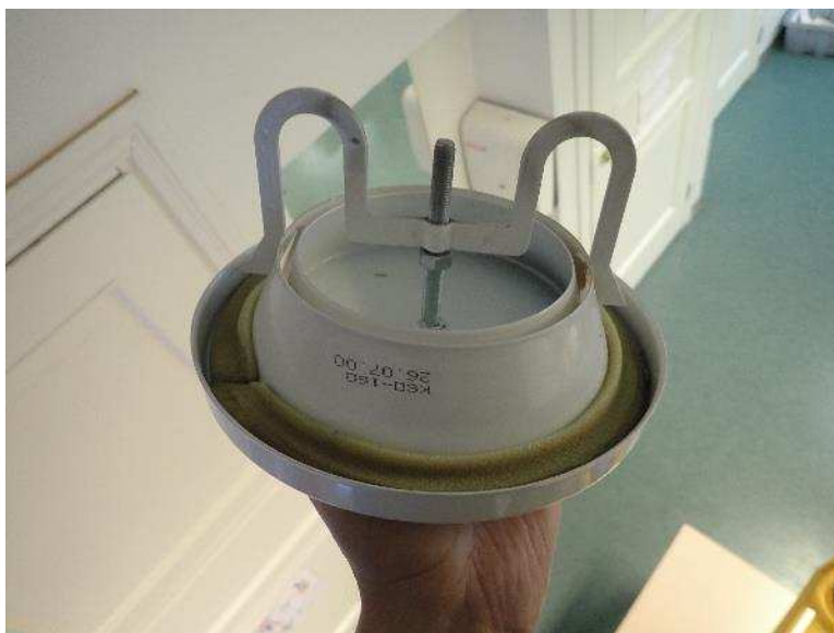
Kuva 88. Poistoilmakanavan päätelaite on siisti, hieman pölyinen.
