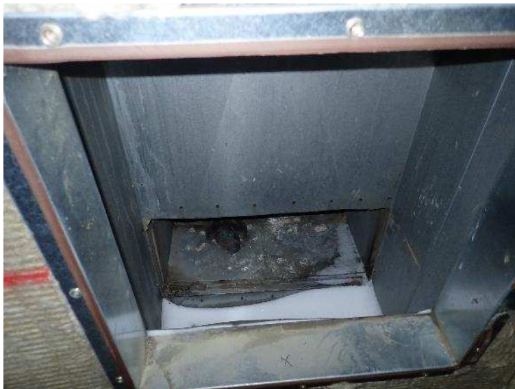
Kuva 76. Raitisilmakammiossa on lunta ja kuollut lintu. Saatujen tietojen mukaan raitisilma-aukkoon on lisätty eläinverkko. Asiasta ilmoitettu vastaavalle huoltohenkilölle.
