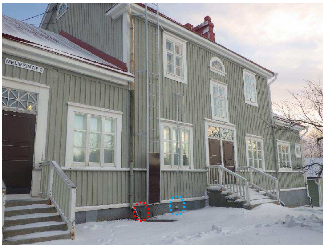
Kuva 4. Lumi on sulanut ryömintätilan kuivatusjärjestelmän ulospuhallusputken vaikutusalueelta rakennuksen Meijerintien puoleiselta sivulta. Ulospuhallusputki on merkitty kuvaan punaisella ympyrällä. Sinisellä ympyrällä on merkitty ryömintätilan kuivatusjärjestelmän sisäänotto.
