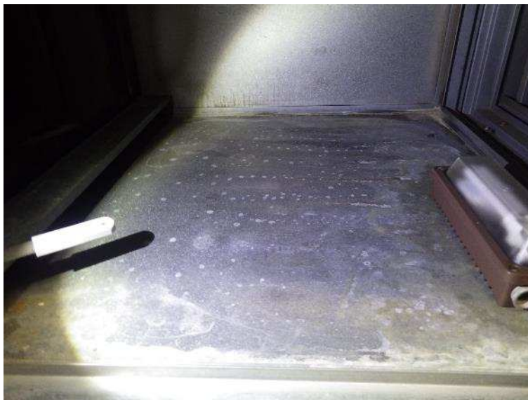
Kuva 80. Suodatinkammiossa on kosteuden aiheuttamia jälkiä.
