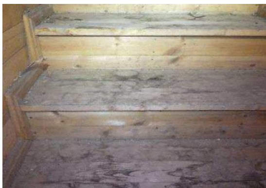
Kuvat 70 a...c. Toisen kerroksen tiloissa havaittiin kosteusjälkiä monin paikoin yläpohjarakenteen alapinnassa, ulko- ja väliseinien sisäpinnoilla sekä ullakolle johtavassa portaikossa.
