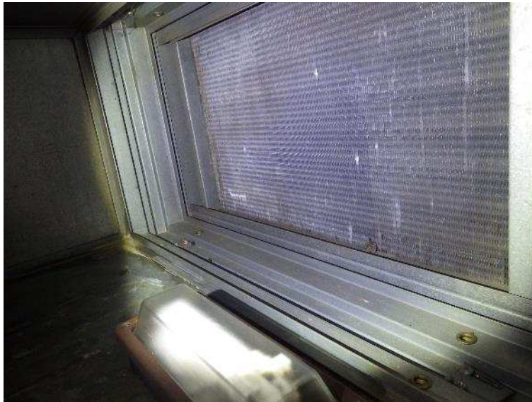
Kuva 81. Lämmityspatteri on pölyinen ja siinä on hieman irtoroskia.
