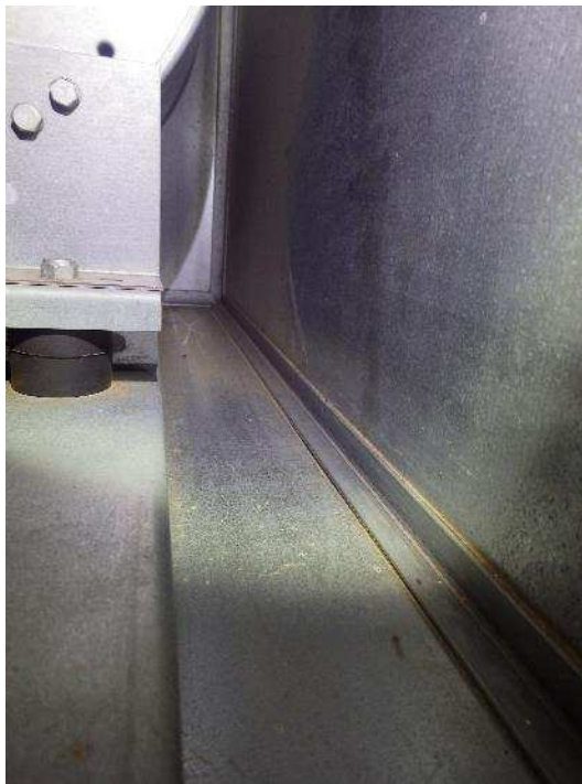
Kuva 84. Puhallinkammio on hieman pölyinen.
