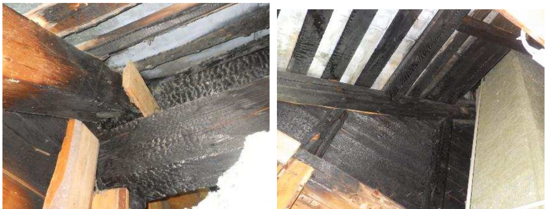
Kuvat 68 a ja b. Rakennuksen pohjoispäädyssä havaittiin palojälkiä ulkoseinässä sekä vesikaton rakenteissa.
