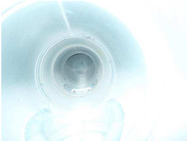
Kuva 89. Poistoilmakanava on siisti.
