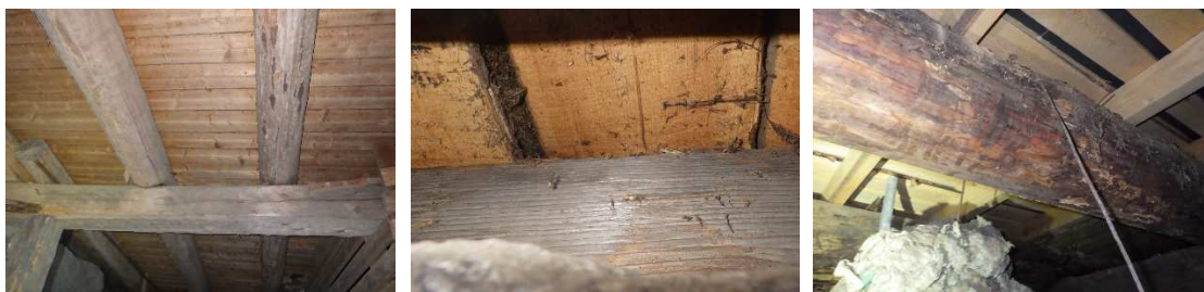
Kuvat 15 a...c. Aluslaudoitus on maapohjaisen kellaritilan alueella hyväkuntoinen. Pääosin alapohjarakenne on alkuperäinen, aluslaudoituksen välistä näkyy rahkasamalta (kuva b). Wc-tilan (tila 6) kohdalla alapohjarakenne on uusittu, aluslaudoituksen yläpuolella havaittiin tuulensuojalevy (kuva c).
