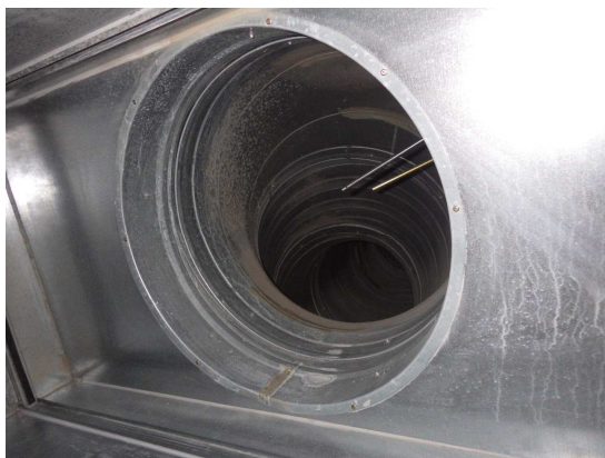
Kuva 70. Poistoilmakanava on melko pölyinen.
