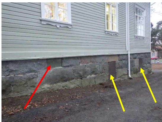
Kuva 11. Punaisella nuolella merkitty ryömintätilan tuuletusaukko takapihan puolella on ummessa. Keltaisilla nuolilla merkityt ummistetut aukot ovat maapohjaisen kellaritilan kohdalla.
