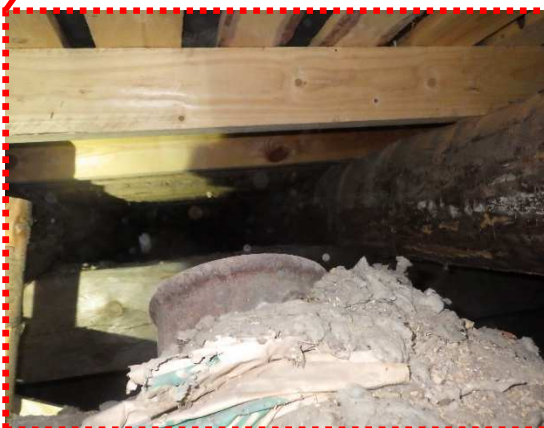
Kuvat 14 a...c. Kellaritilassa on jonkin verran rakennusjätettä (esim. kosteusvaurioitunutta purettua puutavaraa ja kuvassa c esitetty käytöstä poistettu viemäriputki lämmöneristeeseen) ja muuta sekalaista tavaraa.
