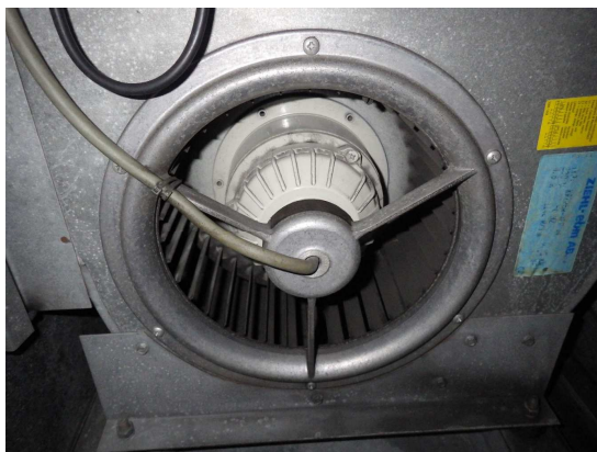
Kuva 73. Puhaltimessa on pinttynyttä pölyä.
