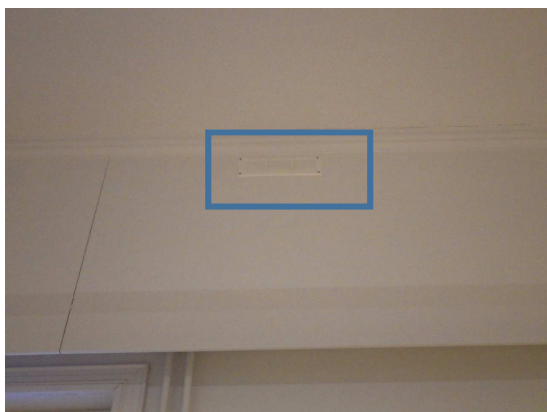
Kuva 75. Korvausilmaventtiili, joka on ollut käytössä ennen peruskorjausta.
