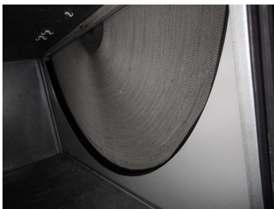
Kuva 67. LTO-kiekko on siisti ja tiivisteet ovat hyvässä kunnossa.
