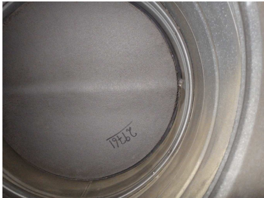
Kuva 52. Raitisilmapelti sulkeutuu tiiviisti.
