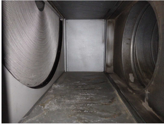
Kuva 54. Suodatinkammiossa on kosteuden aiheuttamia jälkiä. Suodatin asettuu tiiviisti uraansa. Pyörivä lämmönsiirtokenno on siisti.
