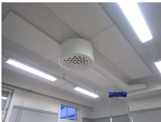
Kuva 74. Tilojen ilmanjako on toteutettu kattohajottajilla.
