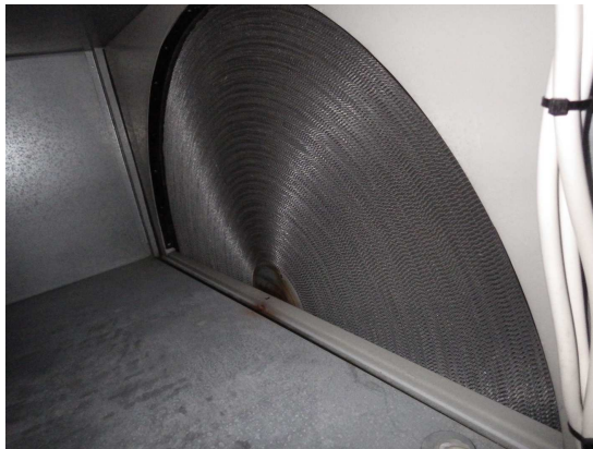
Kuva 61. Lämmöntalteenottokenno on siisti.
