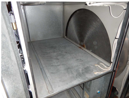
Kuva 59. Poistoilmasuodattimen ja tulopuhaltimen välinen tiiviste on rikki, mikä saattaa aiheuttaa ohivirtausta.
