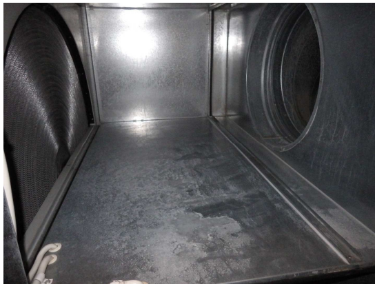
Kuva 72. Suodatinkammio on siisti, mutta hieman pölyinen. LTO-kiekko on siisti.
