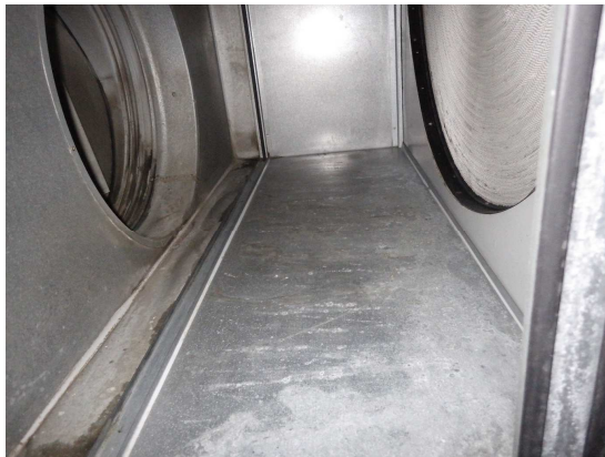
Kuva 66. Suodatinkammiossa on kosteuden aiheuttamia jälkiä, mutta se on muuten siistissä kunnossa. Suodatinkehikko asettuu tiiviisti uraansa.
