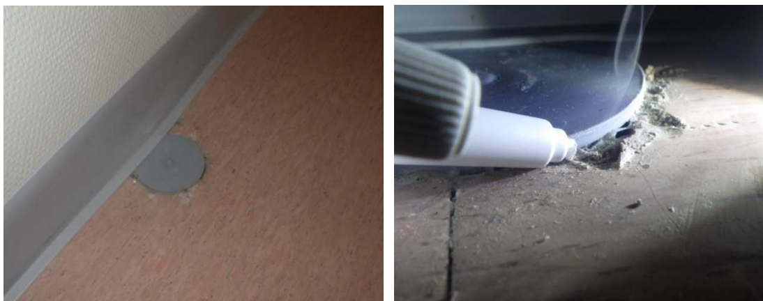
Kuvat 26 a ja b. Tilan 22 lattiassa on tulpattu viemäriputken läpivienti. Läpivienti on tiivistetty massalla, mutta läpivienti on epätiivis. Läpiviennin kohdalta havaittiin mikrobiperäinen haju sekä selvä ilmavirtaus sisäilmaan päin merkkisavulla tarkasteltuna.
