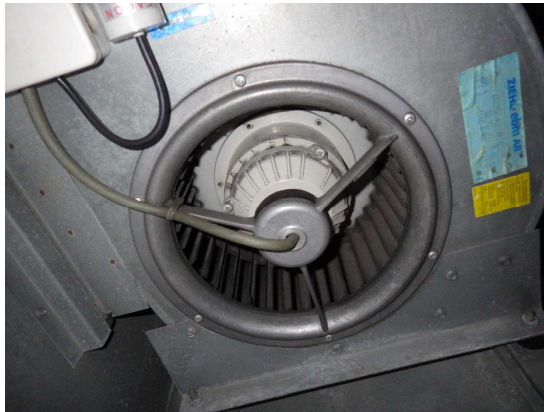
Kuva 57. Puhaltimessa on pinnittynyttä pölyä.
