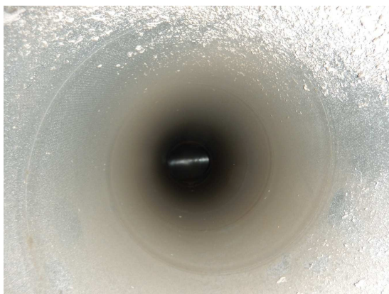
Kuva 77. Poistoilmakanava on melko pölyinen, mutta kanaviston kierresaumat erottuvat vielä selvästi. Kanavan etuosassa näkyy tasoiteroiskeita.
