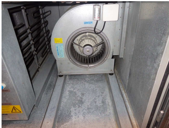
Kuva 69. Puhallinkammio on hieman pölyinen. Puhaltimessa on pinttynyttä pölyä.
