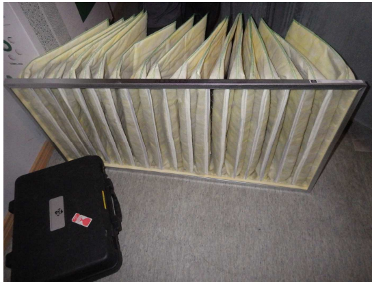
Kuva 60. Poistoilmasuodatin on siisti. Suodatusluokka on M6.
