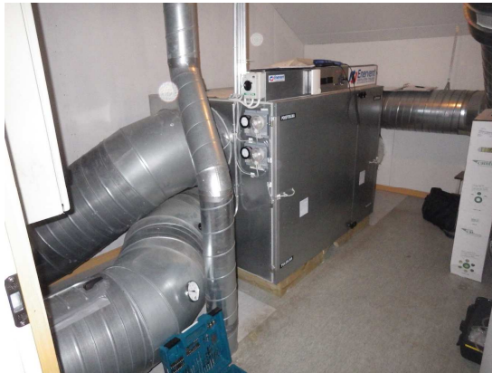
Kuva 51. Tulo- ja poistoilmanvaihtokone TK01.
