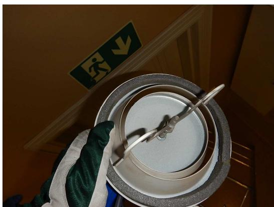
Kuva 76. Poistoilmaventtiili on hieman pölyinen, mutta suhteellisen siisti.
