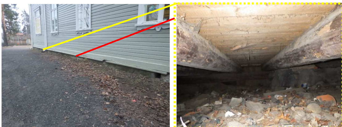
Kuvat 9 a...d. Rakennuksen itäpäädyssä ryömintätilan pohja on viereisen piha-alueen pinnan tason alapuolella ja sokkelissa olevat tarkastusluukut viereisen maanpinnan tasalla. Ryömintätilan pohjalla on vähäisessä määrin sekalaista jätettä. Kuvassa b näkyy wc-tilan (tila 27) viemäriputkien kannakointeja ja lämmöneristystä. Aluslaudoitus on hyväkuntoinen siltä osin kuin sitä pystyttiin tarkastelemaan.
