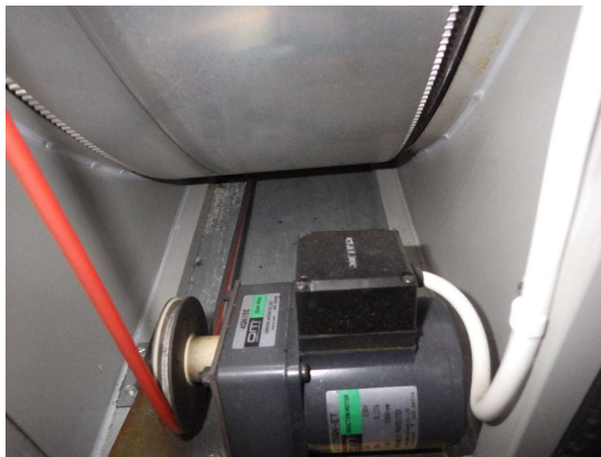
Kuva 55. LTO-kennon hihnan kireys on hyvä ja tiivisteet kunnossa. Kammion pohjalla on vähän irtoroskaa.
