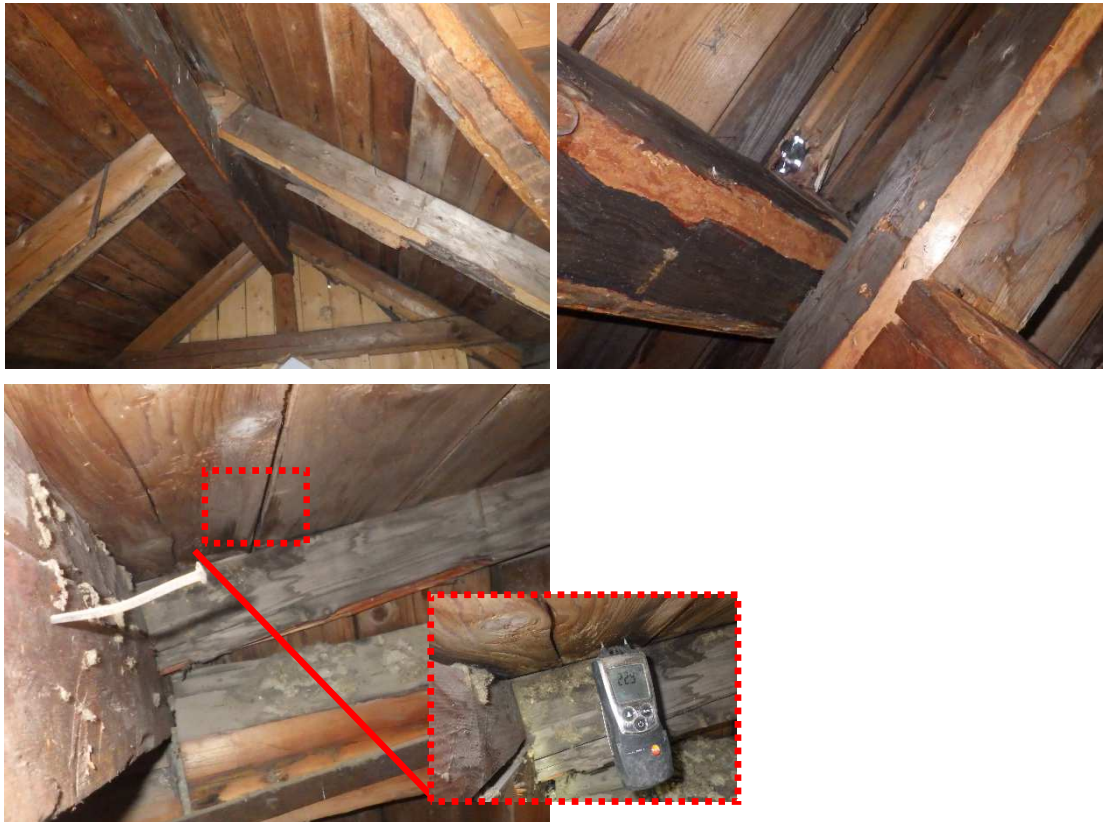
Kuvat 47 a...d. Vesikatteen alapuolella on tiivis aluslaudoitus. Aluskatetta ei ole. Vesikatossa havaittiin yksi reikä tilan 7 kohdalla. Aluslaudoitus on kastunut räystääslinjoilla (kosteuspitoisuus enintään 24,6 p-% piikkimittarilla mitattuna).
