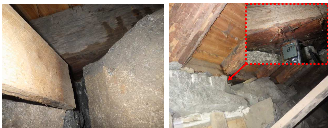
Kuvat 17 a...c. Yleiskuvia graniittisokkelin ja ulkoseinän alimman hirren liittymästä. Alapohja-sokkeli liittymissä havaittiin yleisesti tummentumaa. Alimpien hirsien kosteuspitoisuuksia mitattiin puupiikkimittarilla pistokoeluontoisesti, kosteuspitoisuudet olivat 11,9...16,2 p-%.
