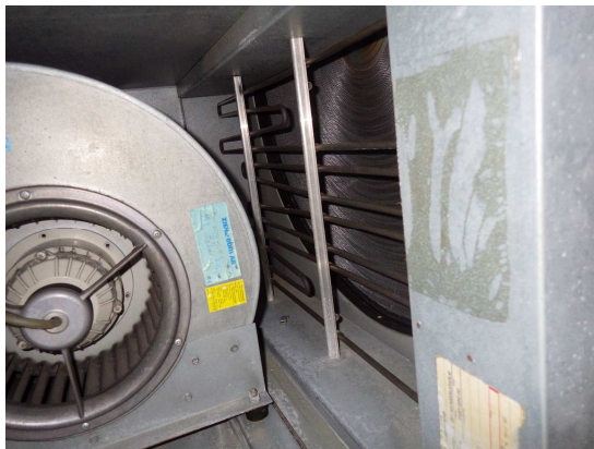
Kuva 56. Tuloilman tarvittava lisälämmitys hoidetaan sähköpatterilla. Rakennusautomaatiojärjestelmän mukaan tarkastushetkellä sähköpatterin teho oli 0 %, mutta todellisuudessa vastukset olivat lämpimät. Kammiossa on hieman pölyä.
