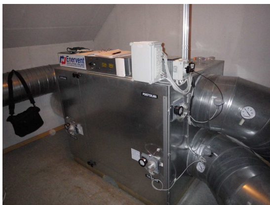
Kuva 63. Tulo- ja poistoilmanvaihtokone TK02.
