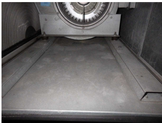
Kuva 62. Puhallinkammiossa on hieman pölyä.
