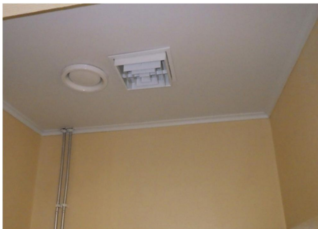
Kuva 42. Poistoventtiilit ovat pääosin kartioventtiilejä.
