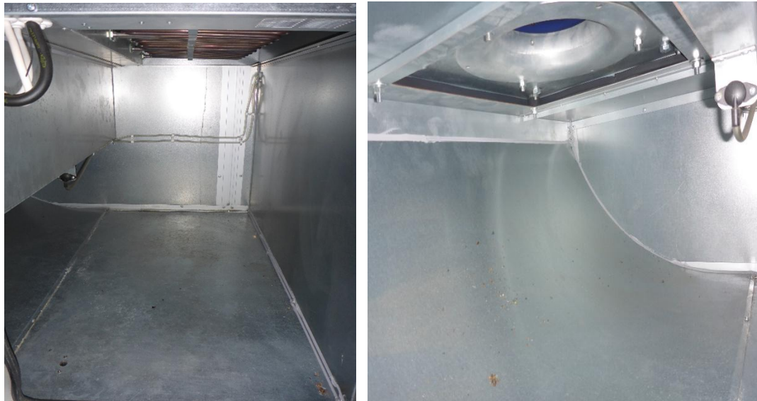
Kuva 36 a ja b. Tuloilmakammiossa on jonkin verran likaa.
