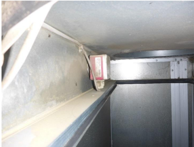
Kuva 31. Raitisilmakanava ennen tuloilmasuodatinta on likainen.
