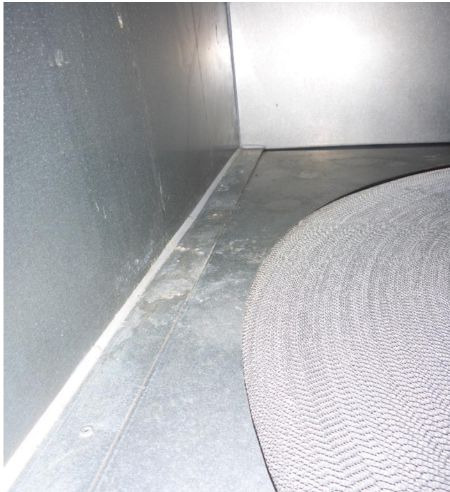
Kuva 34. LTO-kennon kammiossa ja kehikon pinnalla on kosteuden aiheuttamia jälkiä. Lämmöntalteenottokenno on hyväkuntoinen.
