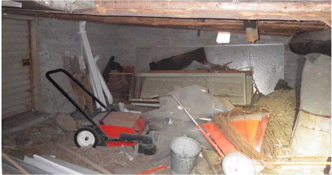
Kuva 5. Ryömintätilan eteläpäässä ryömintätilaa käytetään osin varastotilana. Lisäksi ryömintätilan pohjalla on orgaanista materiaalia, kuten lehtiä. Ryömintätilassa havaittiin lievästi maakellarimaista hajua.
