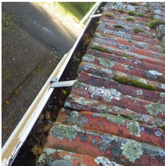
Kuva 22. Räystäskouruissa havaittiin roskaa
