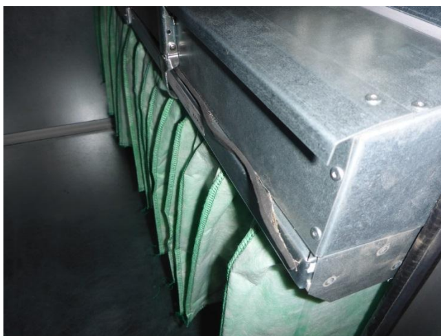
Kuva 33. Poistoilmasuodattimen suodatinkehyyksen tiiviste on rikki.
