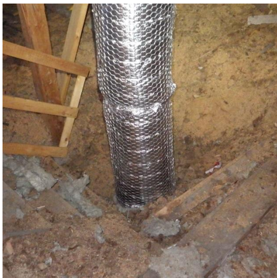
Kuva 25. Lämmöneristävyys on heikko IV-läpivientien ympäriltä.
