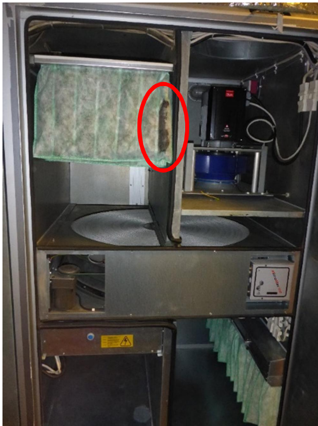
Kuva 30. TK1 sisältä. Tuloilmasuodatin on revennyt
