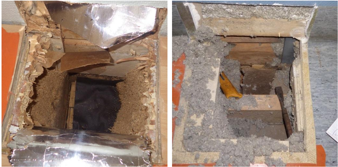
Kuvat 14a ja b. Valokuvat välipohjiin tehdyistä rakenneavauksista. RAK 1 (vasen kuva) tehtiin ylemmään välipohjaan tilan 205 lattiaan. Välipohjatäyttönä on sahanpurua ja kutterilastua. Avauksesta ei havaittu poikkeavaa hajua. Kutterilastusta otetussa materiaalinäytteessä havaittiin epäily mikrobikasvusta. RAK4 (oikea kuva) tehtiin alempaan välipohjaan tilan 112 lattiaan. Tutkimushetkellä avauksesta kävi voimakas ilmavirtaus sisäilmaan päin. Avauksesta ei havaittu poikkeavaa hajua. Välipohjatäyttönä on puukuitueriste.
