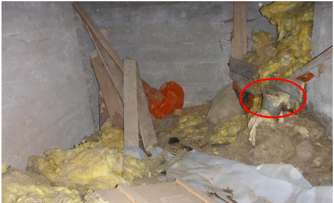
Kuva 10. Kellarin vierustalla on runsaasti rakennusjätettä ja vanha viemärin pää sekä viemäriperäistä jätettä (punainen ympyrä).
