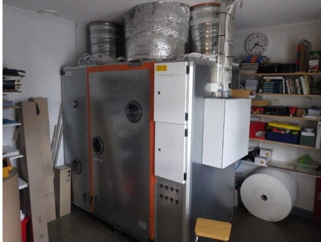
Kuva 29. Yleiskuva ilmanvaihtokoneesta TK1. Luukkuja on yritetty tiivistää teippaamalla.
