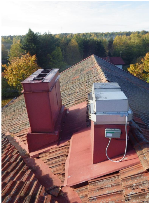
Kuva 40. Erillispoisto PK46 vesikatolla.
