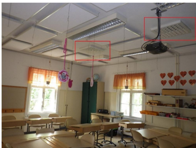
Kuva 41. Luokkahuoneen tuloilman kattohajottajat.
