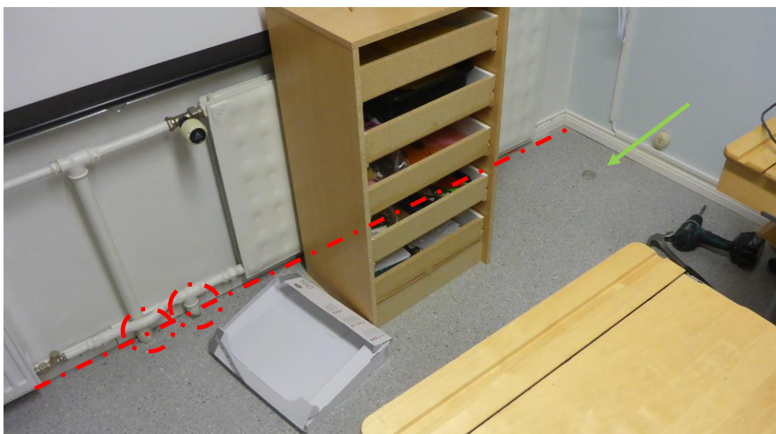
Kuva 27. Merkkiainekoe MA3 tehtiin 2. kerroksen tilaan 203. Merkkiainekokeen aikana sisäilma oli 8 Pa alipaineinen ulkoilmaan nähden (normaalitilanteessa 1-2 Pa). Merkkiainekokeen syöttöreikä tehtiin vihreän nuolen osoittamaan paikkaan. Reiästä ei
