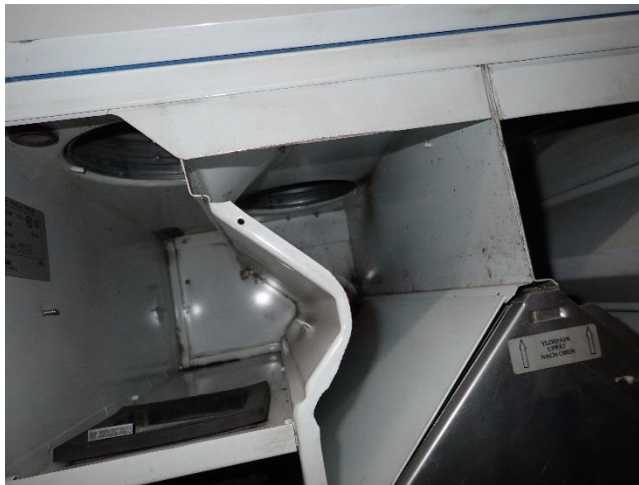
Kuva 45. Koneen sammuttamisen ja avaamisen jälkeen LTO:n ohituspelti oli kiinni. Pellin asentamista ennen sammuttamista ei voitu varmentaa.
