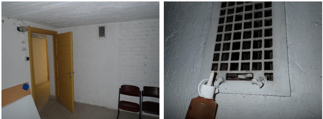
Kuva 59 a ja b. Kellarikerroksessa on vanhoja rakenneaineisia hormoneja, joista on ilmapvirtaus hormiin päin.
