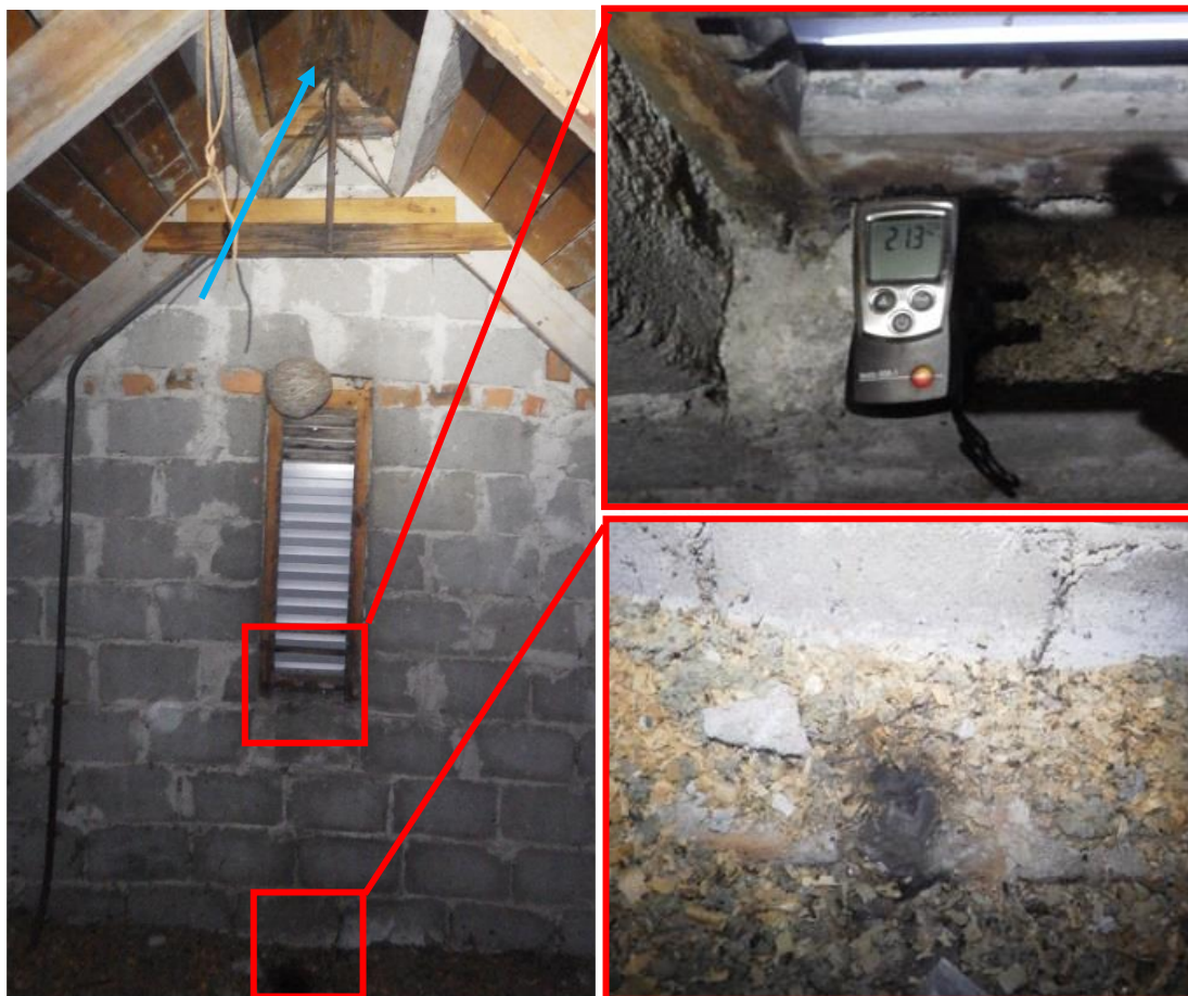
Kuvat 40 a, b ja c. Valokuva vuotokohdasta (sininen nuoli) vuotokohdalla tuuletusluukun puuosien kosteuspitoisuus on korkea (yläkuva) ja eristeessä havaittiin tummunut alue. Vuotokohdalle tehdyssä avauksessa ei havaittu vaurioita puurakenteissa (kts. seuraava kuva).
