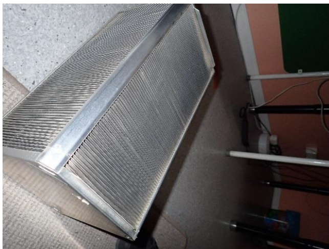
Kuva 47. LTO-ristivirtauskenno on hyväkuntoinen, mutta pölyinen.
