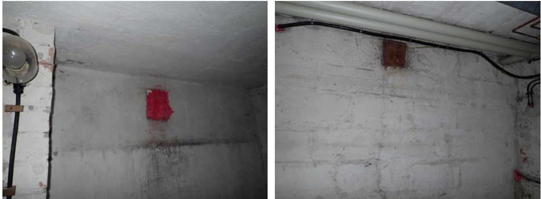
Kuva 60 a ja b. Osa vanhoista painovoimaisista poistoilmareiteistä on tukittu (vasen kuva). Osa korvausilmaventtiileistä on edelleen toiminnassa.
