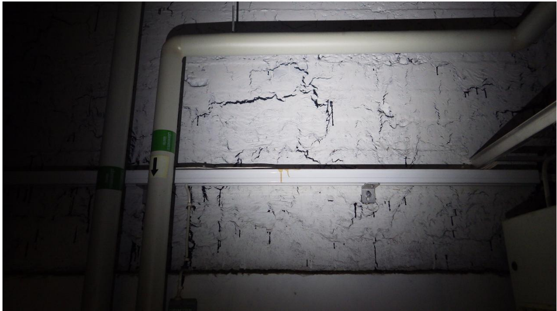
Kuva 7. Lämmönjakohuoneen (tila 008) maanvastaisten seinien sisäpuolisessa bitumisivellyssä havaittiin laajoja valumia ja sivelyn pinnassa oleva maali on halkeillut valumien johdosta.
