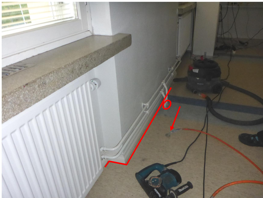
Kuva 31. Yleiskuva merkkiainekokeen MA-K7 toteutuksesta. Kaasun syöttöreiän kohta on merkitty kuvaan vihreällä nuolella. Merkkiainekokeessa havaittiin kohtalaista ilmavuotoa patteriputkien läpivientien kautta sekä välipohjan ja ulkoseinän liittymästä. Vuotokohtat on merkitty kuvaan punaisella.
