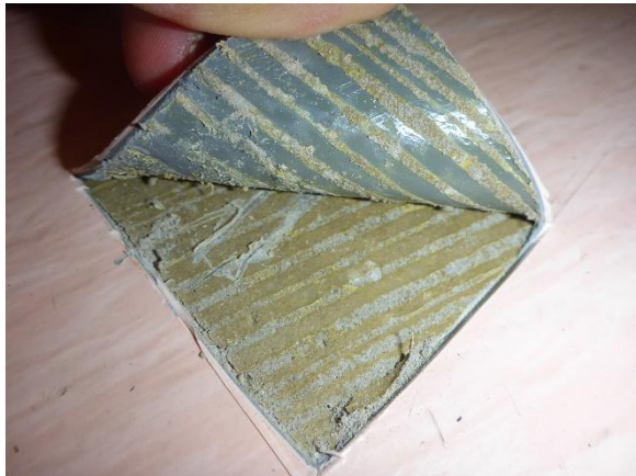
Kuva 20. V3, tila 171 (Hlö.k. pu + pe). Viiltomittauksen tulos 61,6 %RH. Maton tartunta heikohko, lievästi kemikaalimainen haju, murtopinta liimassa.
