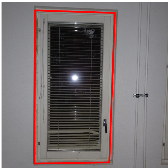
Kuva 37. Kuva merkkiainekokeessa MA-K3 havaituista vuotopaikoista. Kaasun syöttöreikä on seinän alaosassa. Merkkiainekokeessa havaittiin kohtalaista ilmavuotoa tuuletusikkunan ikkunaliittymissä. Vuotokohdat on merkitty kuvaan punaisella.
