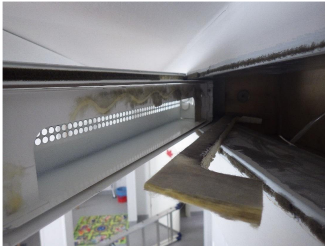
Kuva 88. Tuloilman päätelaitteessa on äänenvaimennusmateriaalina mineraalivilla, joka oli yhdessä tarkastetussa päätelaitteessa irti niin, että avoimet villapinnat olivat näkyvissä.
