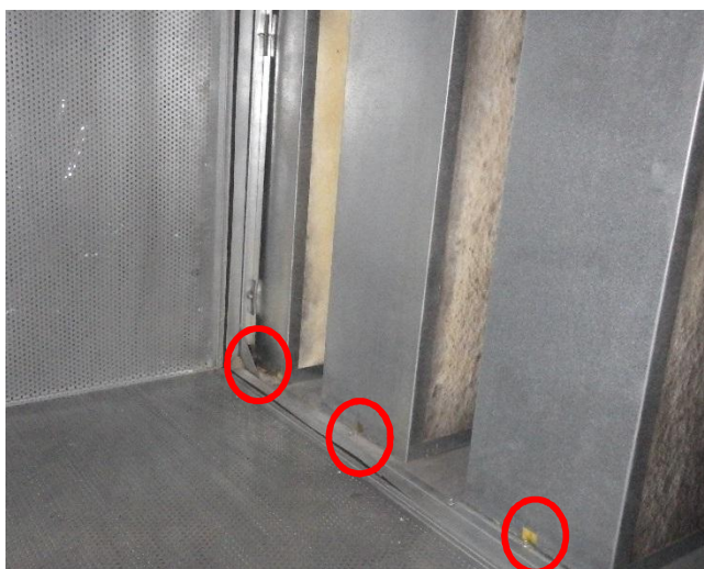
Kuva 72. Tuloilmakammio on puhdas. Vaimenninmateriaalina on reikäpellillä ja muovikalvolla suojattua mineraalivillaa. Äänenvaimentimet ovat kuitukankaalla suojattua mineraalivillaa. Äänenvaimentimet ovat osin likaisia. Äänenvaimenninkasettien kiinnityskohdissa on mineraalivillaa vähäisesti näkyvissä.
