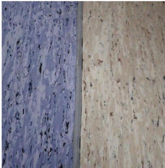
Kuva 12. Laajennusosan pesuhuoneiden (tilat 174 ja 151) muovimaton sauma oli auki roiskevesialueella. Pintakosteuslukemat sauman lähellä eivät poikenneet muualla pesuhuoneissa esiintyneistä lukemista.
