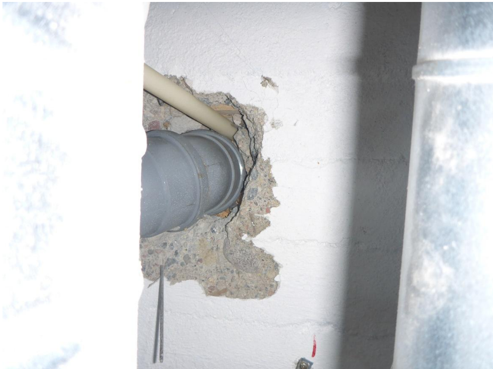
Kuva 51. Yläpohjassa havaittiin epätiiviyttä läpivientejä. Läpivienneistä havaittiin orgaanista täyttömateriaalia.
