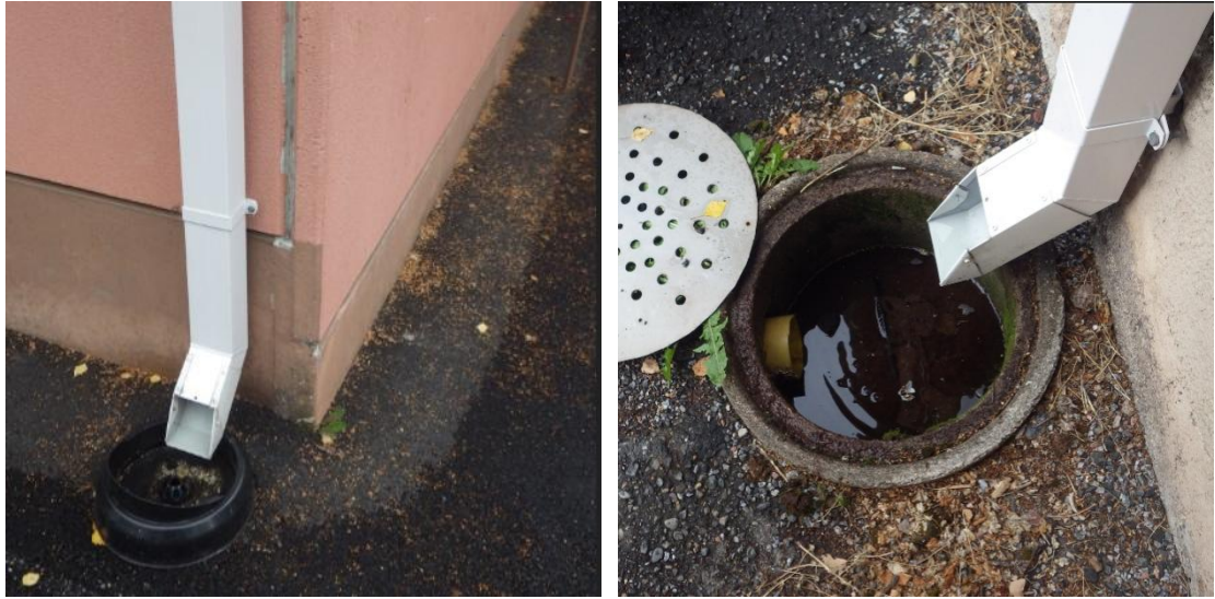
Kuva 3. Osa rännikaivoista on uusittu (vasen kuva) ja osa rännikaivoista on alkuperäisiä. Alkuperäisessä rännikaivossa ei ole roiskevesisuojausta.
