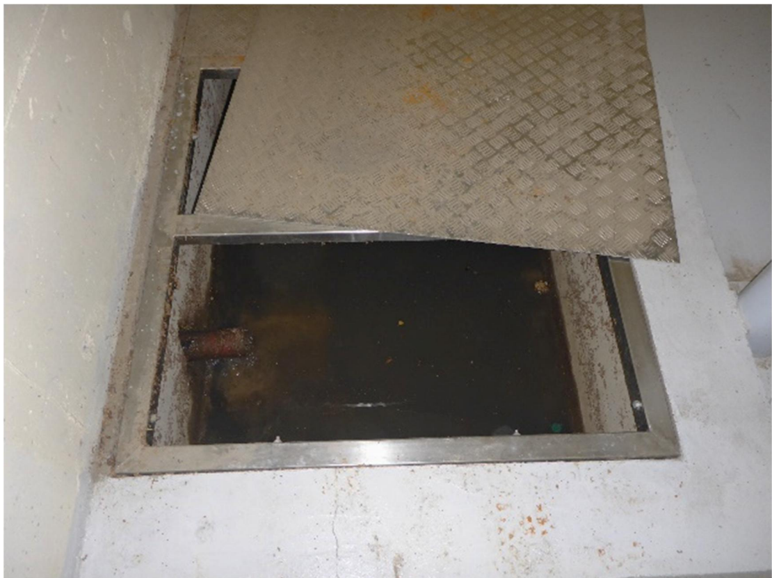
Kuva 8. Laajennusosan väestönsuojan porrashuoneessa (tila 050) sijaitseva väestönsuojan jätevesipumppaamon peltikannessa ei ole tiivisteitä ja kannessa ei ole lukitusta. Tutkimushetkellä kaivoon virtasi sadevettä viemäriputken läpiviennistä. Kaivon tarkempi kuvaus on esitetty kappaleessa 6.1. Kaivosta havaittiin tutkimushetkellä lievää maaperän hajua.
