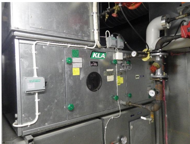
Kuva 61. Yleiskuva keittiön tuloilmakoneesta TK12, joka on asennettu TK11:n päälle.
