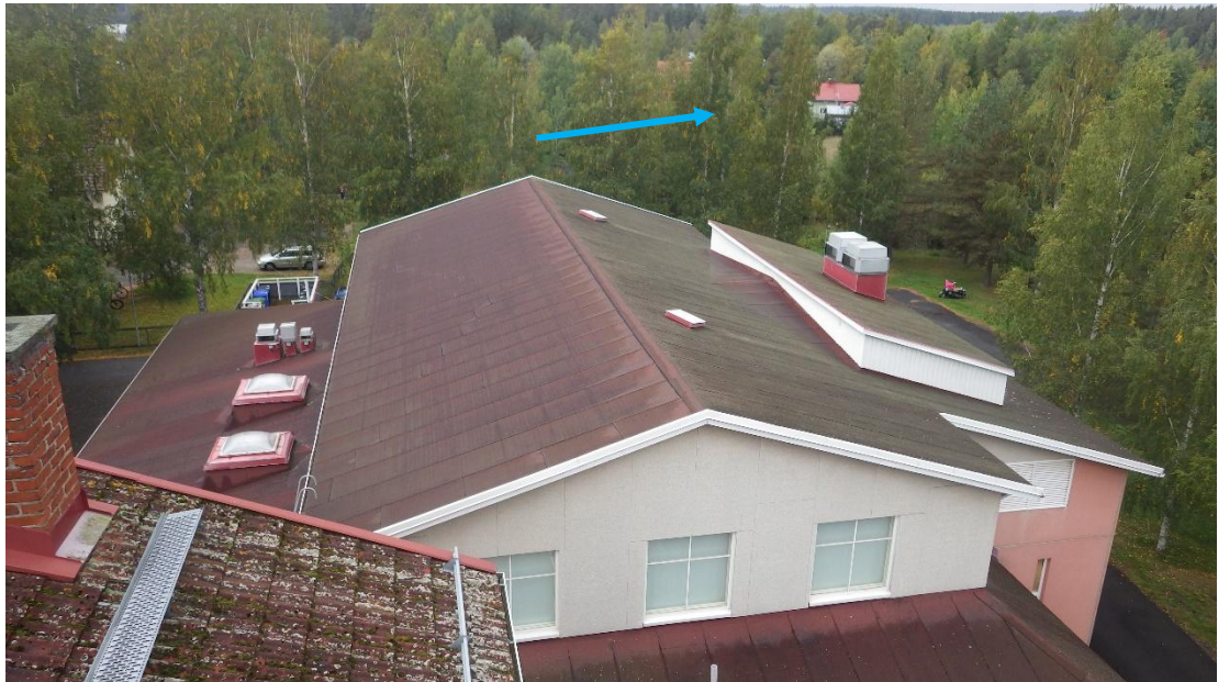
Kuva 39. Liikunta-/ruokasaliin pohjoispuoleinen vesikatto on hieman sammaloitunut. Sininen nuoli osoittaa pohjoisen ilmansuunnan.
