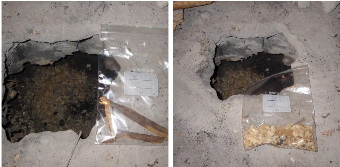
Kuva 52. Yläpohjan materiaalinäytteet otettiin yläpohjan vesivuoto-kohtaan tehdystä rakenneavauksesta RAK18. Näyte 7 otettiin yläpohjan muottilaudoituksesta, ja näyte 8 otettiin yläpohjan eristeenä käytetystä kutterinlastusta. Molemmista näytteistä todettiin selvää mikrobikasvua materiaalissa. Yläpohjasta otettiin lisäksi vertailunäyte (näyte 9) eristeenä käytetystä kutterinlastusta. Vertailunäytteessä todettiin epäily mikrobikasvusta materiaalissa. Rakenneavauksista ei havaittu mikrobiperäistä tai muuten poikkeavaa hajua.
