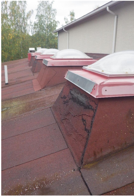
Kuva 48. Ruokalan ja aulan yläpuolella sijaitsevien kattoikkunoiden bitumikermässä havaittiin voimakasta valumaa eteläpuolella. Ylösnostoja ei ole pellitetty.
