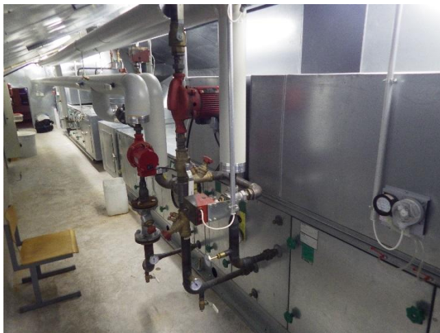
Kuva 66. Yleiskuva tulo- ja poistoilmakoneesta TK21.
