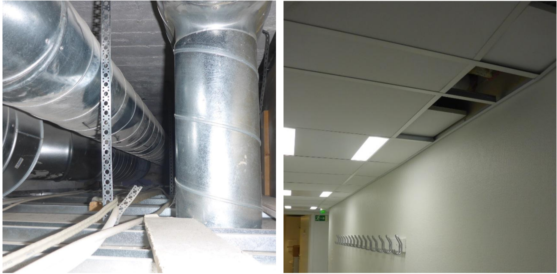
Kuva 28. Käytävätiloissa on alas laskettu katto. Alakaton yläpuolella on melko paljon pölyä.
