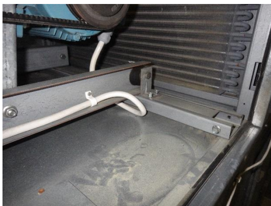
Kuva 65. Puhallinkammio on hyvin likainen. Puhaltimen hihnat olivat melko kireällä.
