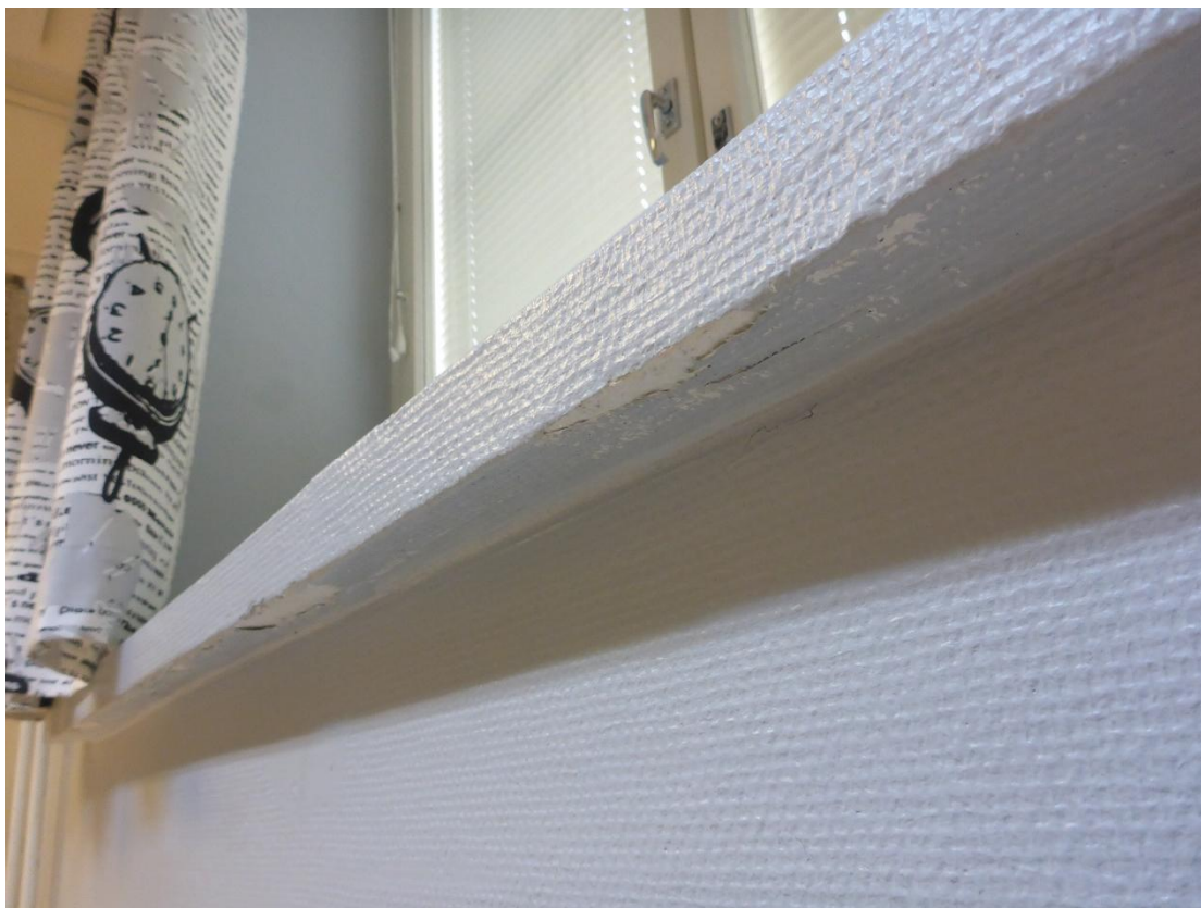
Kuva 36. Alkuperäisellä osalla pohjakerroksessa sijaitsevan tilan IP/AP ikkunapenkien alapinnan tapetti ja maali hilseilevät. Ikkunapenkissä ei havaittu kohonneita pintakosteuslukemia.
