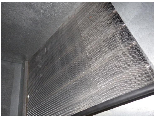
Kuva 78. Lämmityspatteri on melko puhdas ja hyväkuntoinen.
