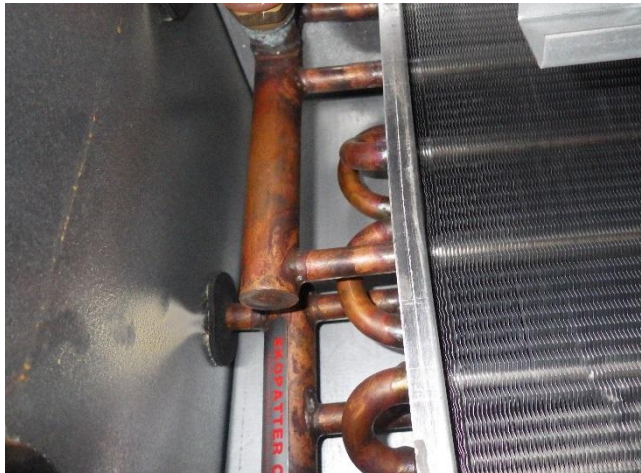
Kuva 79. Patterin läpivienti on epätiivis ja siitä pääsee puupölyä koneen sisälle.
