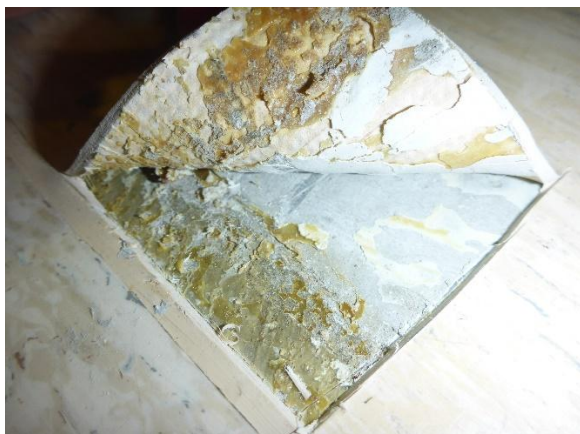
Kuva 21. V4, tila 161 (Ruokala). Viiltomittauksen tulos 69,3 %RH. Maton tartunta heikko, ei poikkeavaa hajua, murtopinta liimassa ja tasoitteessa.
