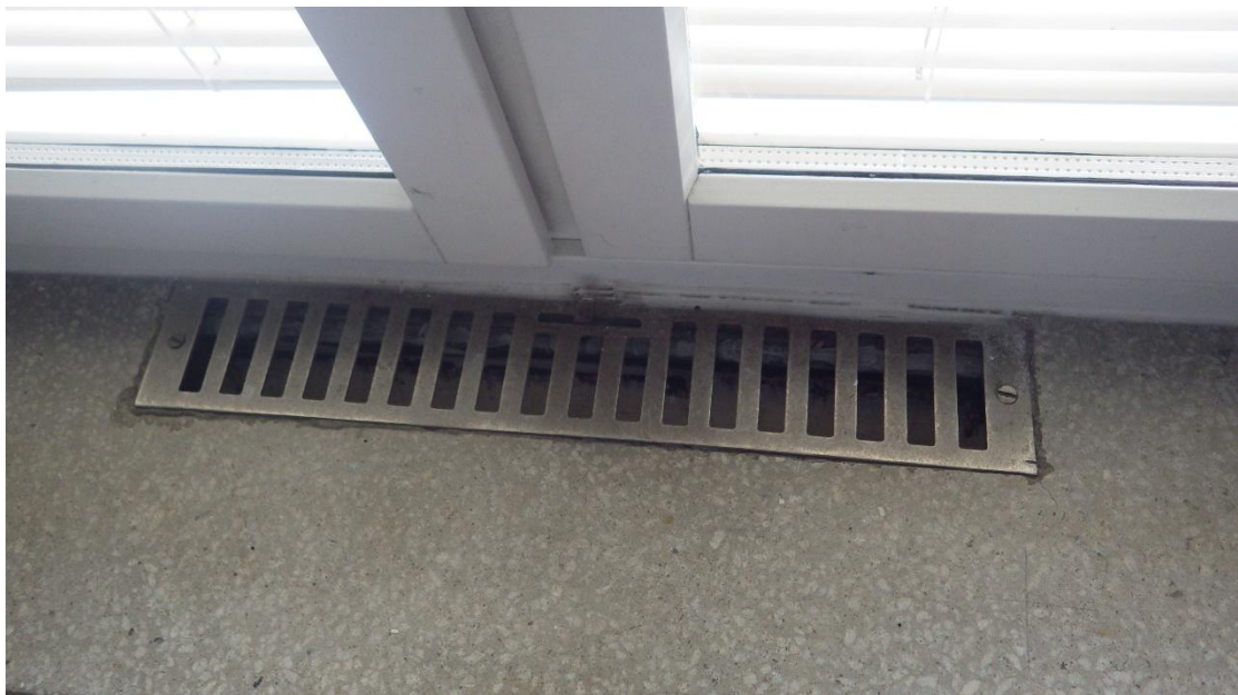
Kuva 35. Alkuperäisellä osalla on aiemmin ollut ikkunoiden alapuolella korvausilma-aukot, joista tuleva ilma on ohjattu ikkunapenkin yläpuolelle. Korvausilma-aukot on ummistettu, mutta osa läpivienneistä on epätiivittä.
