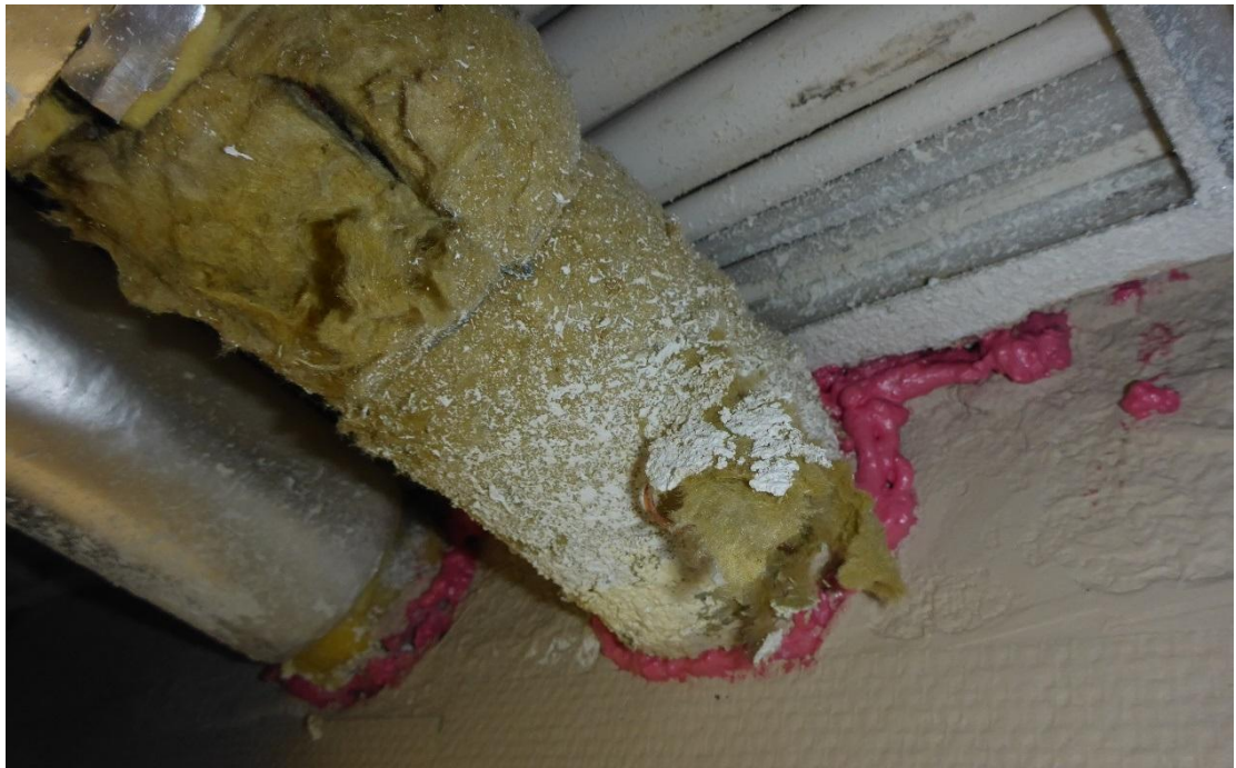
Kuva 34. Käytävän 006 alakattotilassa havaittiin epätiivittä läpivientejä lämmönjakohuoneeseen sekä avoimia mineraalivillapintoja. Käytävätiloissa havaittiin poikkeavaa öljyyn ja maaperään viittaavaa hajua.
