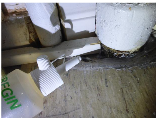
Kuva 26. Alkuperäisen osan välipohjassa havaittiin useita epätiiviitä läpivientejä. Ilmavirtauksen suunta läpivienneissä vaihteli tutkimushetkellä.
