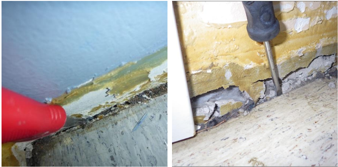
Kuva 11. Liikuntasaliin käytävälle (tila 170) ja liikuntasalin voimisteluvälinevarastoon (tila 177) tehdyissä rakenneavauksissa havaittiin selvä rako lattia-seinäliittymässä. Rakoista ei havaittu poikkeavaa hajua eikä merkittävää ilmavirtausta tutkimushetkellä.
