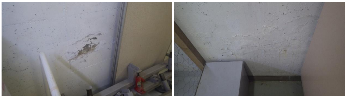
Kuva 6. Väestönsuojan maanvastaisissa seinissä havaittiin suolakertymiä, jotka viittaavat korkeaan kosteusrasitukseen.
