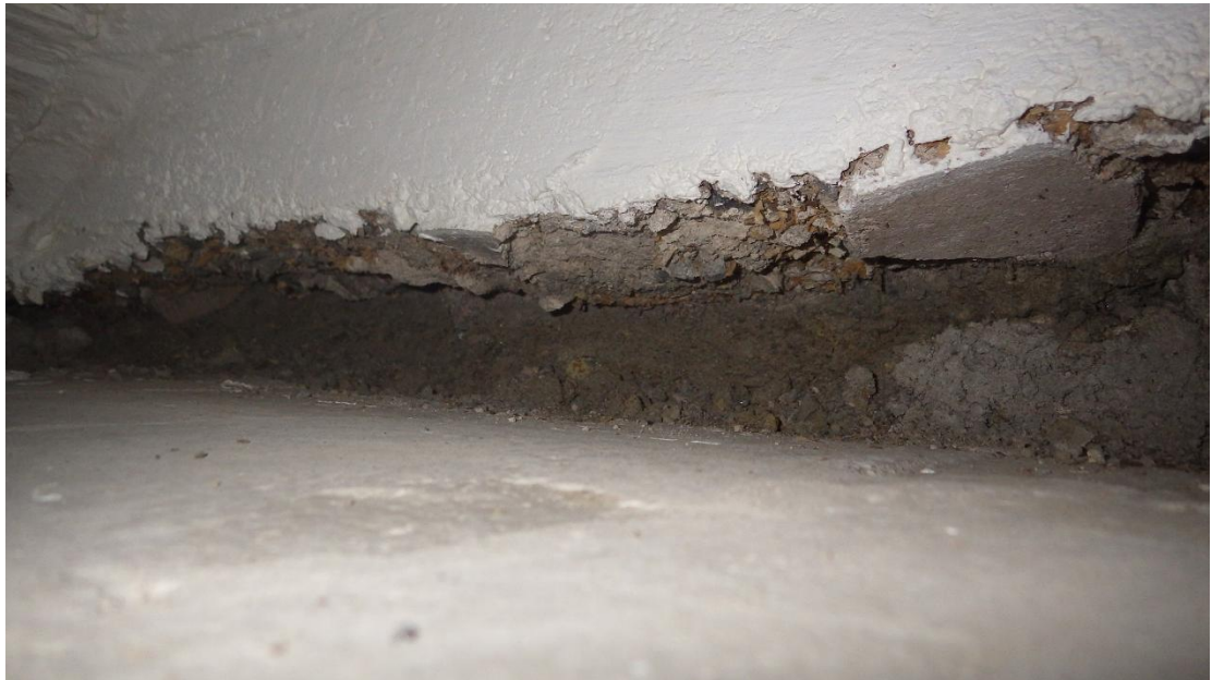
Kuva 9. Luokkasiiven portaiden alustilassa (tila 003) havaittiin seinä-lattialiittymässä noin 20 mm leveä rako maaperään.
