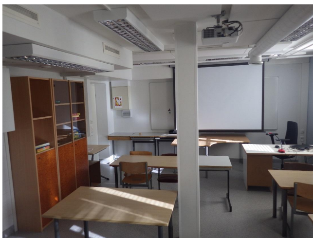
Kuva 86. Ilmanjakotapa opetustilassa 013. Tilaan on tuotu lisää ilmanvaihtoa jälkikäteen lisätyllä ilmanvaihtokoneella.
