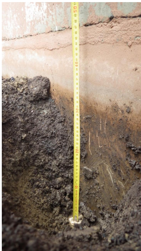
Kuva 15. Teknisen työn tilan ulkopuolelle tehdystä kaivannosta ei havaittu perusmuurissa ulkopuolista vedeneristystä. Routasuojaus havaittiin noin 300 mm maanpinnan alapuolella
