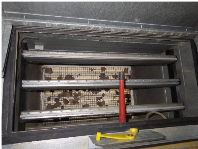
Kuva 76. Raitisilmapelti ei sulkeudu, kun kone sammutetaan. Raitisilmasäleikössä on lehtiä.
