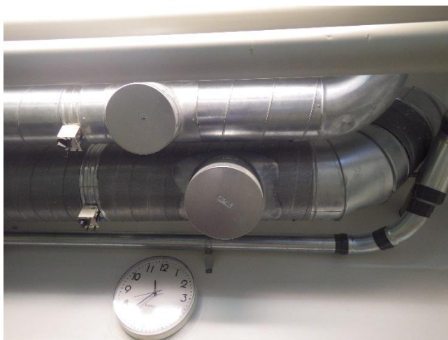
Kuva 81. Heti koneen jälkeen olevissa tuloilmakanavissa on tulpat, joita ei ole kiinnitetty ruuvaamalla tai niittaamalla.
