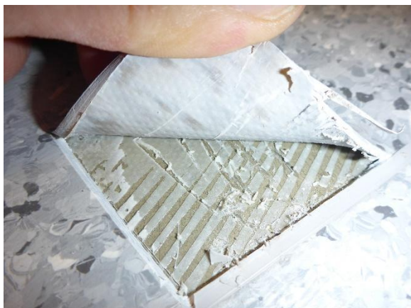
Kuva 22. V5, tila 004 (PULUKI/OT). Viiltomittauksen tulos 66,7 %RH. Maton tartunta- hyvä, ei poikkeavaa hajua, murtopinta liimassa.
