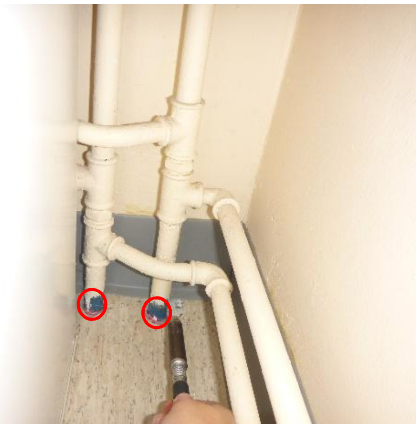
Kuva 30. Merkkiainekokeessa MA-K6 havaittiin ilmavuotoa huonetilaan nurkassa sijaitsevien patteriputkien läpivientien kautta. Vuotokohdat on merkitty kuvaan punaisella.
