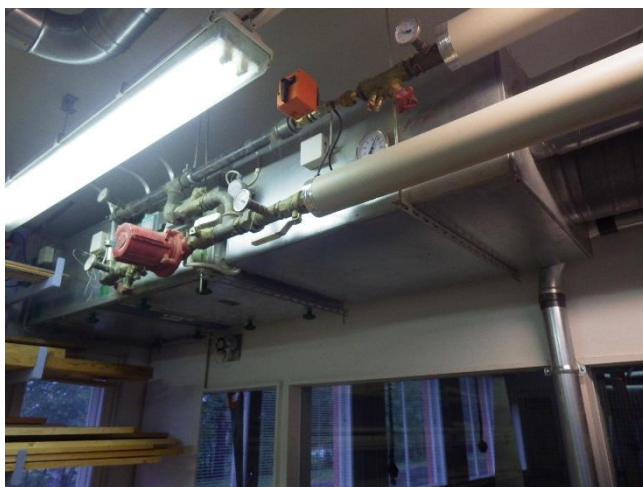
Kuva 75. Yleiskuva tuloilmakoneesta TK22. Kone on sijoitettu teknisen työn tilan kattoon. Tuloilmakammioon ei ole puhdistusluukkua.
