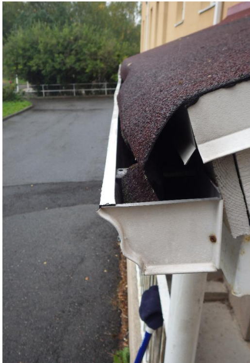
Kuva 44. Ulkovälinevarastojen katoksen pintakermiä ei ole leikattu oikeaan mittaan. Kermi ohjaa kattovedet osittain räystääkourun ohi.
