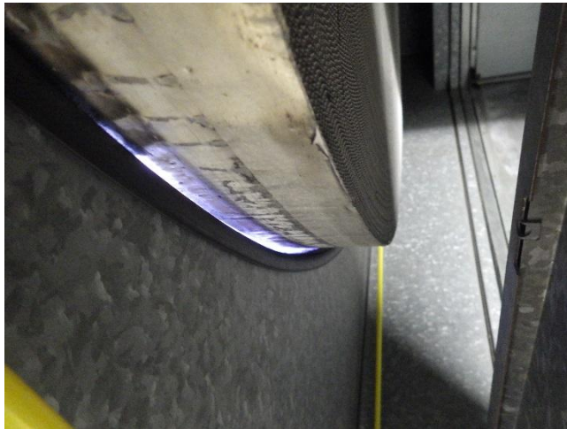
Kuva 57. LTO-kiekon harjatiiviste on kulunut ja epätiivis.
