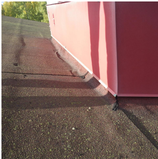
Kuva 40. Liikuntasaliin huippumurien läpiviennissä havaittiin vesivuotojälkiä sisäpuolelta tarkasteltuna. Vuotopaikka ei selvinnyt pintapuolisella tarkastelulla.
