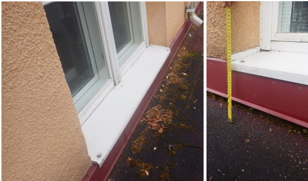
Kuva 47. Alkuperäisen osan 1. kerroksen ikkunat ovat lähellä laajennusosan kattopintaa ja ikkunapellin kallistus on loiva.
