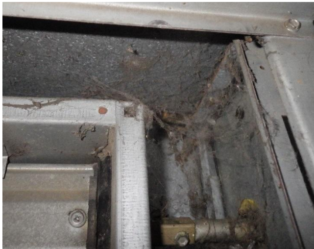
Kuva 68. Raitisilmapelti ennen suodattimia on hyvin likainen.
