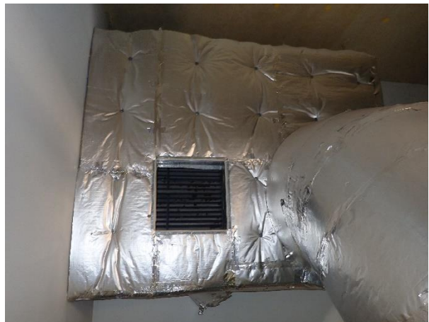
Kuva 40. Ulkoilmakammio on eristetty
