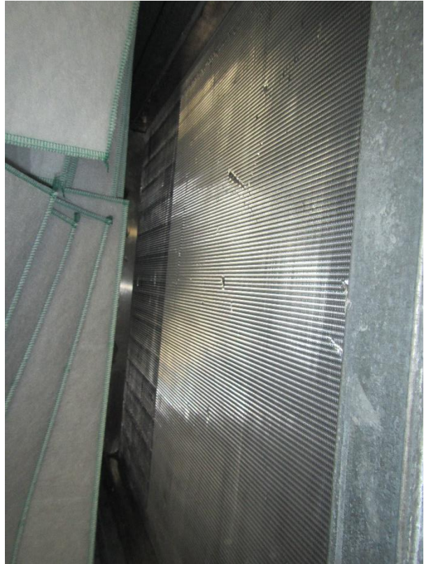
Kuva 34 Lämmityspatterin ja lämmöntalteenottopattereiden otsapinnat ovat puhtaita
