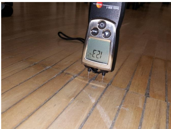
Kuva 24: Luokkatilan 3 parkettilattian puukosteus lievästi koholla kosteusjäljen kohdalla.
