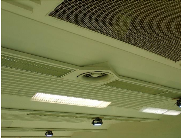
Kuva 50 Liikuntahallin tuloilman päätelaite
