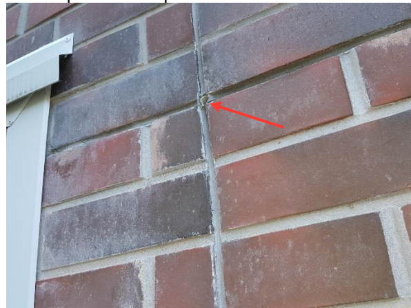
Kuva 11: Elementin tuuletusputket paikoitellen liian lyhyet, päättyvät elementin pintaan.
