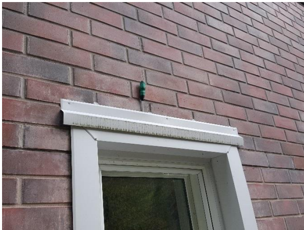
Kuva 10: Ikkunoiden vesipeltien tiiveyksissä havaittiin paikoitellen puutteita.
