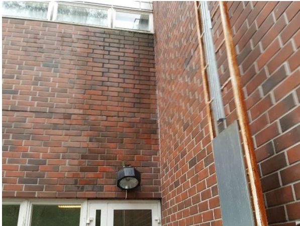
Kuva 14: Sateisena päivänä rakennuksen julkisivussa havaittavissa kosteusjälkiä
