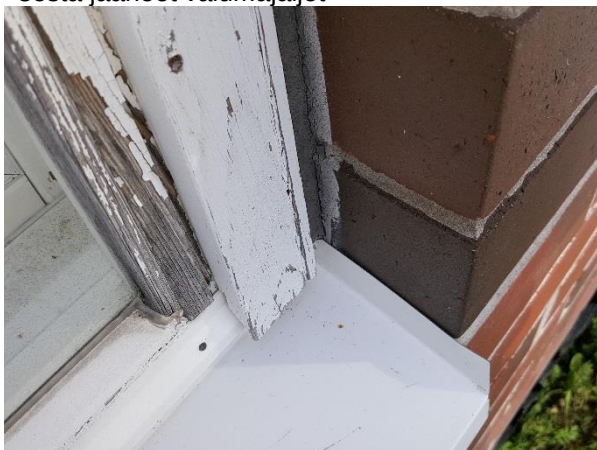
Kuva 18: Ikkunoiden ulkopuitteet ovat paikoitellen huonokuntoiset
