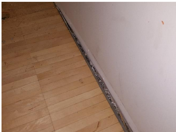
Kuva 29. Liitosta ei ole tiivistetty
