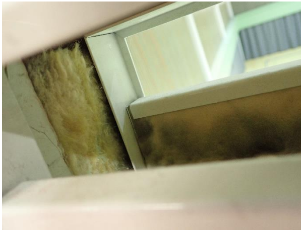
Kuva 52 Siirtoilmalaitteet liikuntahallin ja juoksuradan välillä. Siirtoilmalaitteiden välissä on näkyvissä avointa villapintaa
