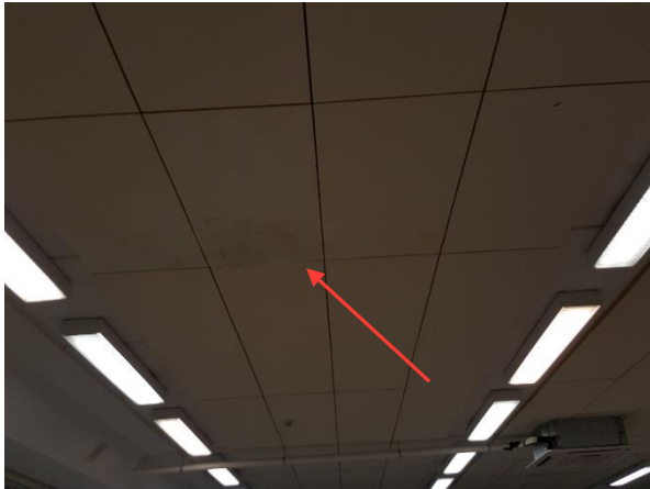
Kuva 20: Kuntosalin sisäkatossa kosteusjälki.
