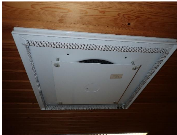
Kuva 49. Tuloilman kattohajotin pukuhuoneessa
