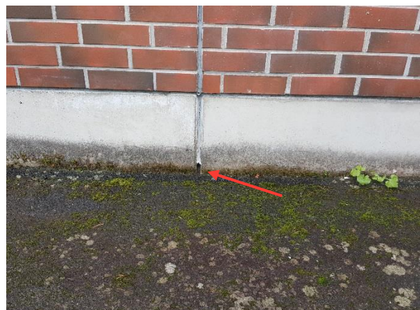
Kuva 7: Elementtisaumojia ei ole asennettu maanpinnan alapuolelle.
