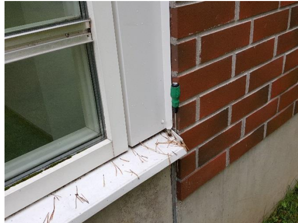
Kuva 9: Ikkunoiden vesipeltien tiiveyksissä havaittiin paikoitellen puutteita.
