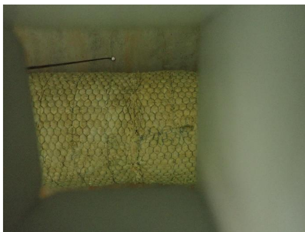
Kuva 44 Tuloilmakanavat ovat osittain eristettyjä metalliverkolla ja mineraalivillalla
