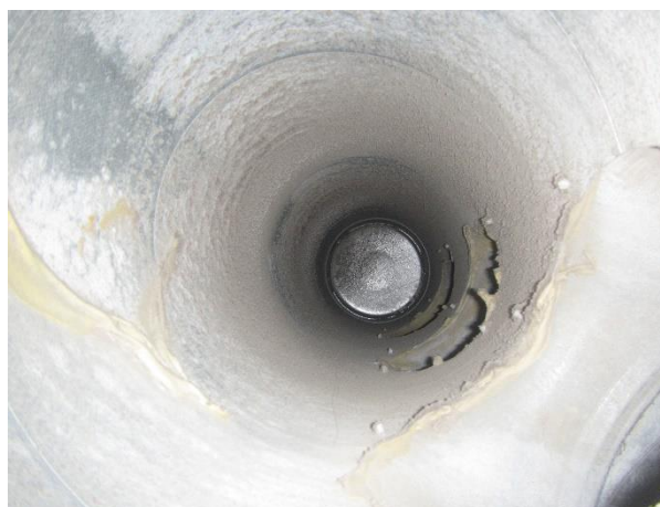
Kuva 47 Poistoilmakanavat ovat pölyisiä
