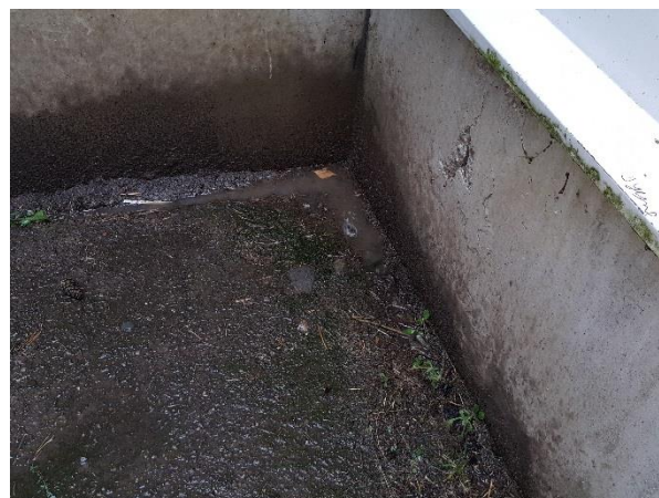
Kuva 13: Sateisena päivänä vesi makaa paikoitellen sokkelirakenteen vieressä
