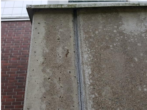
Kuva 8: Elementtisaumat ovat haurastuneet
