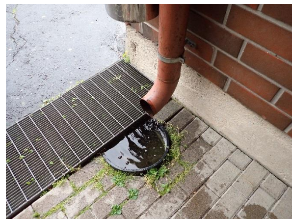
Kuva 4: Pääsisäänkäynnin vieressä oleva syöksykaivo ei vedä.
