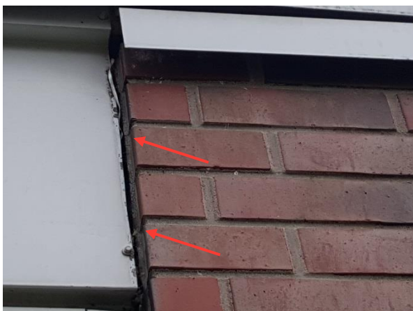
Kuva 6: Tiili- ja peltirakenteisen ulkoseinän liitos ei ole vesitiivis.
