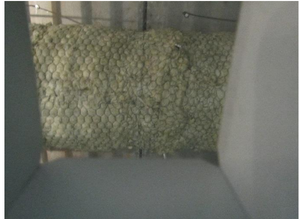
Kuva 21: Tekniikkatilassa ilmanvaihtokanavien ympärillä pinnoittamattomia villaeristeitä.
