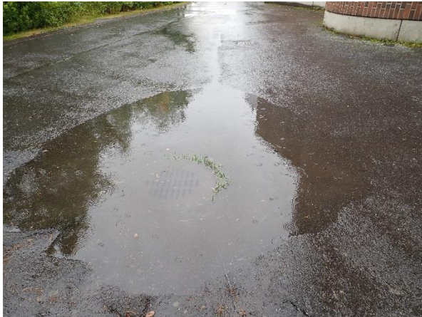
Kuva 5: Rakennuksen takana oleva pihakaivo ei vedä
