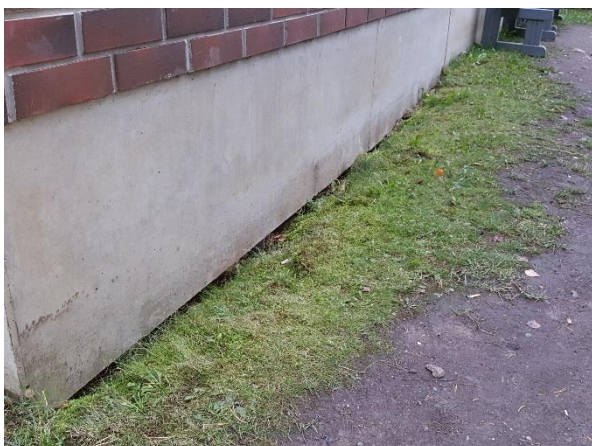
Kuva 3: Rakennuksen sokkelirakenteen läheisyydessä maanpinta on painunut.
