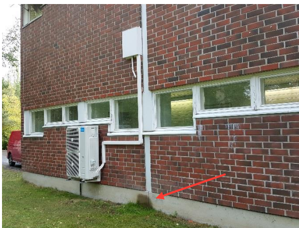
Kuva 12: Jäähdytyslaitteen sisäyksikön viemäröinti kastelee kiinteistön sokkelirakennetta.
