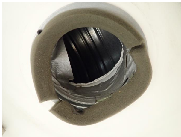
Kuva 42. Päätelaitteen haarakanavan liitos runkokanavaan on tiivistetty sisäpuolelta ilmastointiteipillä
