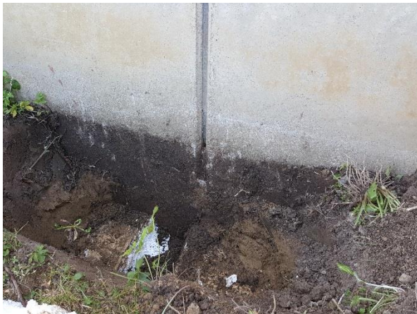
Kuva 1: Rakennuksen etuosalla on routaeristys.
