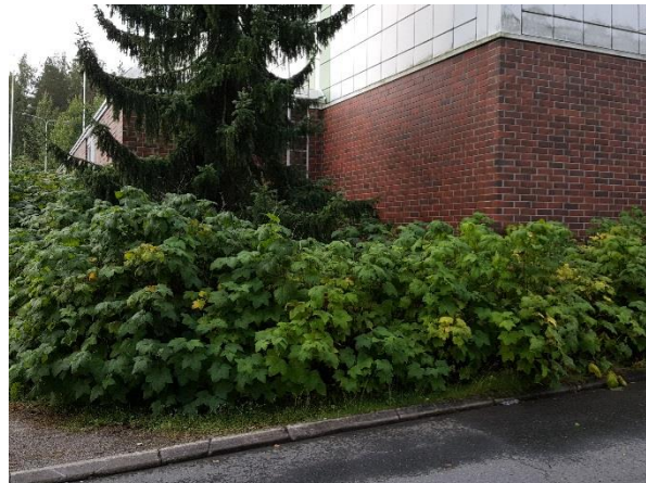
Kuva 2: Rakennuksen etuosalla paikoitellen runsaasti kasvillisuutta
