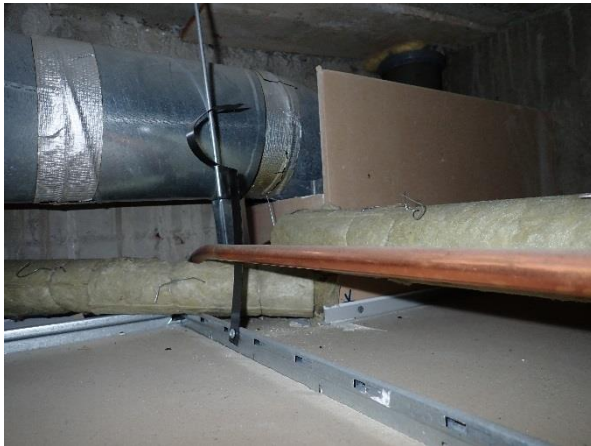
Kuva 22: Tekniikkatilassa pinnoittamattomia villaeristeitä.
