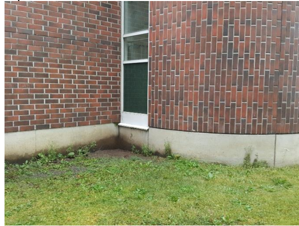
Kuva 17: Sateisena päivänä rakennuksen sokkelin rakenteessa kosteusjälkiä
