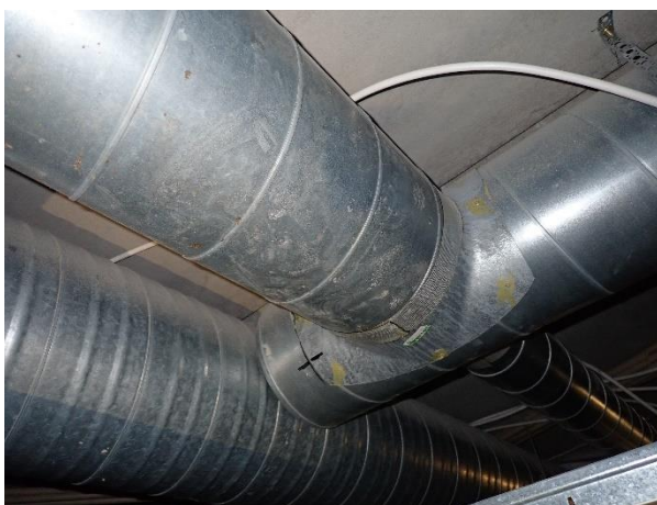
Kuva 43 Kanava-asennuksia alaslaskutilassa, kuvassa puhdistusluukku vasten toista kanavaa
