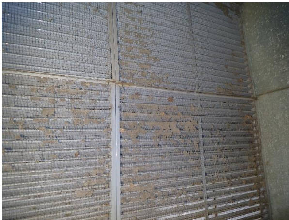
Kuva 39. Ulkoilmasäleikössä on lehtiä/roskaa
