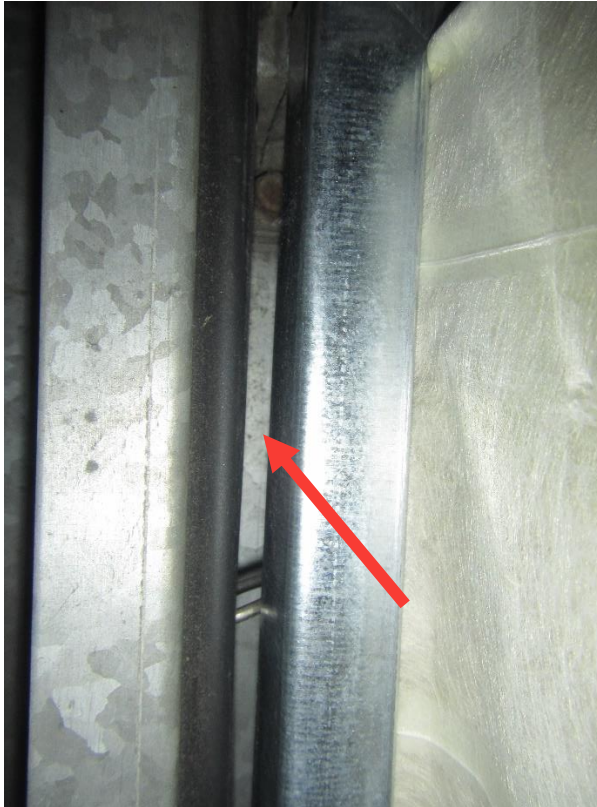
Kuva 33 Tuloilman suodatinasennukset ovat väljiä ja ohivirtauksia muodostuu
