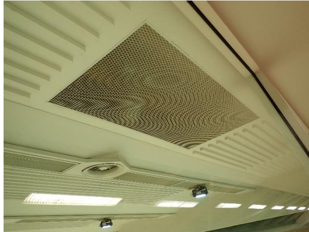
Kuva 51 Liikuntahallin poistoilmasäleikkö sijaitsee ritilän takana, jossa se poistaa ilmaa myös alaslaskutilasta, joka ei ole tarkoituksenmukaista
