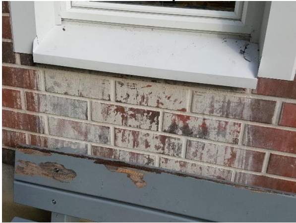
Kuva 16: Ulkoseinän ikkuna-aukkojen toteutuksesta jääneet valumajäljet
