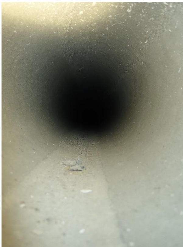
Kuva 45. Tuloilmakanavana käytetty ontelolaatta on pölyinen ja pohjalla on karkeaa likaa
