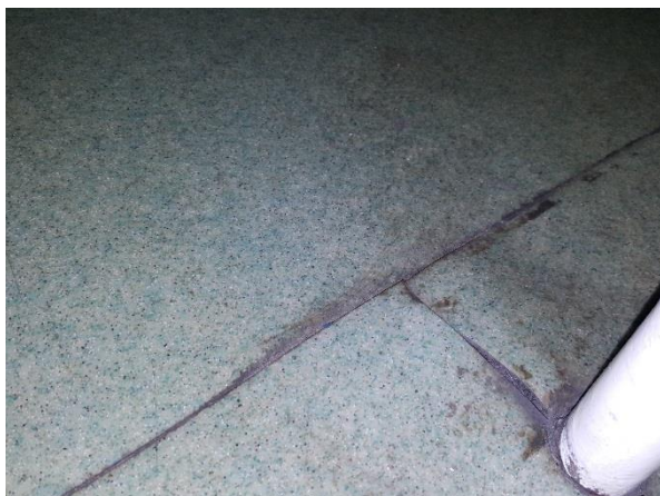
Kuva 26: Alkuperäisten lattiapinnoitteiden saumoissa epätiiveyksiä.
