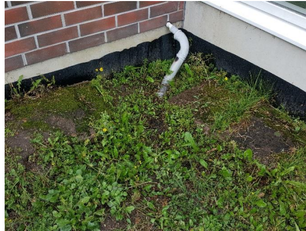
Kuva 15: Ulkoseinärakenteessa tiivistämätön läpivienti
