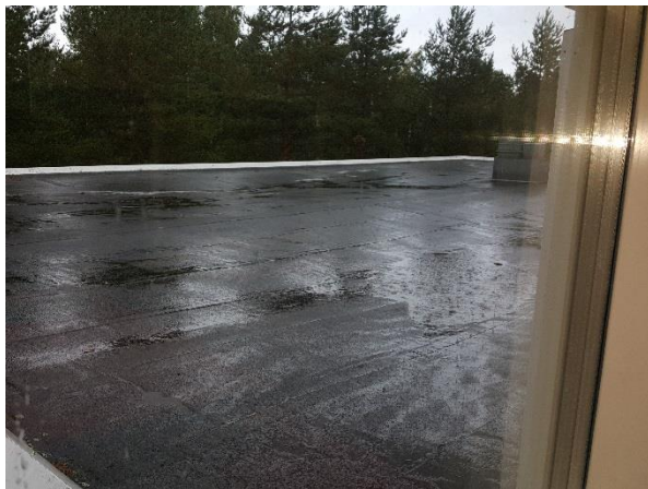
Kuva 19: Kiinteistön vesikaton kattokaivo vetää heikosti.
