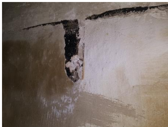
Kuva 37. Putkikanaalin kivijalan rappauksen takana oleva bitumisively.
