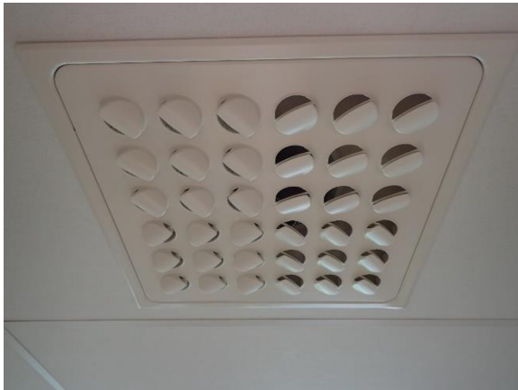
Kuva 69. Yleiskuva tuloilmalaitteesta luokkatiloissa.
