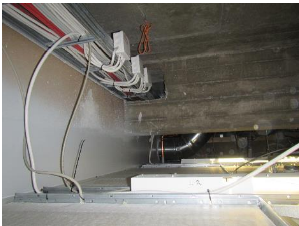
Kuva 27. Alaslaskettujen kattojen tekniikkatilat ovat siistit.
