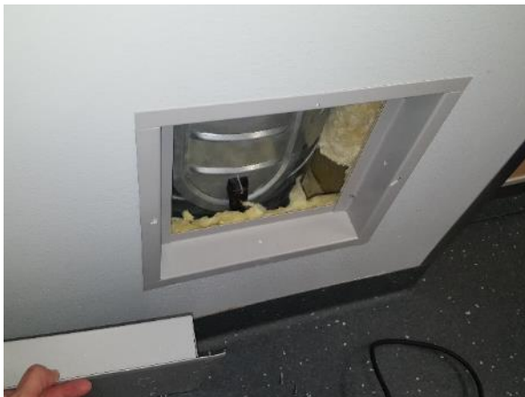
Kuva 31. Koteloiden tarkastusluukuista ja kansista puuttuu tiivisteet.
