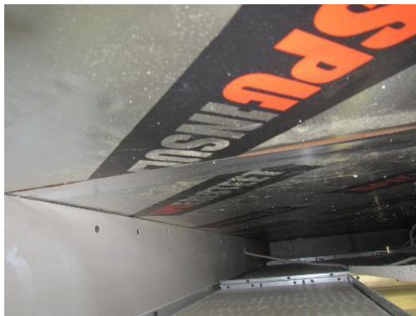
Kuva 28. Kova eriste alaslasketun katon yläpuolella.
