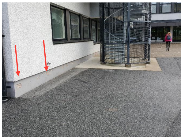
Kuva 26. Sokkelin maalipinnoitteessa havaittiin irtoilua ja kulumista.
