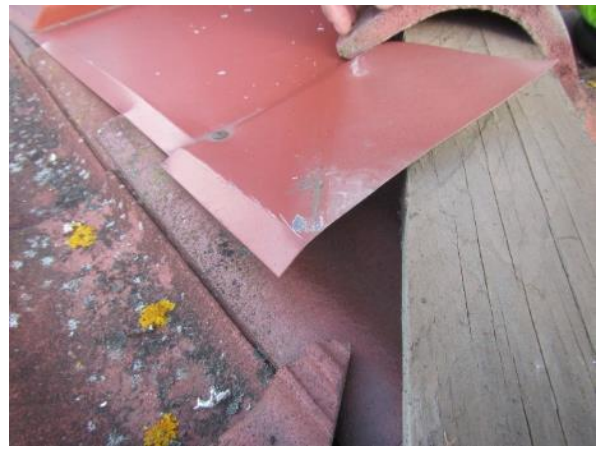
Kuva 16. Pellitykset ovat osittain epätiivitä.
