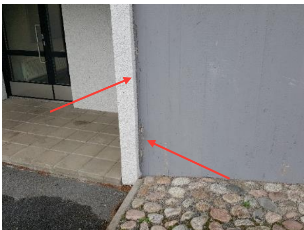
Kuva 25. Kiinteistön sokkelirakenteessa on paikoitellen pystysuunnan halkeamia.
