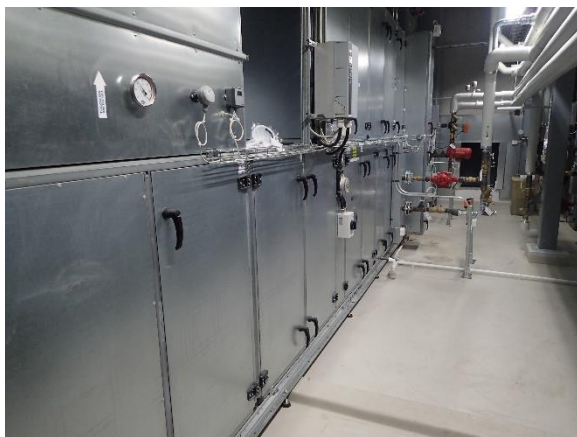
Kuva 44. Yleiskuva, koneet TK02 ja TK03 (IVKH 417)
