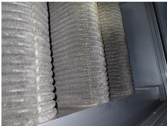
Kuva 57. TK02 neulaputket ovat puhdistamisen tarpeessa.
