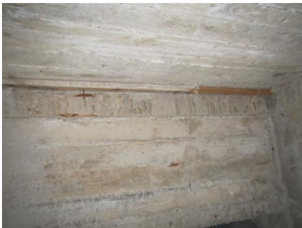
Kuva 7. Ryömintätilaan jäänyt muottilaudan rippeitä.
