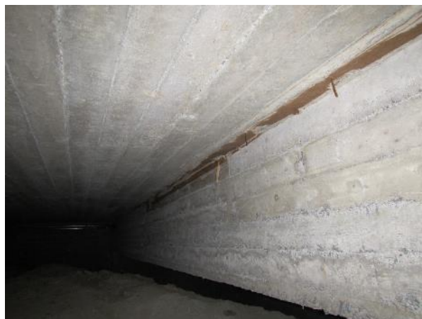
Kuva 10. Muottilaudan rippeitä betonirakenteiden pinnassa.
