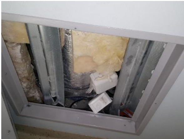
Kuva 29. Tekniikkakoteloiden sisäpuolella on paikoitellen pinnoittamattomia villaeristeitä.
