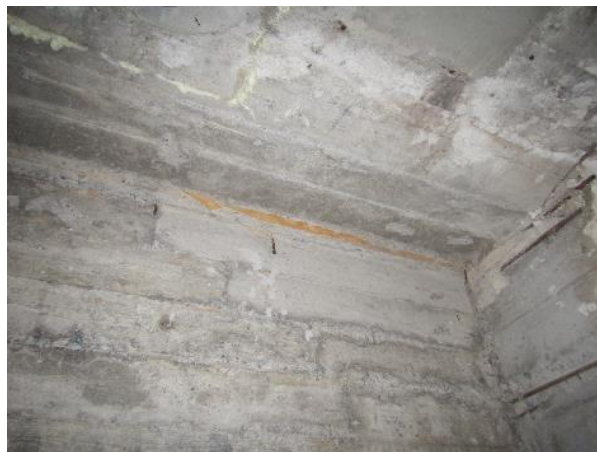
Kuva 8. Raudoitusteräket paikoitellen ruostuneet.
