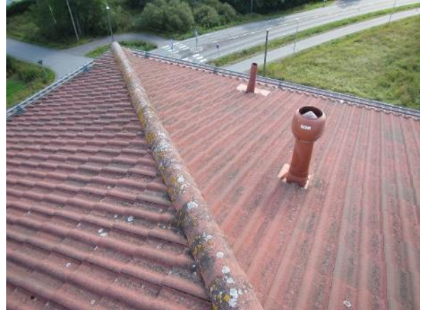
Kuva 14. Tiilikatteessa on paikoitellen jäkälää.
