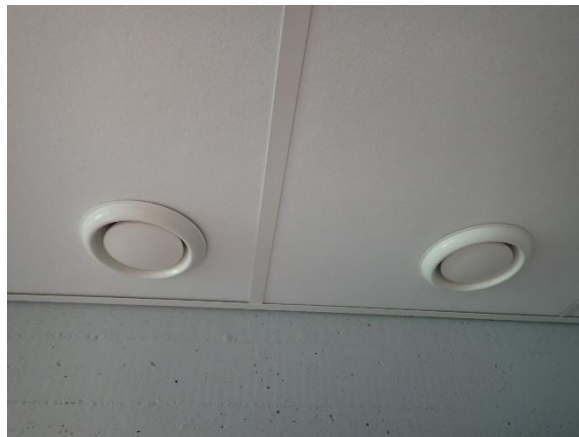
Kuva 72. Yleiskuva luokka- ja toimistotiloissa olevista poistoilmalaitteista.
