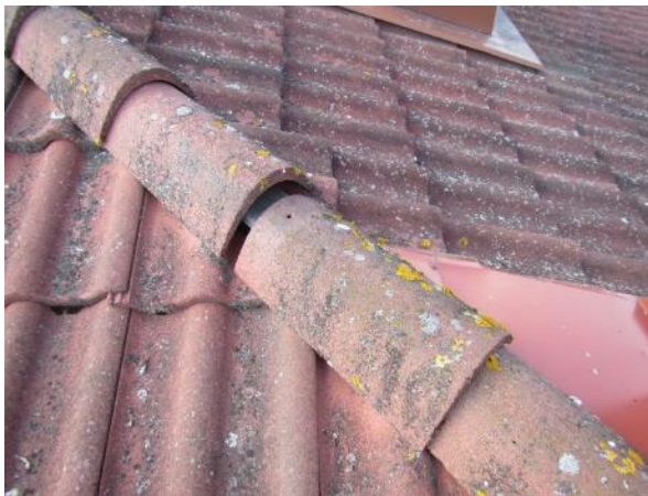
Kuva 15. Harjalimitys on epätiivis.
