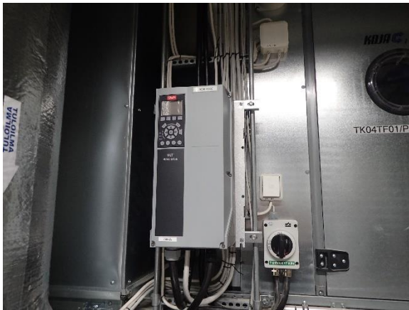
Kuva 52. Yleiskuva taajuusmuuttajasta kiinteistössä.
