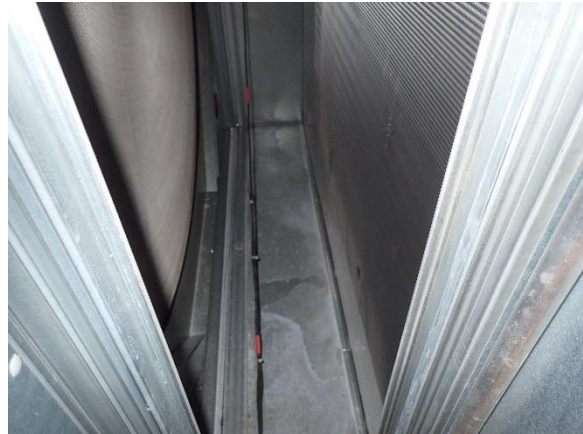
Kuva 61. LTO-kiekon ja lämmityspatterin pinnat olivat järjestäen puhtaat.
