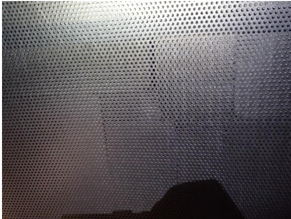
Kuva 54. Tuloilmakammion (TK01) äänenvaimennuskapseloinnin yleiskuva.
