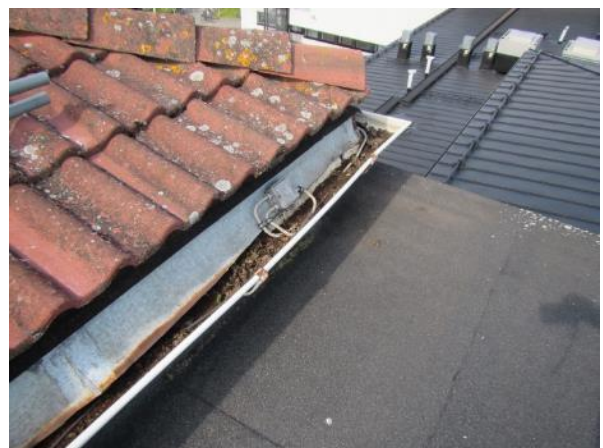
Kuva 18. Räystäskourut ovat osin irronneet kannakkeista. Räystäskouruissa on roskaa.
