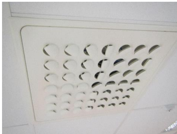
Kuva 6 Opettajienhuoneessa käytetyt tuloilman päätelaitteet
