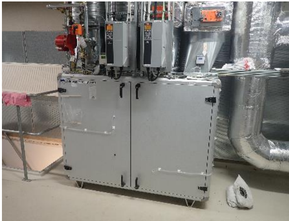
Kuva 3. Hallintosiipeä ja samalla opettajien taukotilaa palveleva ilmanvaihtokone TK05
