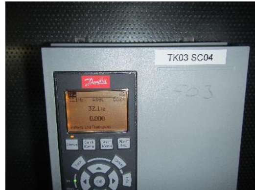
Kuva 11. Näkymä erillisen poistopuhaltimen TK03PF03 taajuusmuuttajan näytöstä.
