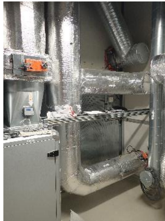
Kuva 4. Tuloilman runkokanavat ovat eristettyjä
