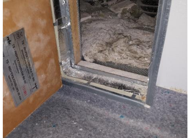
Kuva 30. Koteloiden sisäpuolella on paikoitellen runsaasti irtopölyä ja -likaa.
