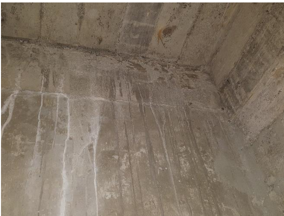
Kuva 46. Kuvassa ryömintätilan seinän ja liikuntasalin lattian liitos
