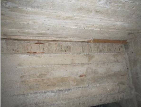
Kuva 7. Ryömintätilaan jäänyt muottilaudan rippeitä.
