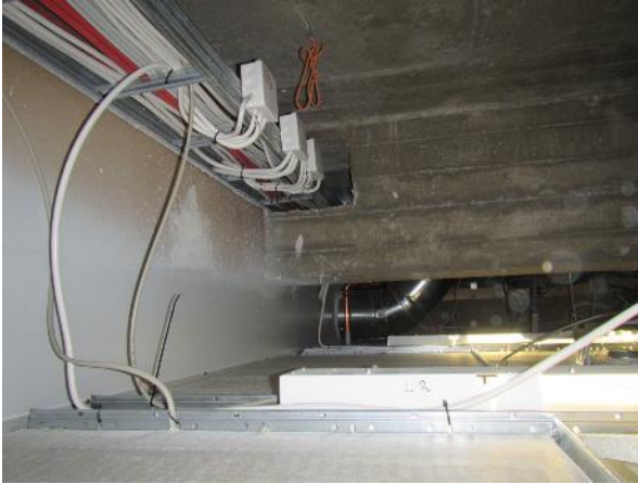
Kuva 27. Alaslaskettujen kattojen tekniikkatilat ovat siistit.
