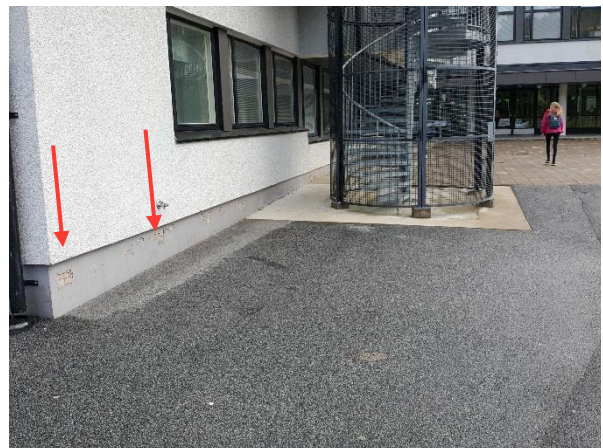
Kuva 26. Sokkelin maalipinnoitteessa havaittiin irtoilua ja kulumista.
