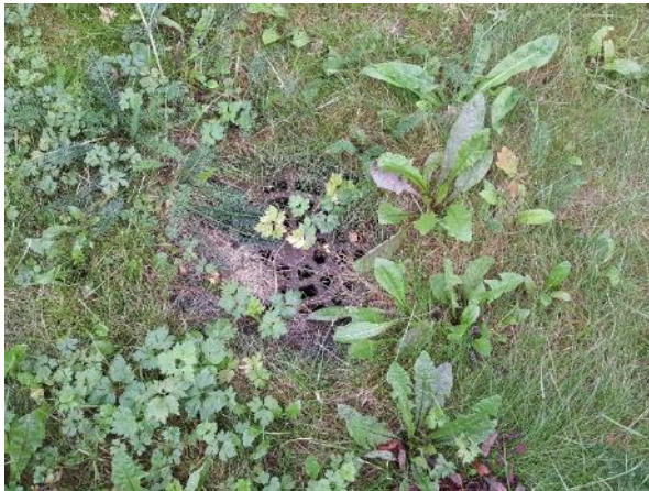
Kuva 3. Rakennuksen etuosan nurmialueella oleva pihakaivo on osittain peittynyt kasvillisuudesta.
