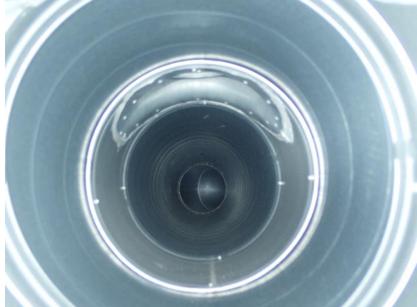
Kuva 63. Tarkennuskuva tuloilmakanavasta tilassa 255.
