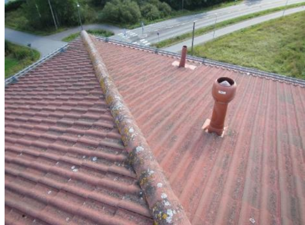
Kuva 14. Tiilikatteessa on paikoitellen jäkälää.
