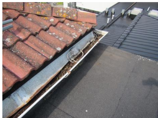
Kuva 18. Rästaskourut ovat osin irronneet kannakkeista. Rästaskouruissa on roskaa.
