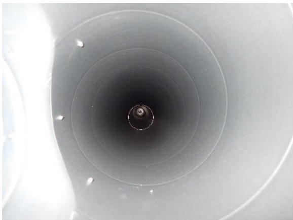
Kuva 66. Poistoilmakanavassa (tila 145) pölyisyyttä havaittavissa.
