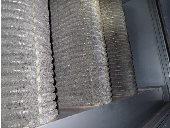
Kuva 57. TK02 neulaputket ovat puhdistamisen tarpeessa.
