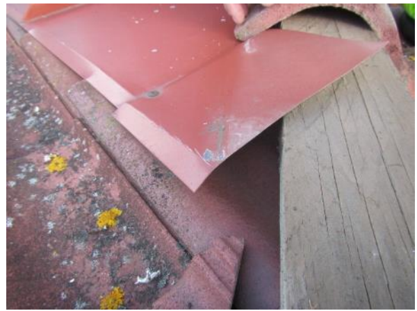
Kuva 16. Pellitykset ovat osittain epätiivitä.
