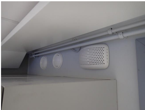
Kuva 71. Toimistotilojen tulo- ja poistoilmalaitteita.
