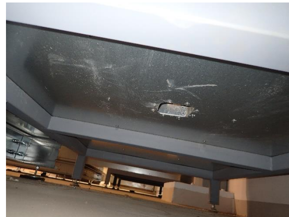
Kuva 49. Yleiskuva raitisilmakammion alaosan pohjasta. Viemäröintiä ei ole toteutettu putkittamalla, vaan vedet valuvat suoraan lattialle jonka kaadoista ei ole varmuutta.
