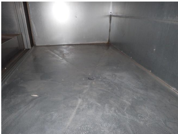
Kuva 48. Yleiskuva raitisilmakammion alaosasta. Havaittavissa pölyisyyttä, sekä viemäröintiliitin, johon ei ole liitetty putkittamalla.
