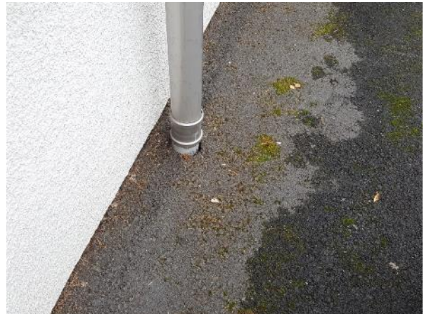
Kuva 4. Ryömintätilan tuuletusputken ja etupihan asfaltoinnin liitos ei ole vesitiivis.
