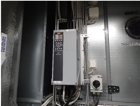
Kuva 52. Yleiskuva taajuusmuuttajasta kiinteistössä.
