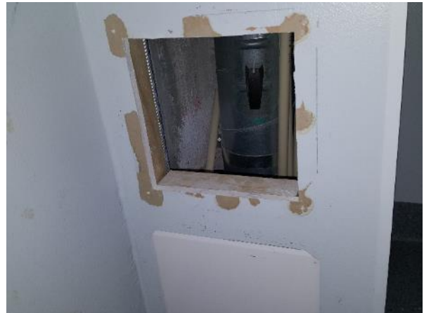
Kuva 32. Opetustilan 146 kotelon sisäpuolelta aistittavissa mikrobiperäistä hajua.
