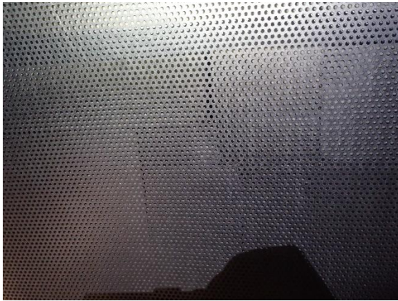
Kuva 54. Tuloilmakammion (TK01) äänenvaimennuskapseloinnin yleiskuva.
