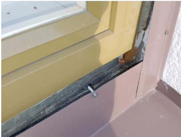
Kuva 23. 50 – luvun ikkunoiden vesipellitusten kiinnitykset ovat paikoitellen puutteelliset. Kuvassa havaittavissa alkuperäisiä harmaantuneita ikkunakarmeja.
