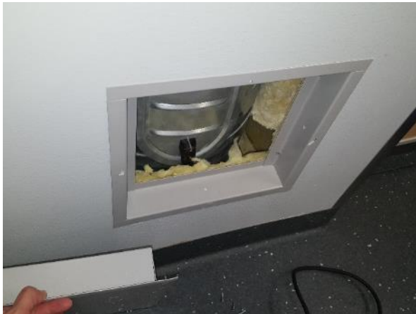
Kuva 31. Koteloiden tarkastusluukuista ja kansista puuttuu tiivisteet.
