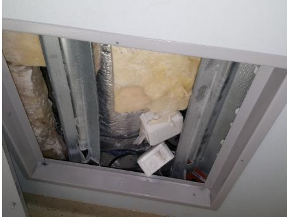
Kuva 29. Tekniikkakoteloiden sisäpuolella on paikoitellen pinnoittamattomia villaeristeitä.
