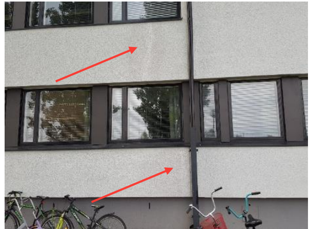
Kuva 24. Julkisivussa on paikoitellen pystysuunnan halkeamia, kuvassa halkeamia 1. ja 2.kerroksessa.
