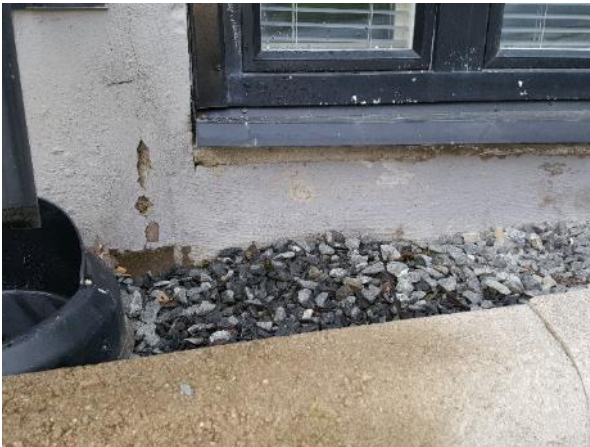
Kuva 21. Syöksyputkesta rännikaivoon tulevat vedet kastelevat viereistä sokkelirakennetta. Viereisen ikkunan vesipellin kiinnitys on puutteellinen.
