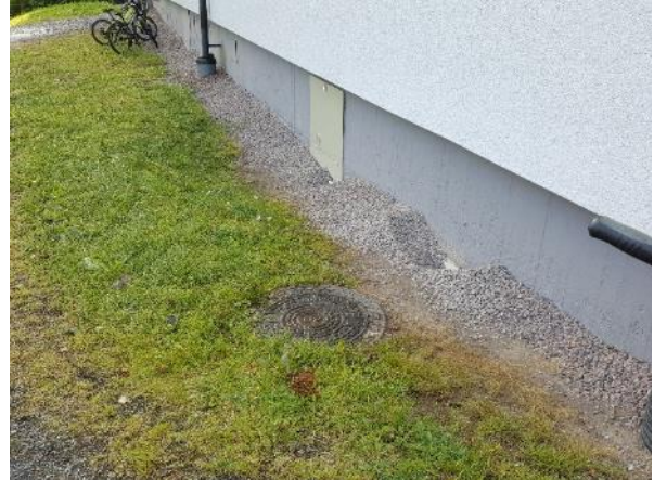
Kuva 2. Maanpinta viettää paikoitellen rakennukseen päin.
