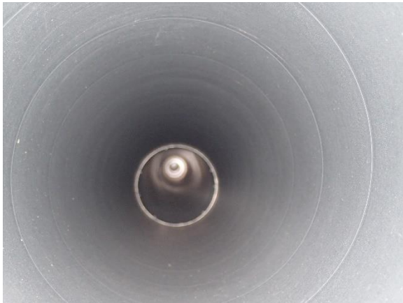
Kuva 68. Tarkennuskuva poistoilmakanavasta tilassa 145.
