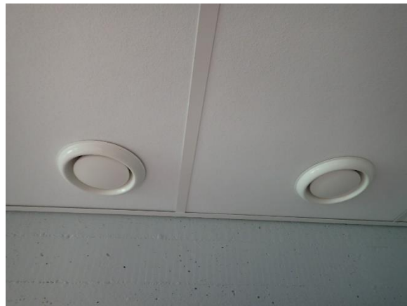
Kuva 72. Yleiskuva luokka- ja toimistotiloissa olevista poistoilmalaitteista.
