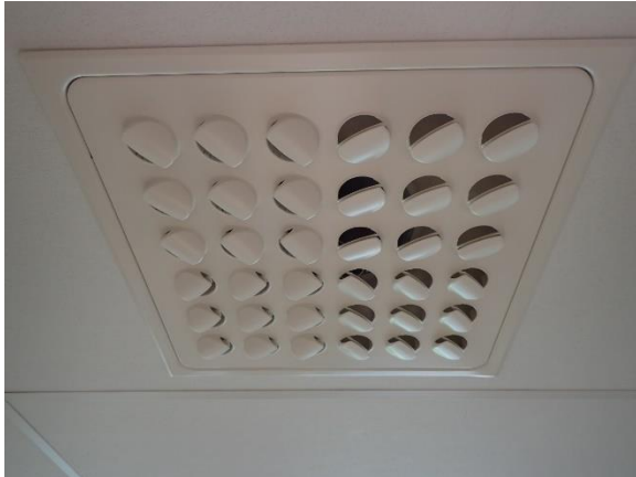
Kuva 69. Yleiskuva tuloilmalaitteesta luokkatiloissa.
