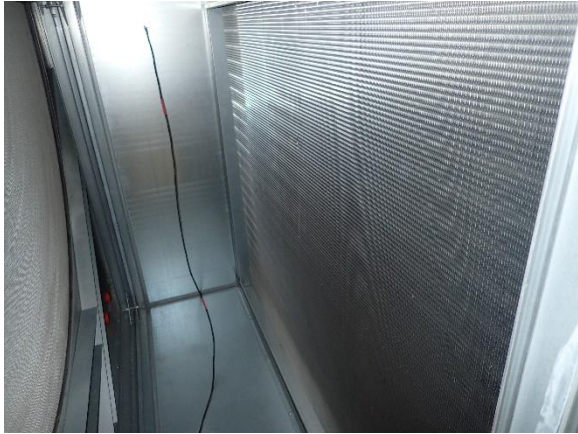
Kuva 60. Lämmityspatterin havaittiin olevan puhdas.
