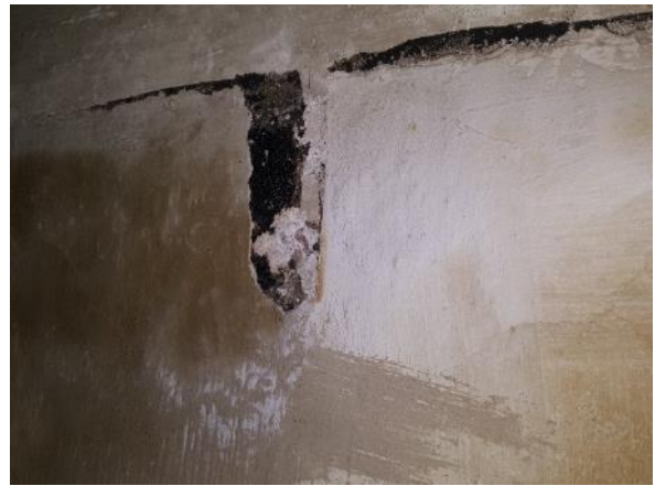
Kuva 37. Putkikanaalin kivijalan rappauksen takana oleva bitumisively.
