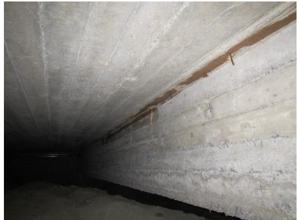
Kuva 10. Muottilaudan rippeitä betonirakenteiden pinnassa.
