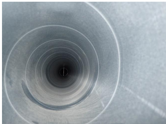
Kuva 67. Poistoilmakanavassa (tila 500) pölyisyyttä havaittavissa.
