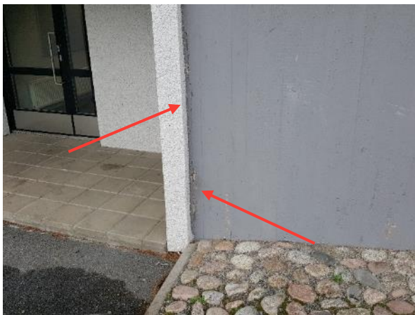
Kuva 25. Kiinteistön sokkelirakenteessa on paikoitellen pystysuunnan halkeamia.
