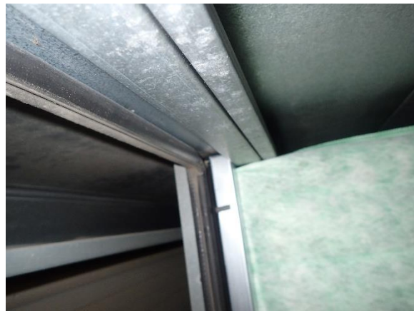
Kuva 59. Suodatinten tiivistepinnat ovat tiiviit ja puhtaat.
