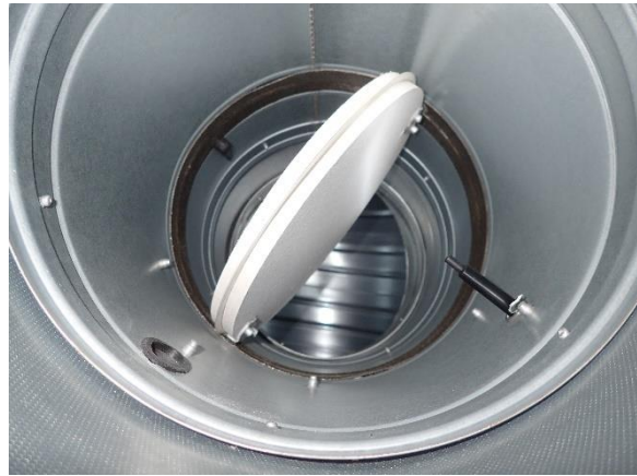
Kuva 65. Tuloilmakanava (tila 311), ei merkittävää pölykertymää. Näkyvissä myös säätöpelti.
