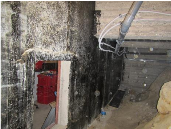
Kuva 9. Yksi seinistä päällystetty bitumilla.
