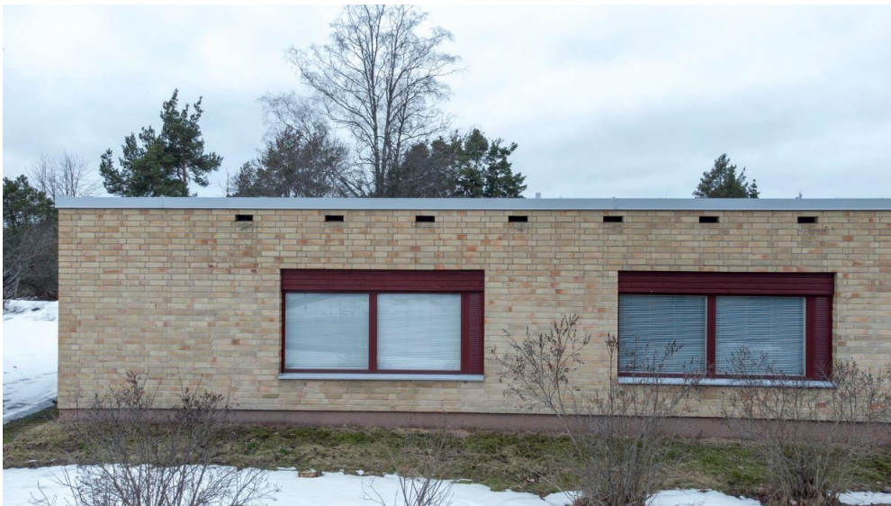
Kuva 2. Akaan Toijalan vanhan terveysaseman ilmastointitiloissa on hengittäviä aukkorakenteita katon rajassa. Kuva © Pekka Rintamäki.
