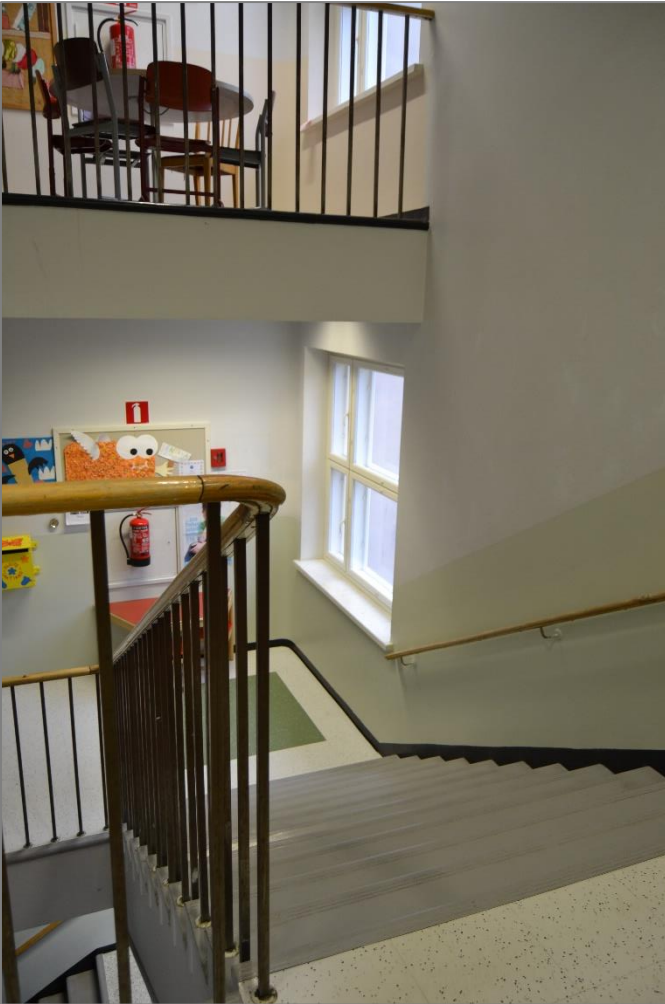
Kuva 63. Kuva A-portaikosta toisen ja kolmannen kerroksen väliä. Lepotasanteilla lattiamateriaalina on vinyylilaatta. Metallikaiteet puisine kädensijoinen ovat alkuperäiset.
