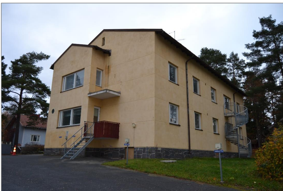
Kuva 67. Rakennus lounaiskulmalta. Kulmaparvekkeita on poistettu käytöstä.
