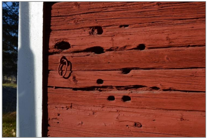
Kuva 31 (alla). Jälkiä aitan etuseinässä oven vasemmalla puolella.
