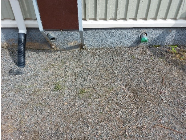
Kuvat 11. Ulkopuolella olevat kellarin kosteudenpoistolaitteen kanavat.
