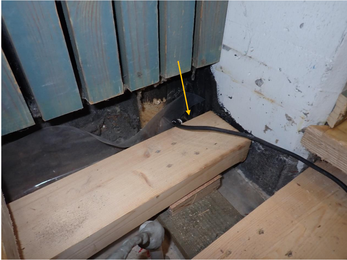
Kuva 20. Merkkiainekokeessa havaittu vuotokohta avauksessa RA3, merkattu nuolella. Pilarin ja seinän nurkassa, alapohjaliittymässä höyrynsulkumuovin takana.
