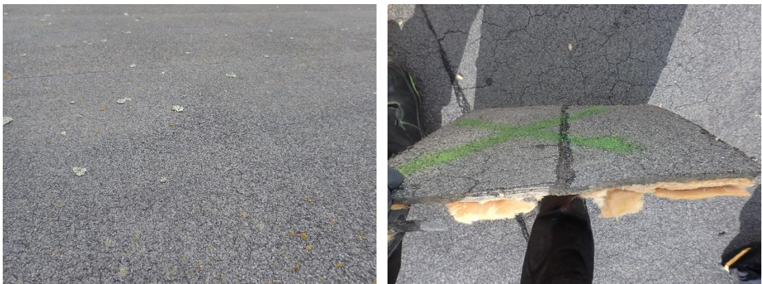
Kuvat 29 a ja b. Katteena on kaksikermikate. Pääimmäisen kermin pinnassa on lähes kauttaaltaan vähäistä halkeilua ja kulumaa. Mineraalivillaeriste on pehmeää ja kermikate joustaa selkeästi katolla liikkeessä.
