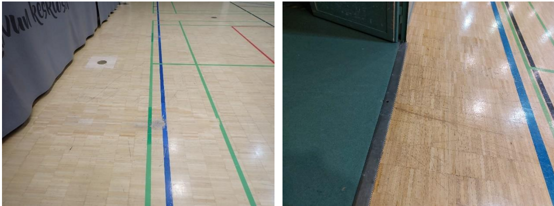
Kuvat 4 a ja b. Paikallista mekaanista kulumaa futsal-maalin alla ja maaholkin uusimisen yhteydessä asennettu uusi vaaleampi mosaiikkiparketti (kuva a). Varastoon johtavien ovien edustalla olevaa mekaanista kulumaa (kuva b).
