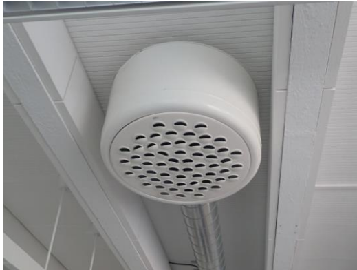
Kuva 2. kerroksen uusituista tuloilmanpäätelaitteista. Kuvan suutinhajottajassa suuttimet on suunnattu tilan ulkoseinää kohden.
