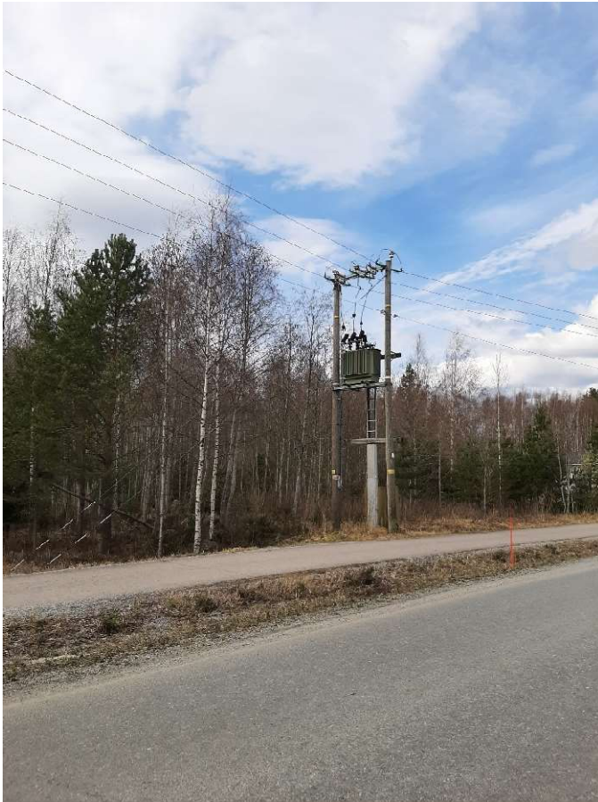
Kuva 9-5. Pylväsmuuntaja Yrittäjätien varrella.
