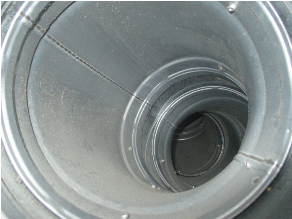
Poistoilmakanavaa (tyhjä rakennus) ennen puhdistusta
