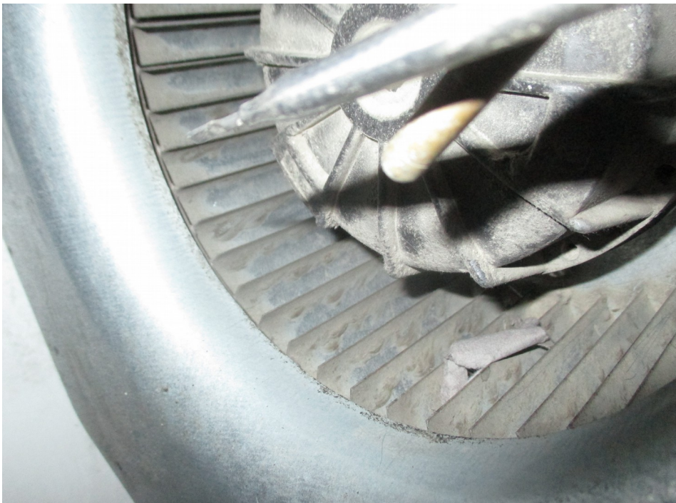
Sama paikka puhdistuksen jälkeen
