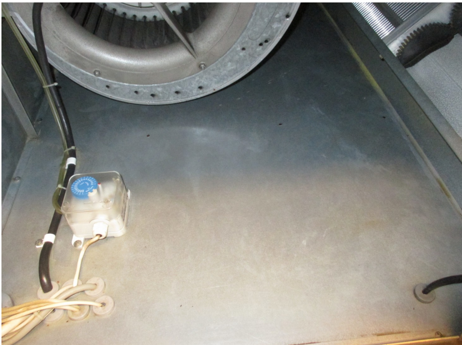
Sama paikka puhdistuksen jälkeen
