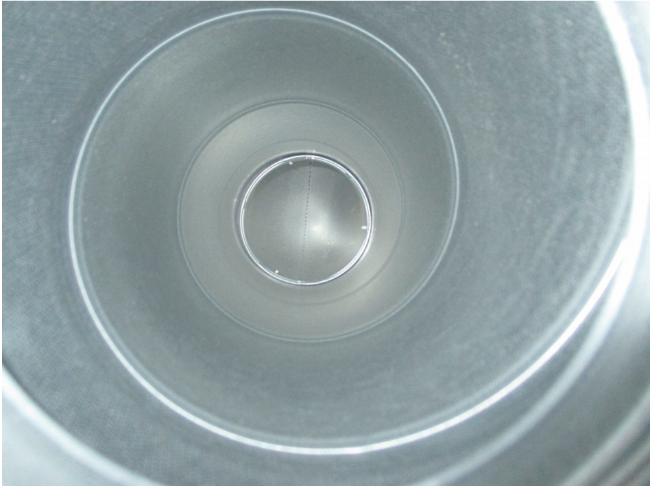
Tuloilmakanavaa (vanha puoli) ennen puhdistusta
