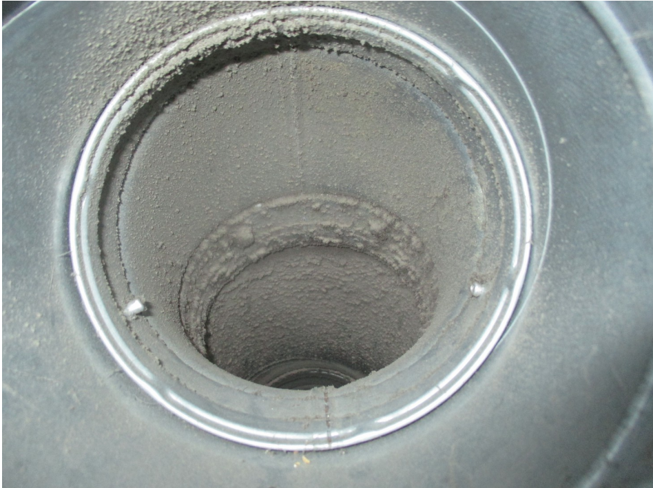
Poistoilmakanavaa (vanha puoli) ennen puhdistusta
