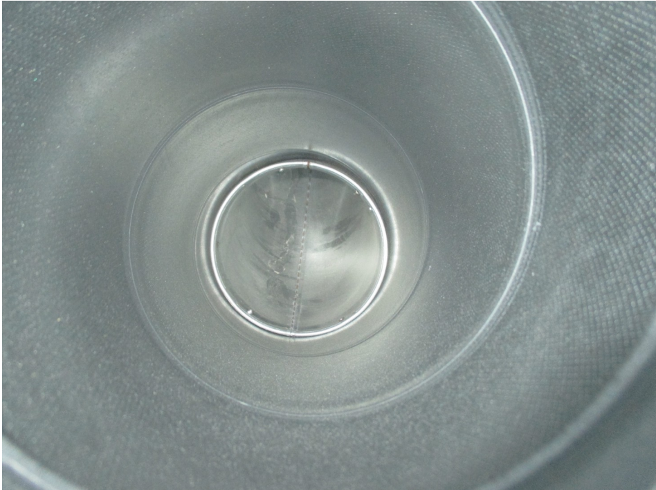
Tuloilmakanavaa (vanha puoli) ennen puhdistusta
