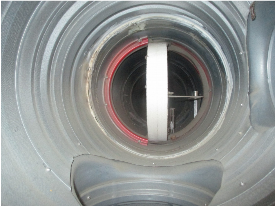
Poistoilmakanavaa (tyhjä rakennus) ennen puhdistusta
