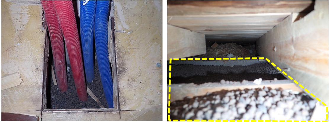
Kuvat 10 a ja b. Rakenneavaus toimiston 112 komeron välipohjaan. Komeron kohdalla sekä komerosta katsottuna toisessa palkkivälissä on välipohjan täyttökerroksena kevytsoraa (keltainen katkoviiva) ja kolmannessa välissä on vanha kutterinlastutäyttö.
