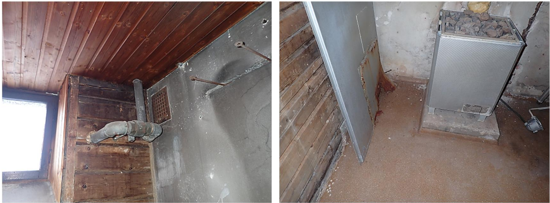
Kuvat 11 a ja b. Toimistotilan 112 komeron alapuolella on vanha saunatila. Saunatilan pinnoilla ei havaittu kosteusjälkiä tai muuta mahdolliseen vesivuotoon liittyvää. Yläpuolisen komeron vesijohdot eivät jatku kellarikerrokseen vaan jäävät todennäköisesti yläpuolisen lattiarakenteen sisään.
