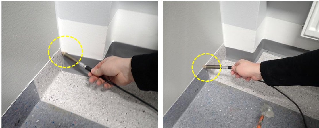
Kuva 24 a...d. Merkkiainekokeessa MA2 US todettiin pistemäisiä/vähäisiä ilmavuotoja pilarin nurkkakohdassa sekä väliseinän ja alapohjan liittymässä (maton saumassa) laitteen herkkyydellä 5 (pieni herkkyys).
