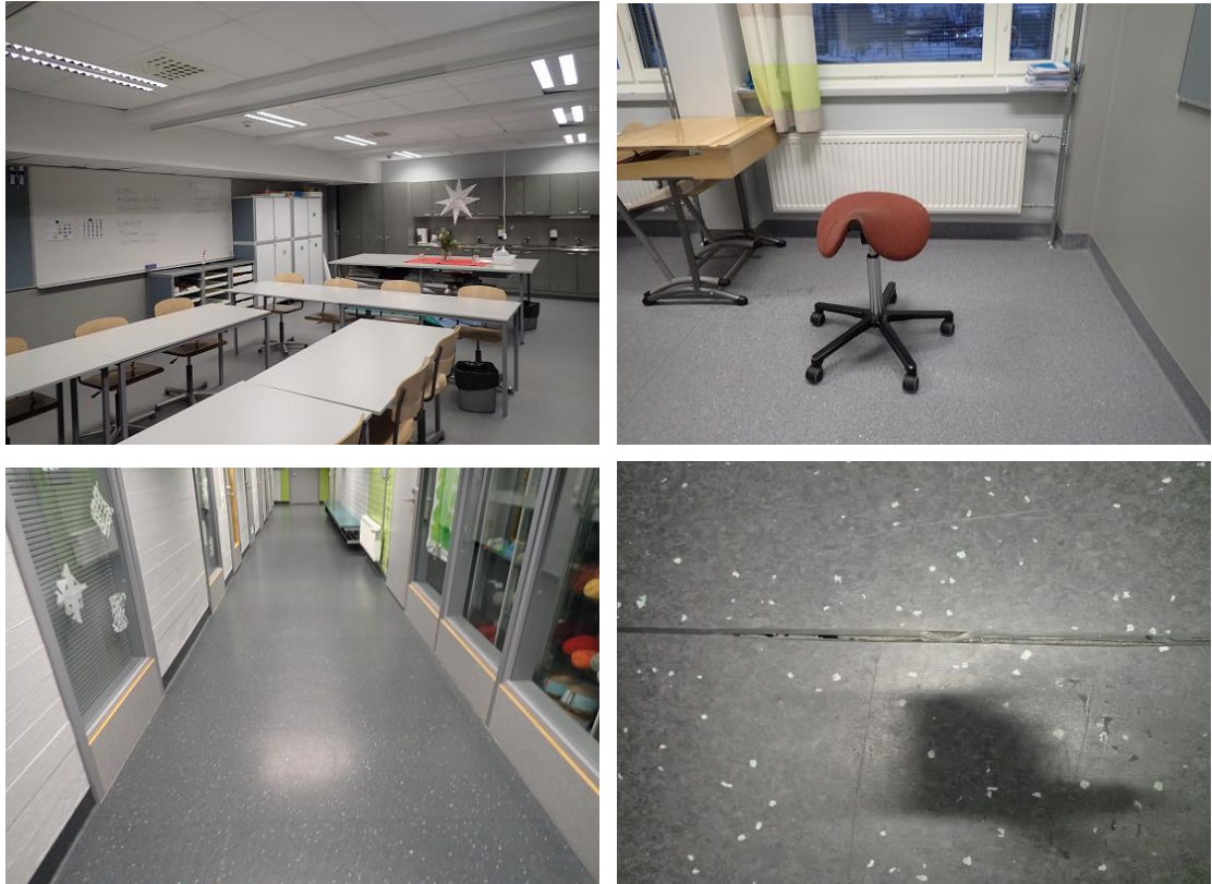
Kuva 4 a...d. Yleiskuvia erityisopetussiiven tiloista. Tilat olivat siistit eikä niissä havaittu aistinvaraisesti merkittäviä puutteita. Käytävien muovimatoista on paikoin auennut saumojen (kuva d).
