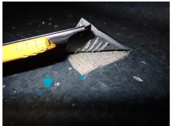
Kuva 14. V2, 75,2 % RH. Ei poikkeavaa hajua, maton tartunta kohtalainen. Kiinnitysliimassa ei poikkeavuuksia.
