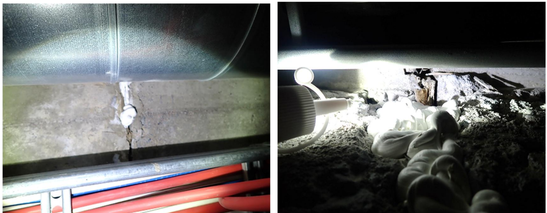
Kuva 11 a...b. Käytävän 123 alakaton yläpuolisessa tilassa välipohjan (katon) liikuntasaumaa on tiivistetty liimamassalla. Saumaa ei ole tiivistetty kauttaaltaan ja paikoin liikuntasauman eriste (puulevy tai vastaava) on näkyvissä. Merkkisavulla havaittiin ilmavirtaus alakattotilasta liikuntasaumaan päin.
