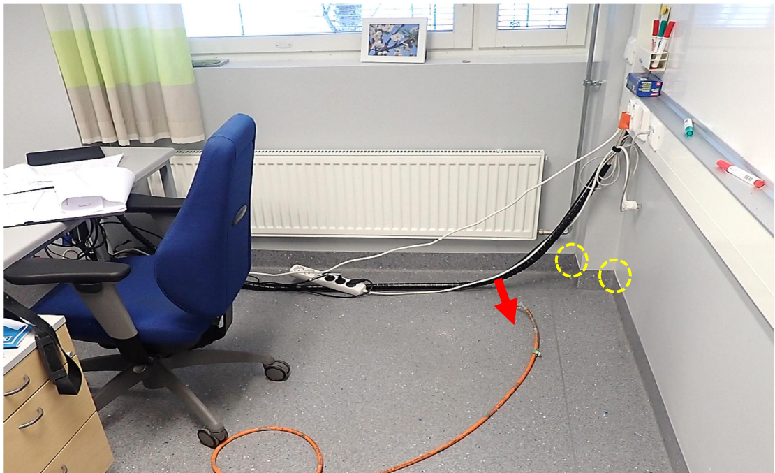
Kuva 17. Yleiskuva merkkiainekokeen MA1 AP suorituspaikasta huoneessa 146 erityisopetus. Merkkiainekaasua laskettiin ryömintätalaisen alapohjan askeläänikerrokseen. Kaasun syöttöreikä on merkittyä punaisella nuolella. Merkkiainekokeessa todettiin pistemäisiä ilmapuotoja pilarin nurkkakohdissa laitteen herkkyydellä 5 (pieni herkkyys).
