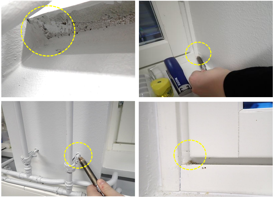
Kuva 22 a...d. Merkkiainekokeessa MA3 US todettiin pistemäisiä ilmavuotoja ikkunoiden sormiliitoksissa, patteriputken kannakkeessa ja ikkunapenkin nurkissa laitteen herkkyydellä 5 (pieni herkkyys).
