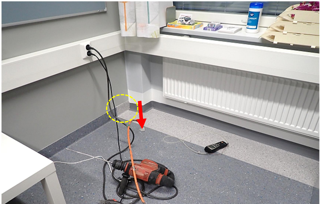
Kuva 23. Yleiskuva merkkiainekokeen MA4 AP suorituspaikasta huoneessa 107 psykologi. Merkkiainekaasua laskettiin maanvastaisen alapohjan alustäyttöön. Kaasun syöttöreikä on merkittyä punaisella nuolella. Merkkiainekokeessa todettiin vähäisiä/pistemäisiä ilmavuotoa laitteen herkkyydellä 5 (pieni herkkyys).
