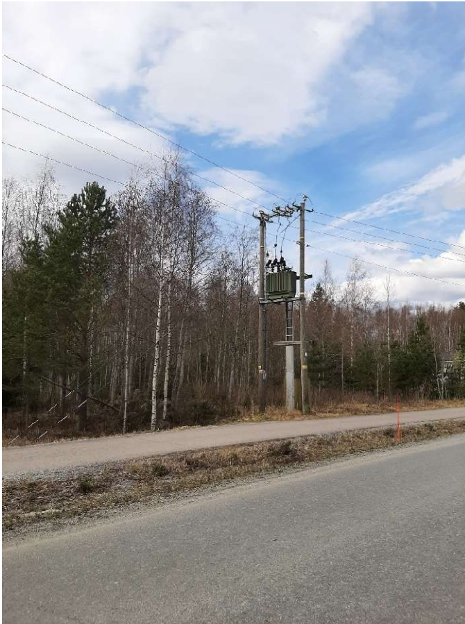
Kuva 9-5. Pylväsmuuntaja Yrittäjätien varrella.
