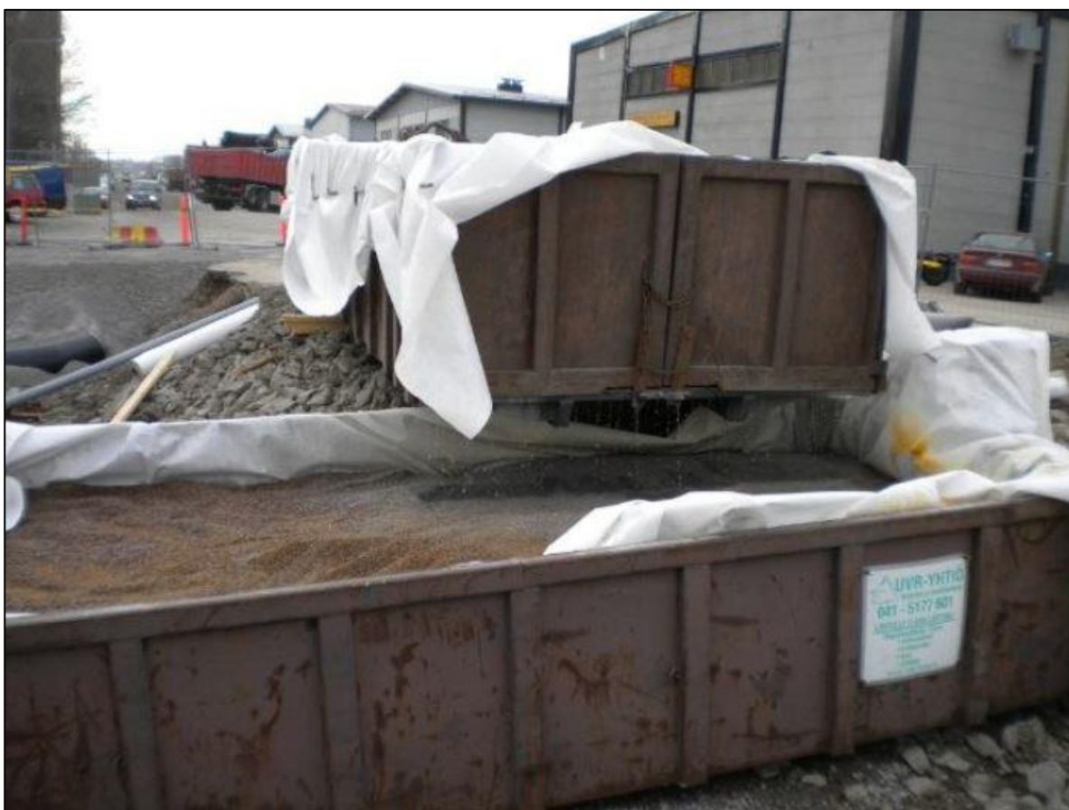
Kuva 9. Esimerkkikuva vaihtolavan sisään rakennetusta suodattimesta. 2
